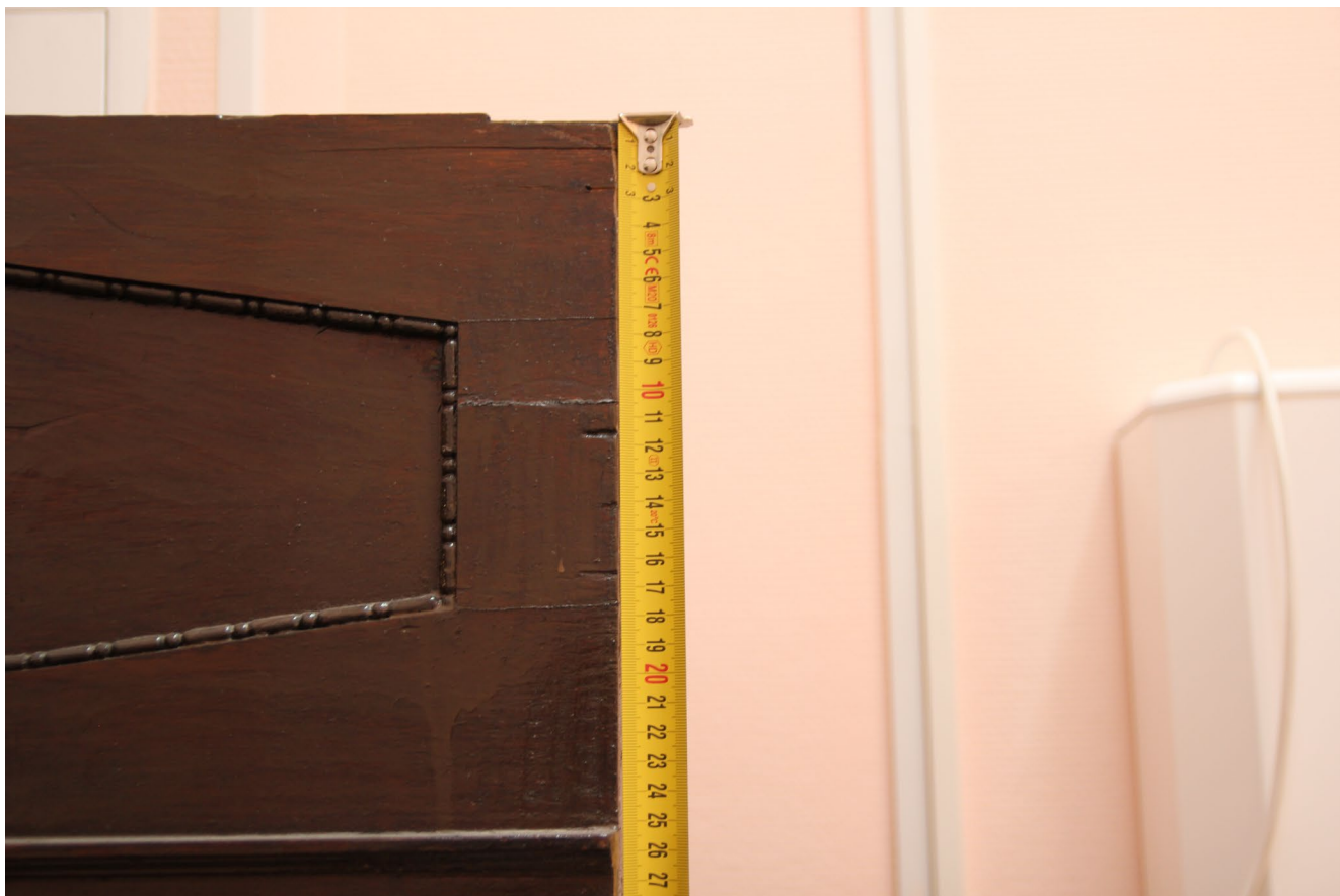
Фото 31. Фрагмент дверного заполнения ДВ-3. Декор в виде филенки с бусами.
