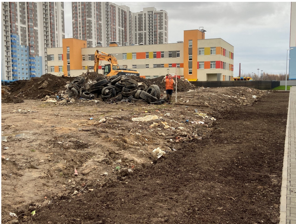
Рис. 25. СПб, Муниципальный округ Гагаринское, Витебский проспект, участок 6 (кадастровый номер: 78:14:0769203:6753). Photo 5. Общий вид территории обследования. Вид с севера
