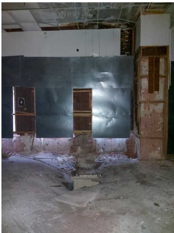
Фото 44. Помещение 14, разрушение перекрытия.
