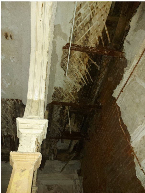
Фото 38. Разрушение перекрытия в парадной лестнице.
