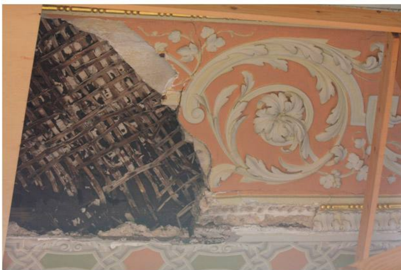
Фото 17. Объект культурного наследия федерального значения "Центральное училище технического рисования и музей Штиглица А.Л" по адресу: Санкт-Петербург, Соляной пер., д. 13-15, лит. А. Помещения 288-Н (Зал Людовика XIV)
