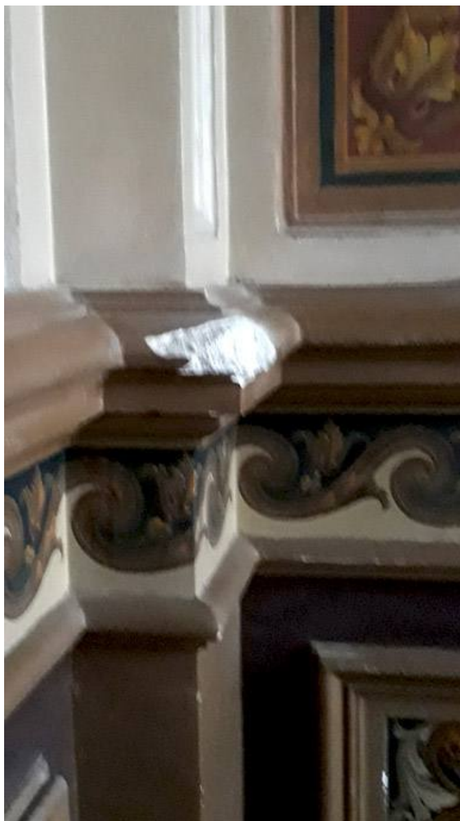
Фото 23. Объект культурного наследия федерального значения "Центральное училище технического рисования и музей Штиглица А.Л" по адресу: Санкт-Петербург, Соляной пер., д. 13-15, лит. А. Помещения 288-Н (Зал Людовика XIV)
