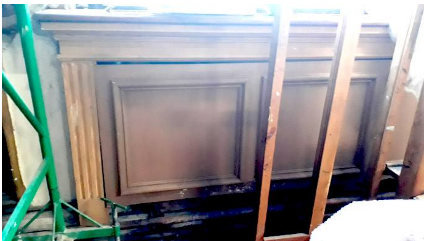
Фото 26. Объект культурного наследия федерального значения "Центральное училище технического рисования и музей Штиглица А.Л" по адресу: Санкт-Петербург, Соляной пер., д. 13-15, лит. А. Помещения 288-Н (Зал Людовика XIV)
