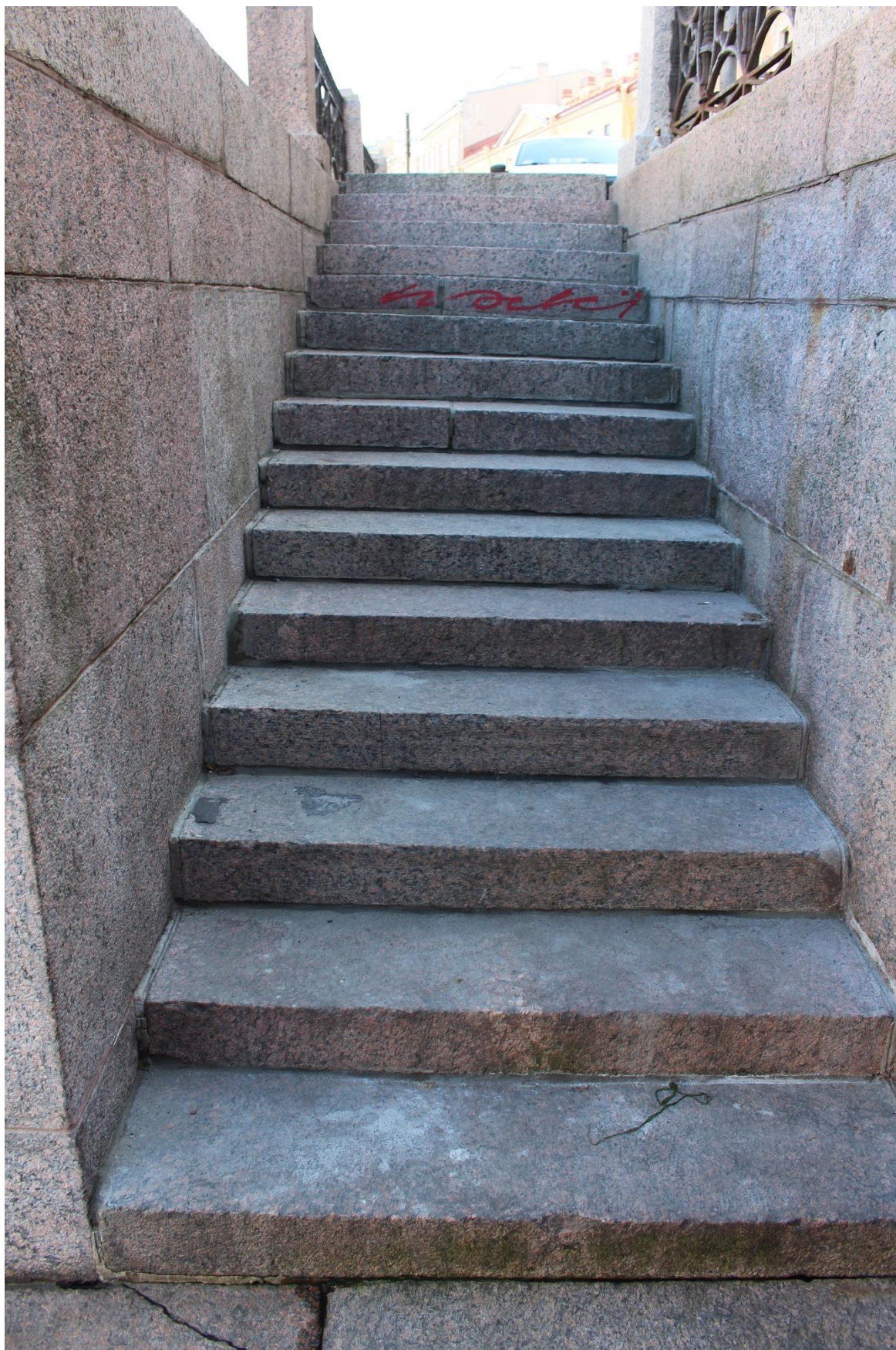
Фото 6. Вид на лестницу спуска № 15 объекта культурного наследия федерального значения «Набережные со спусками» на уч. наб. р. Мойки «Синий мост – Фонарный мост», литера Б.
