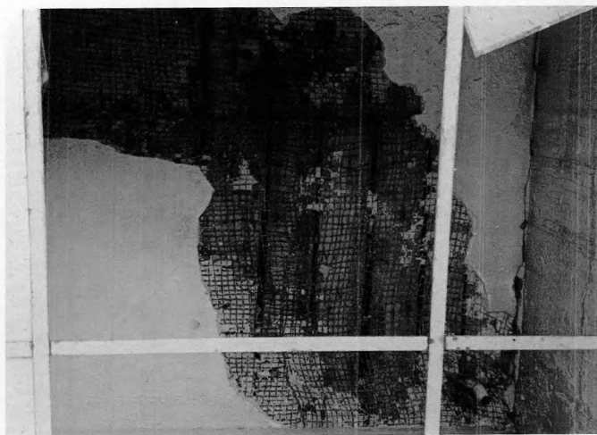
57. Повреждение отделочных слоев (помещение 17-Н ч.п. 15)
