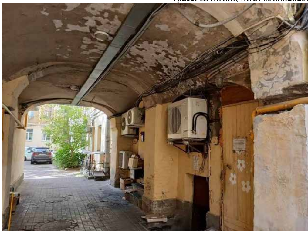
44. «Дом, где в 1865-1928 гг. жил композитор Глазунов А.К.» (Казанская ул., д. 8-10, лит. А). Арочный проезд. Фото мест установки оборудования и прокладки кабельных трасс. Штиглиц М.С. 05.08.2025.
