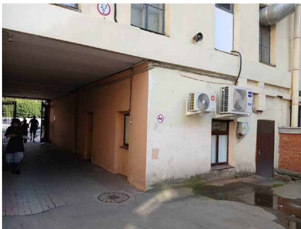
20. «Дом общества Санкт-Петербургского частного ломбарда» (Владимирский пр., д. 17, лит. А). Дворовые фасады. Фото мест установки оборудования и прокладки кабельных трасс. Штиглиц М.С. 05.08.2025.
