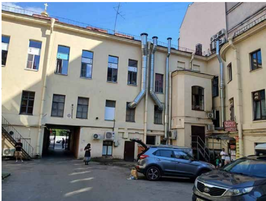
21. «Дом общества Санкт-Петербургского частного ломбарда» (Владимирский пр., д. 17, лит. А). Дворовые фасады. Фото мест установки оборудования и прокладки кабельных трасс. Штиглиц М.С. 05.08.2025.
