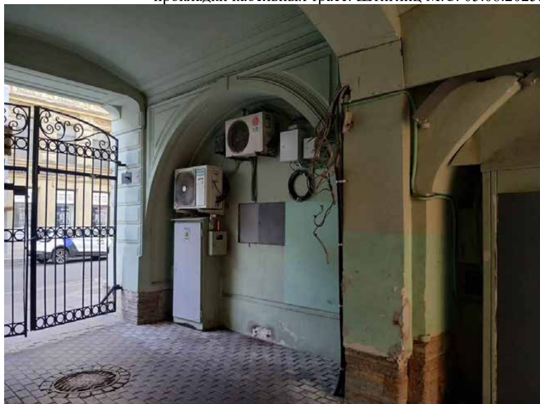
52. «Дом Меншиковых (Русско-Азиатского банка)» (Караванная ул., д. 11/64, лит. А). Арочный проезд. Фото мест установки оборудования и прокладки кабельных трасс. Штиглиц М.С. 05.08.2025.
