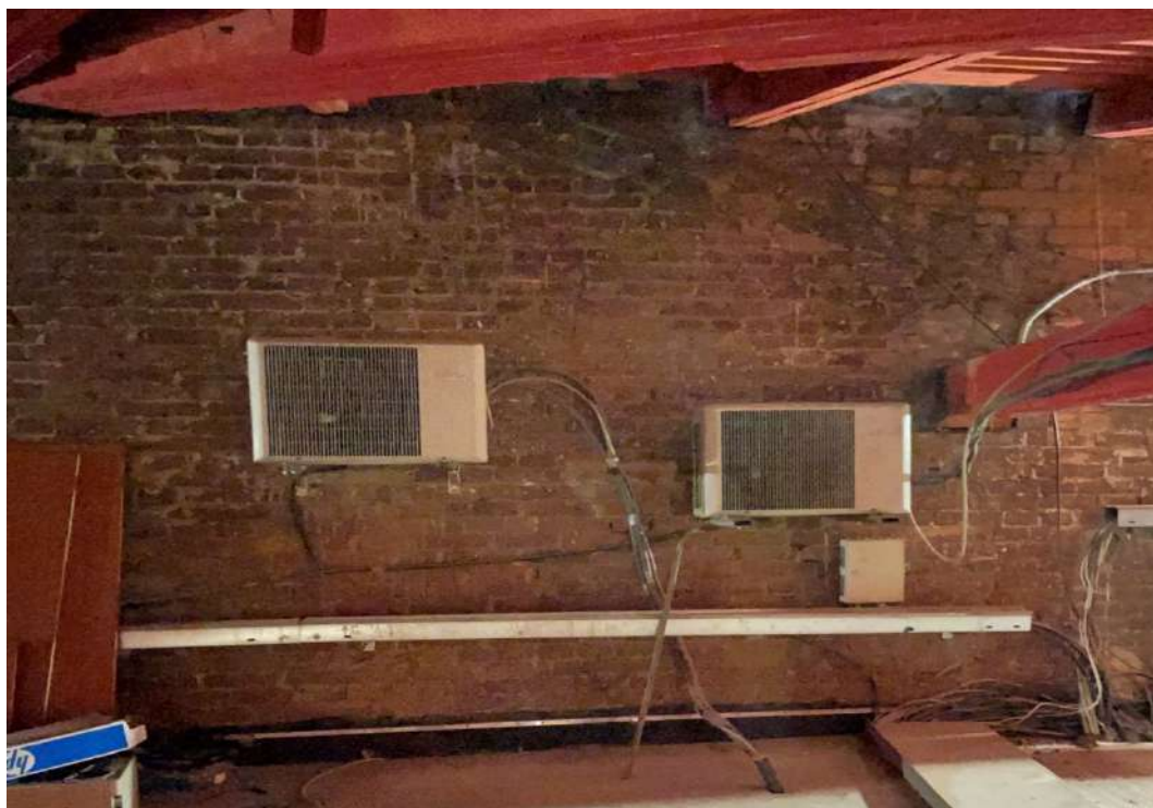
3. ОКНФЗ «Дом, где в первой половине XIXв. размещалась Российско-Американская компания. Здесь в 1820-х гг. жили декабристы Бестужев-Марлинский А.А. и Рылеев К.Ф.», расположенный по адресу: Санкт-Петербург, набережная реки Мойки, дом 72, литера А. Чердак над дворовыми флигелями (малый двор), существующие наружные блоки в осях А/13-14. Дата дополнительной съёмки: 24.03.2025.
