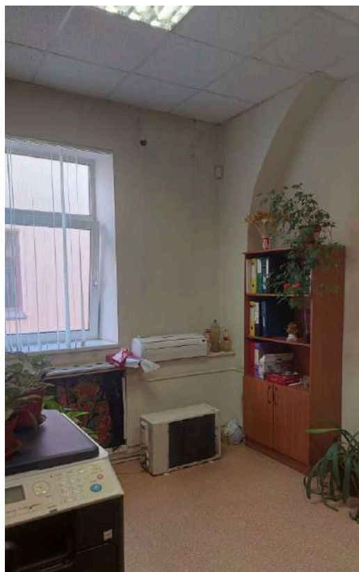
64. ОКНФЗ «Дом, где в первой половине XIXв. размещалась Российско-Американская компания. Здесь в 1820-х гг. жили декабристы Бестужев-Марлинский А.А. и Рылеев К.Ф.», расположенный по адресу: Санкт-Петербург, набережная реки Мойки, дом 72, литера А. Офисное помещение 331. Общий вид. Дата съемки: 21.02.2025г.
