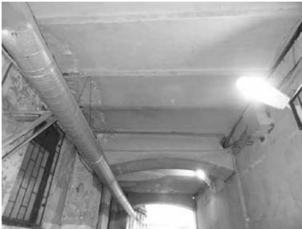
Фото 39. Прусские своды воротного проезда поперечного флигеля. Фрагмент. Дата фотофиксации: 18.03.25
