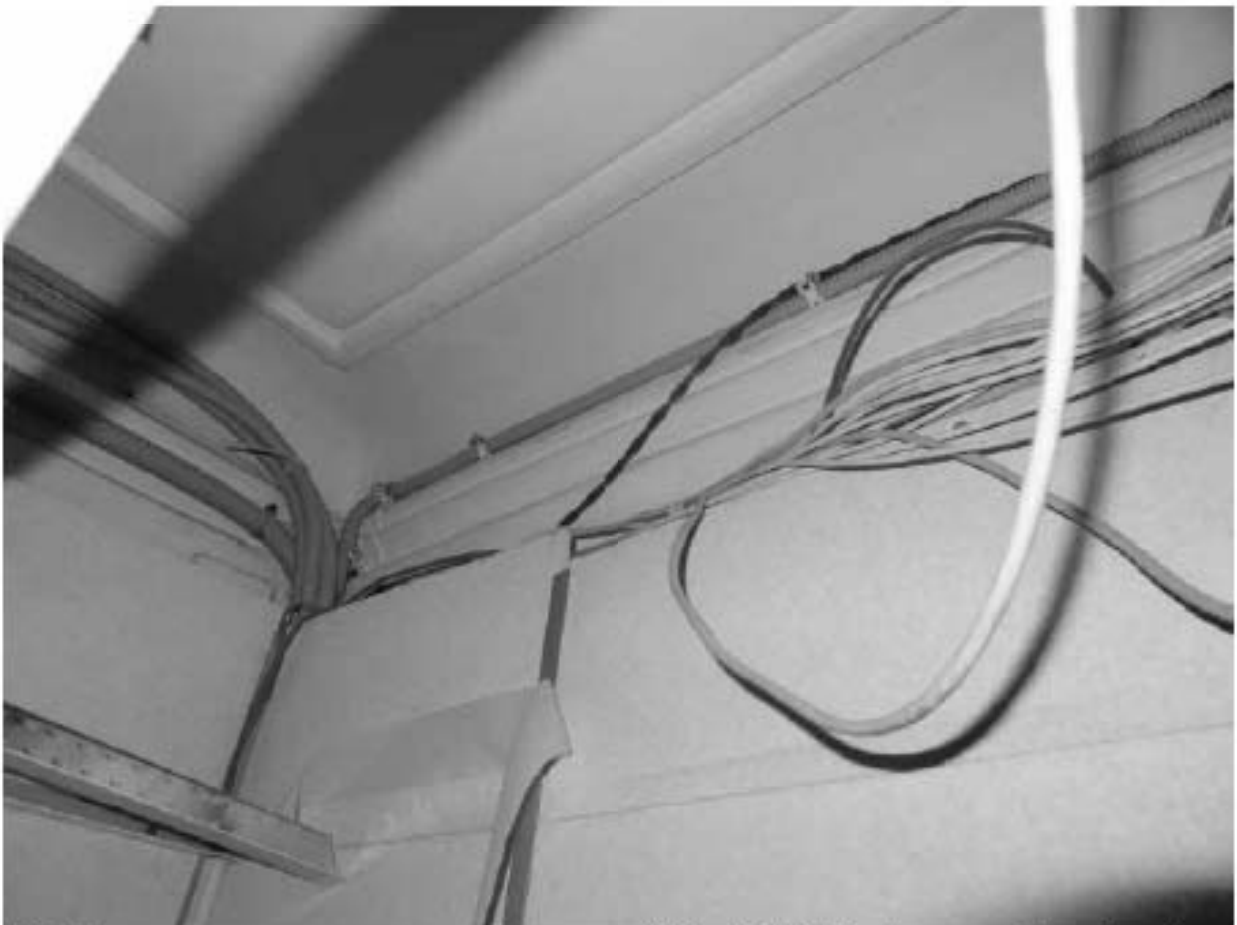
Фото 422. Падуга и тяги в пространствах помещений 16 и 18 (16-Н). Фрагмент. Дата фотофиксации: 18.03.25
