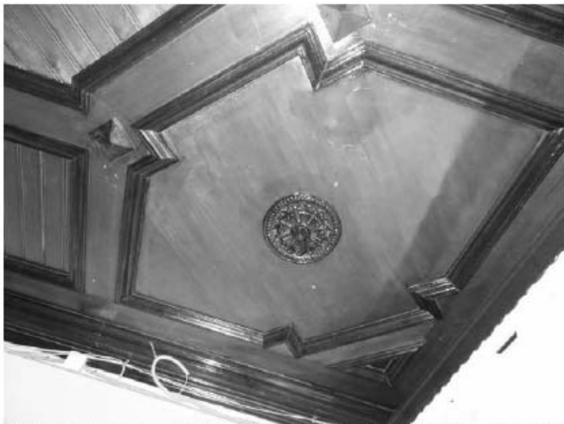
Фото 417. Угловая часть деревянной отделки в помещении 10 (16-Н). Фрагмент. Дата фотофиксации: 18.03.25
