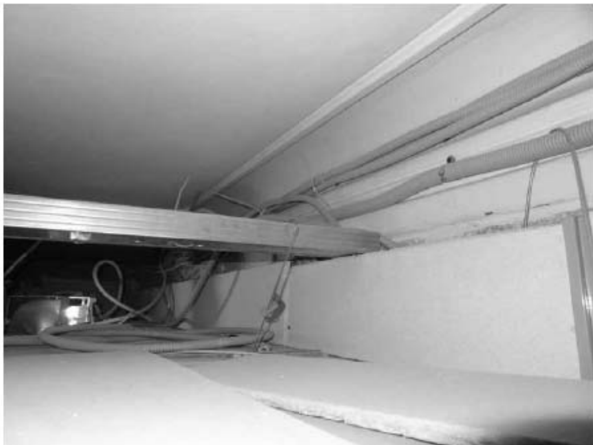
Фото 423. Падуга и тяги в пространствах помещений 16 и 18 (16-Н). Фрагмент. Дата фотофиксации: 18.03.25
