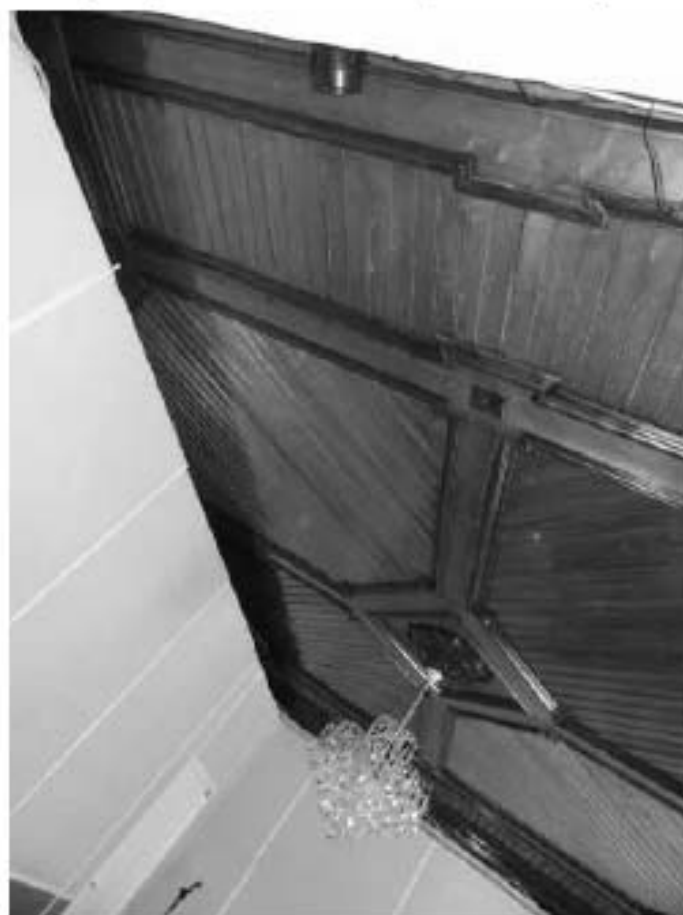
Фото 415. Деревянная отделка потолка в помещении 10 (16-Н). Фрагмент. Дата фотофиксации: 18.03.25
