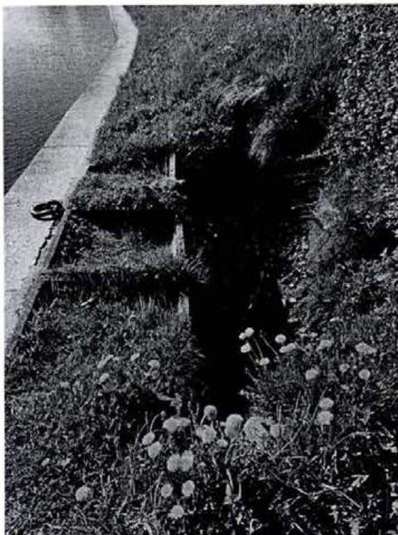
22. Дефекты дерновых откосов в северной части объекта культурного наследия.
