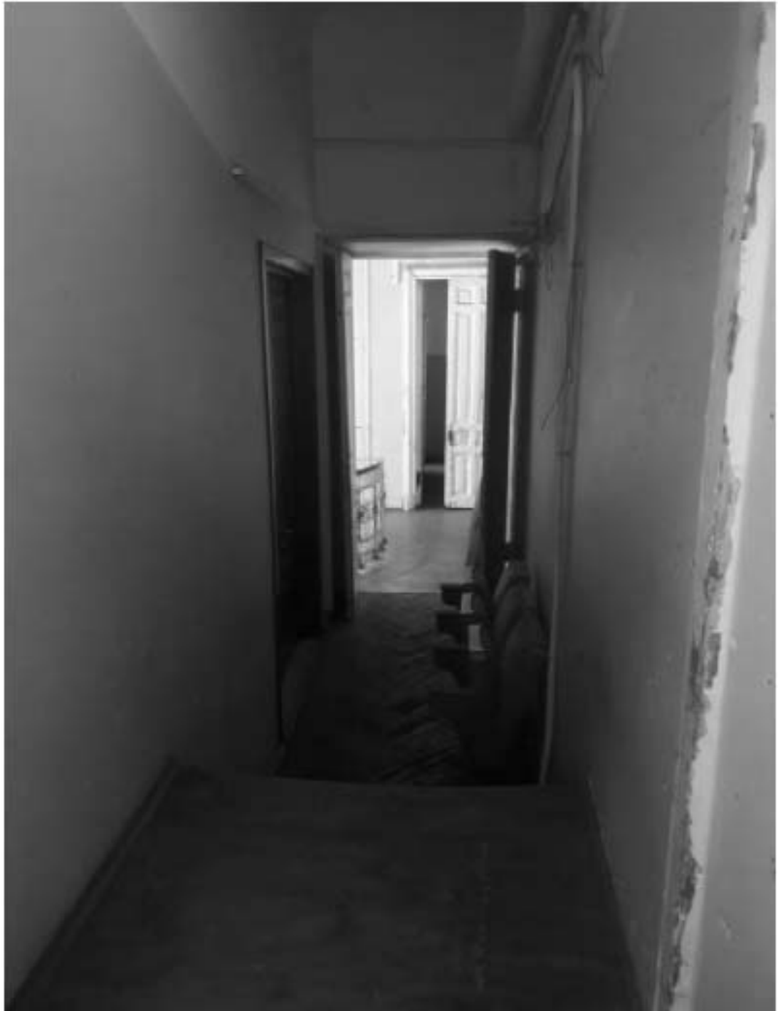
151. «Особняк Безобразовой». Санкт-Петербург, Моховая ул., 34, литера А (Моховая ул., 34). Дворовый корпус. 3-й этаж. Фрагмент помещения 21-Н(25,27). Фото: 26.10.2021.
