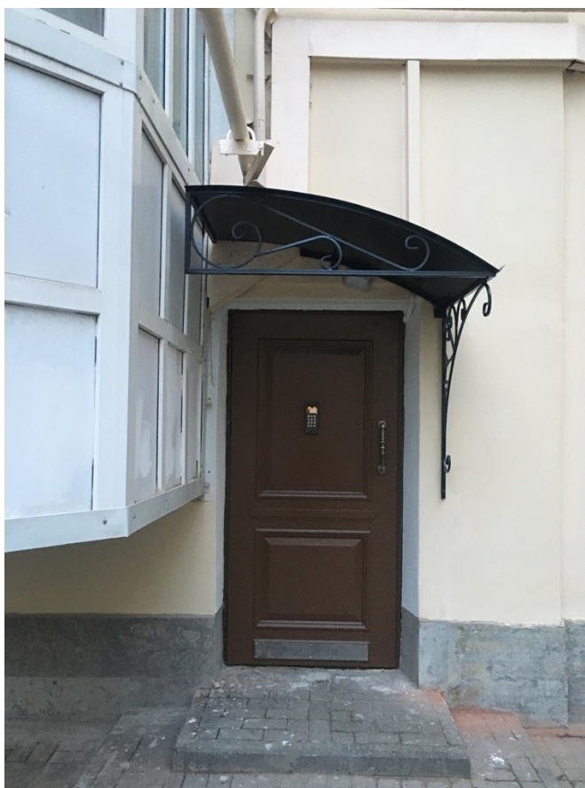
16. Выявленный объект культурного наследия «Дом С.Д. Шереметьева», г. Санкт-Петербург, пр. Литейный, дом № 51, лит. А. Вид дворового фасада.
