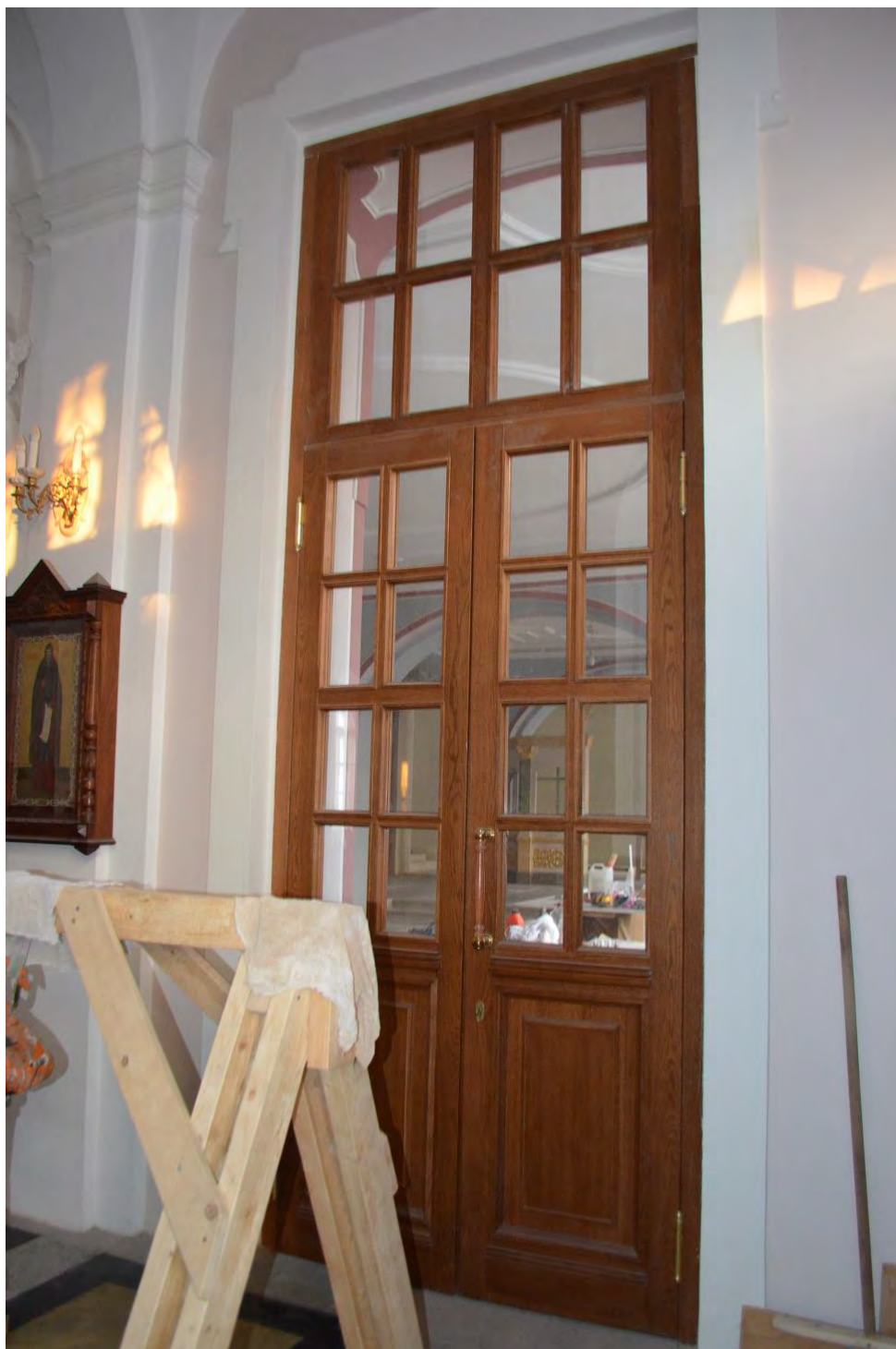
Фото 23. ОКН федерального значения «Церковь святого князя Феодора Новгородского». Помещение первого этажа. Фрагмент. Съёмка 10.11.2021 г.
