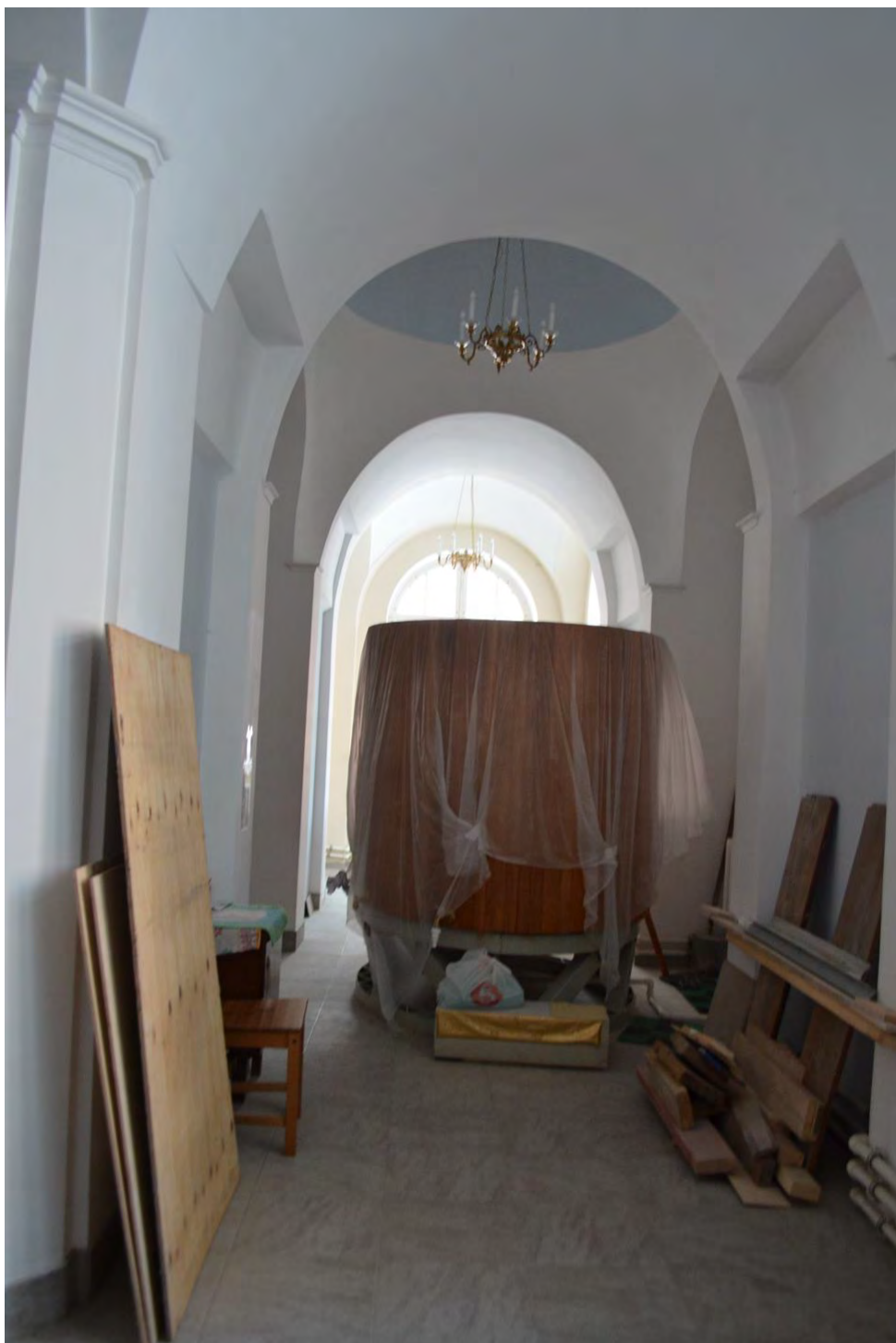
Фото 19. ОКН федерального значения «Церковь святого князя Феодора Новгородского». Помещение первого этажа. Съёмка 10.11.2021 г.
