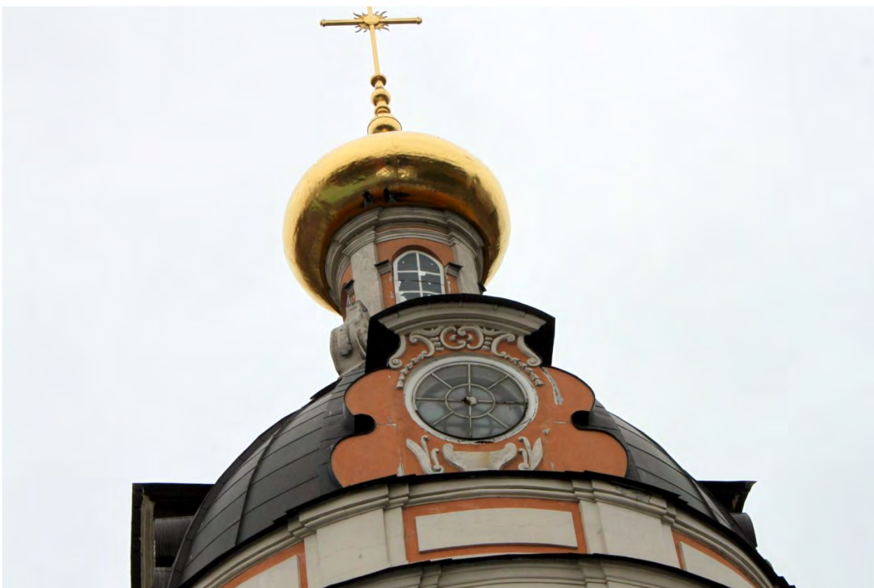
Фото 05. ОКН федерального значения «Церковь святого князя Феодора Новгородского». Северный фасад. Барабан и купол. Фрагмент. Съёмка 10.11.2021 г.
