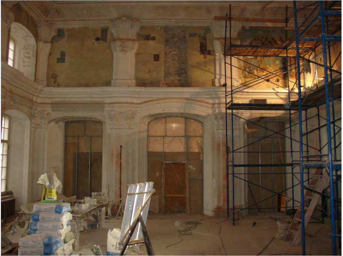
Илл. 27. Западная стена верхнего храма обций вид на карниз с капителями на этапе сдачи малярно-штукатурных работ перед возведением художественных подмостей.
