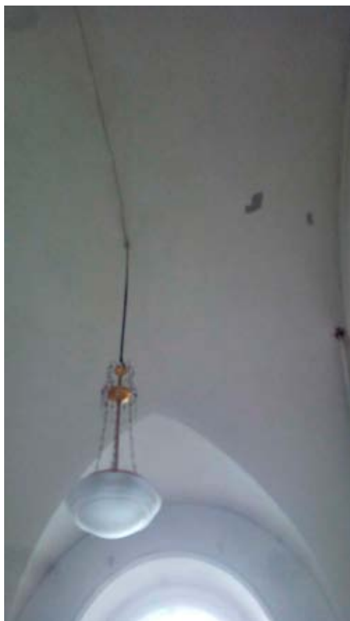
24. Помещение №3 (35Н) объекта культурного наследия федерального значения «Дом министра государственных имуществ», расположенного по адресу: г. Санкт-Петербург, Большая Морская ул., д. 44, литера А. 26.10.2021
