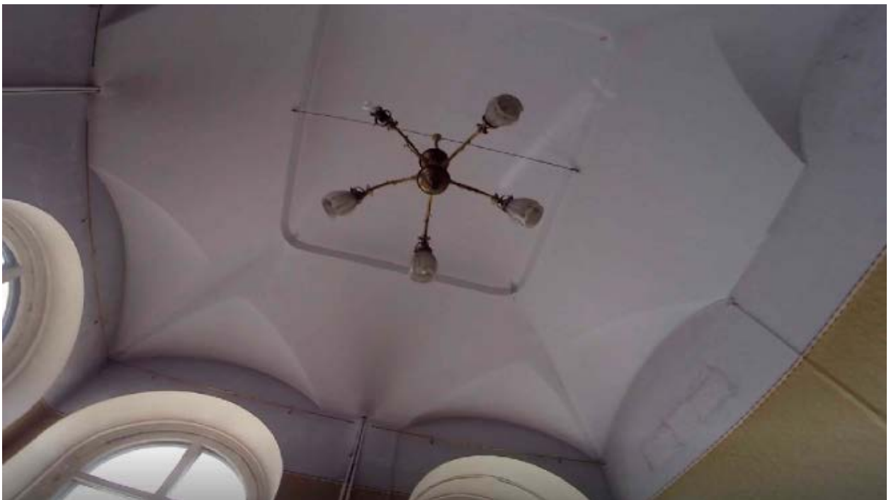
9. Помещение №15 (5Н) объекта культурного наследия федерального значения «Дом министра государственных имуществ», расположенного по адресу: г. Санкт-Петербург, Большая Морская ул., д. 44, литера А. 26.10.2021
