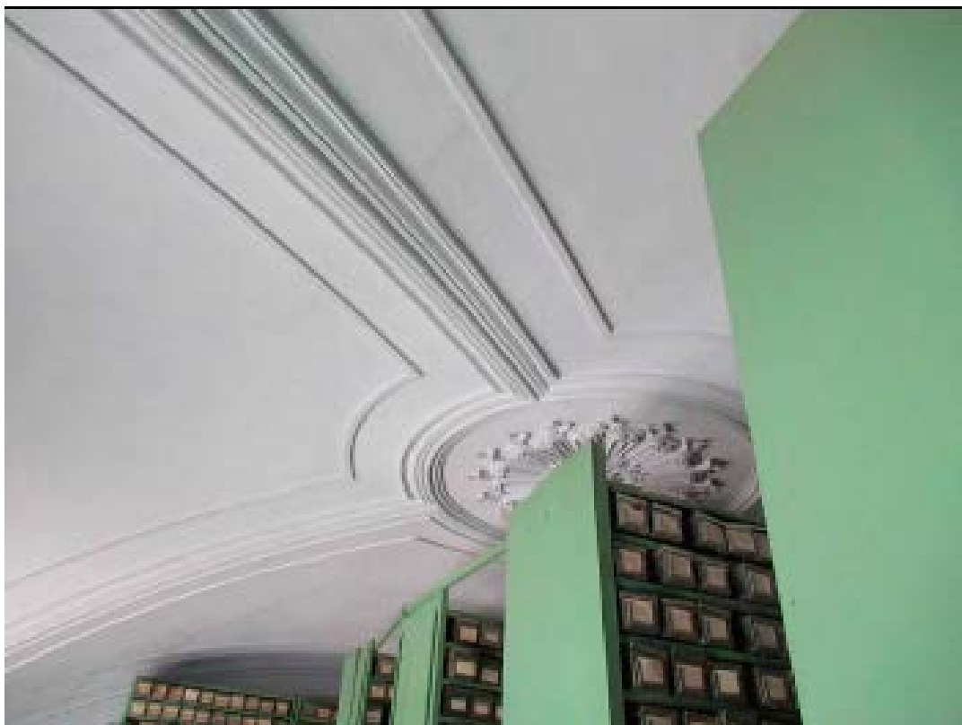
6. Помещение №10 (5Н) объекта культурного наследия федерального значения «Дом министра государственных имуществ», расположенного по адресу: г. Санкт-Петербург, Большая Морская ул., д. 44, литера А. 26.10.2021
