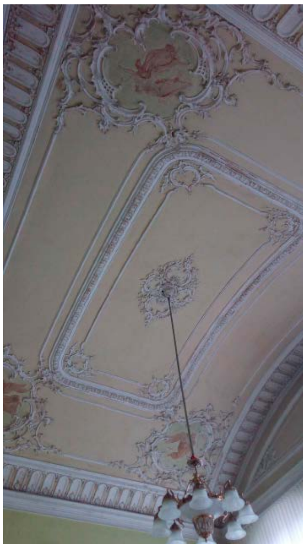
13. Помещение №6 (27Н) объекта культурного наследия федерального значения «Дом министра государственных имуществ», расположенного по адресу: г. Санкт-Петербург, Большая Морская ул., д. 44, литера А. 26.10.2021
