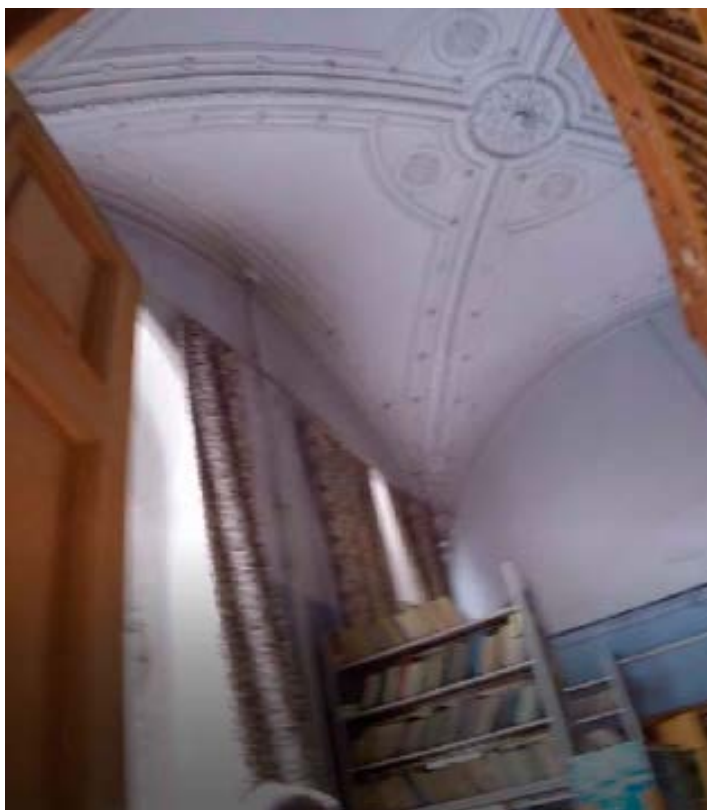
10. Помещение №14 (5Н) объекта культурного наследия федерального значения «Дом министра государственных имуществ», расположенного по адресу: г. Санкт-Петербург, Большая Морская ул., д. 44, литера А. 26.10.2021
