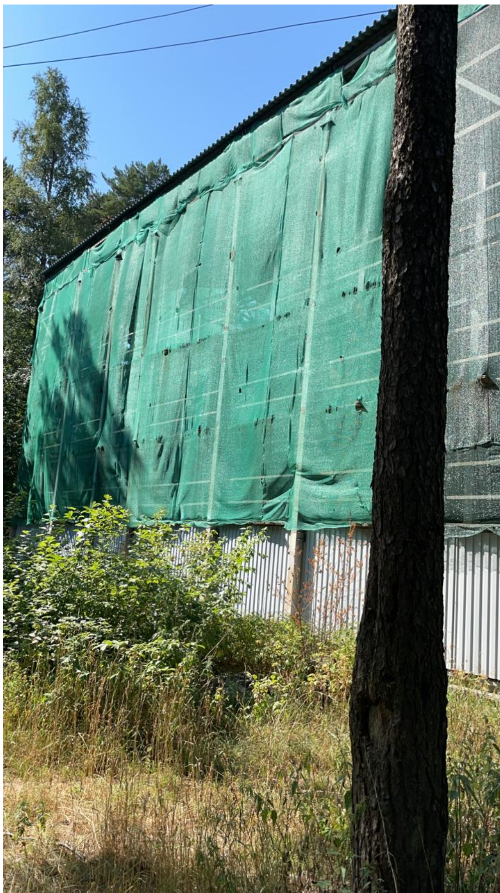
Фото 6. Вид с юго-восточного угла здания в защитном сооружении. Фасад 5-1. Фото 1.08.2021 г.
