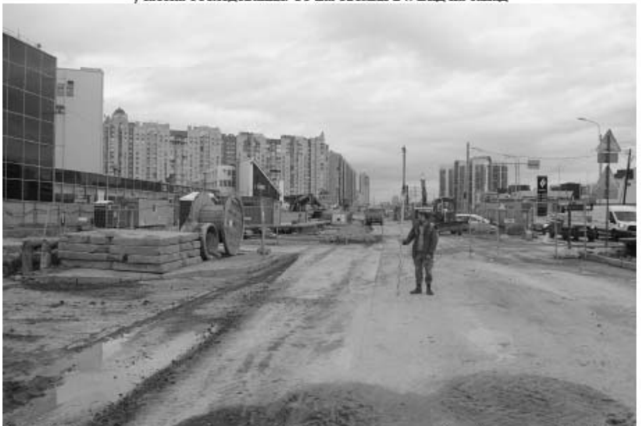
Рис. 65. Санкт-Петербург, пересечение Московского шоссе с Дунайским пр. Общий вид участка обследования. Точка съемки 24. Вид на восток
