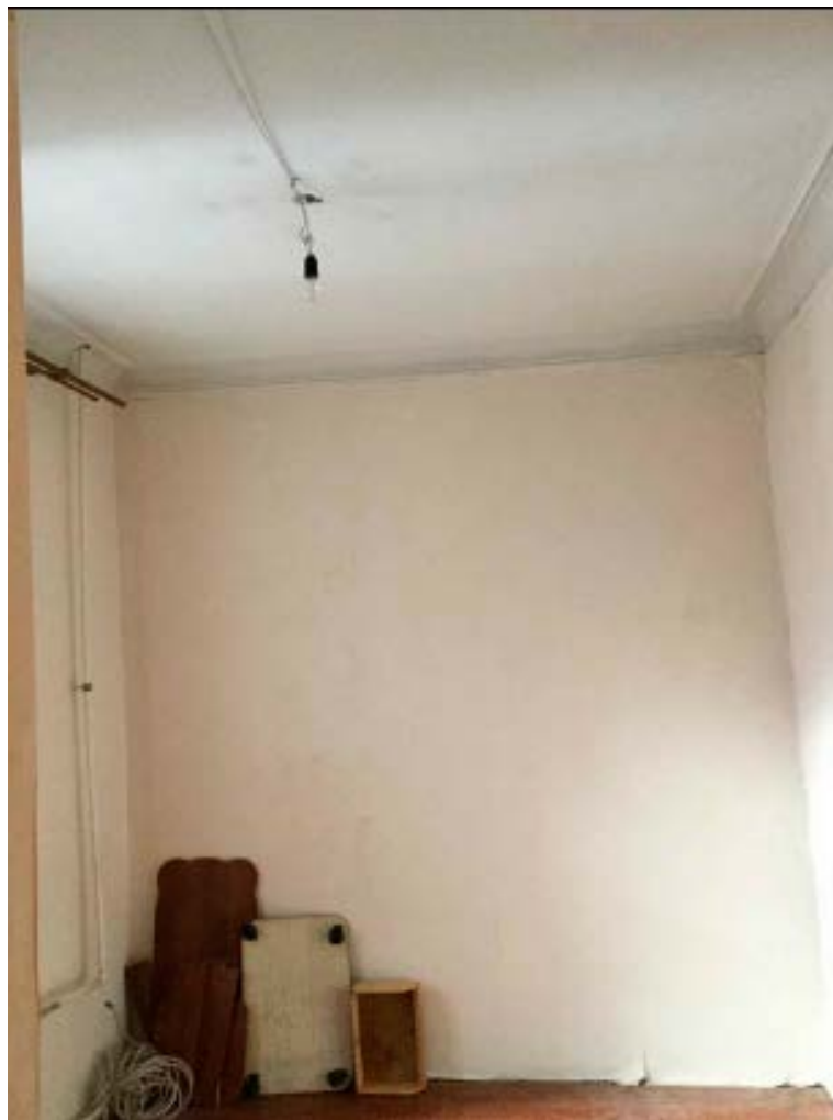
б. Помещение №7 кв. №34 в уровне 2-го этажа выявленного объекта культурного наследия «Доходный дом сельскохозяйственного товарищества «Помещик»», расположенного по адресу: г. Санкт-Петербург, Измайловский пр., д. 16/30, литера А. 15.09.2020.
