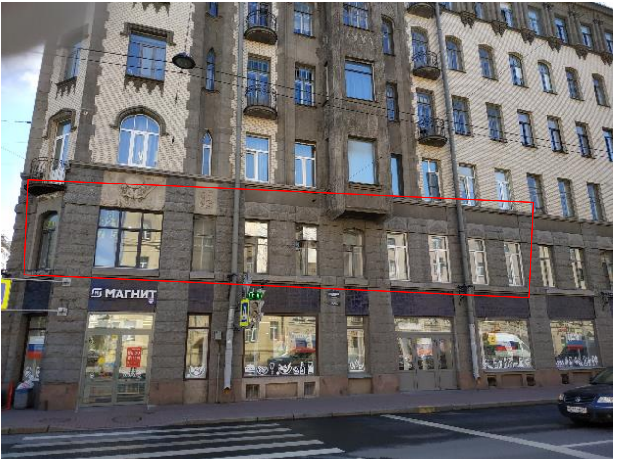
2. Оконные заполнения кв. №34 в уровне 2-го этажа выявленного объекта культурного наследия «Доходный дом сельскохозяйственного товарищества «Помещик»», расположенного по адресу: г. Санкт-Петербург, Измайловский пр., д. 16/30, литера А, по Измайловскому пр. 15.09.2020.
