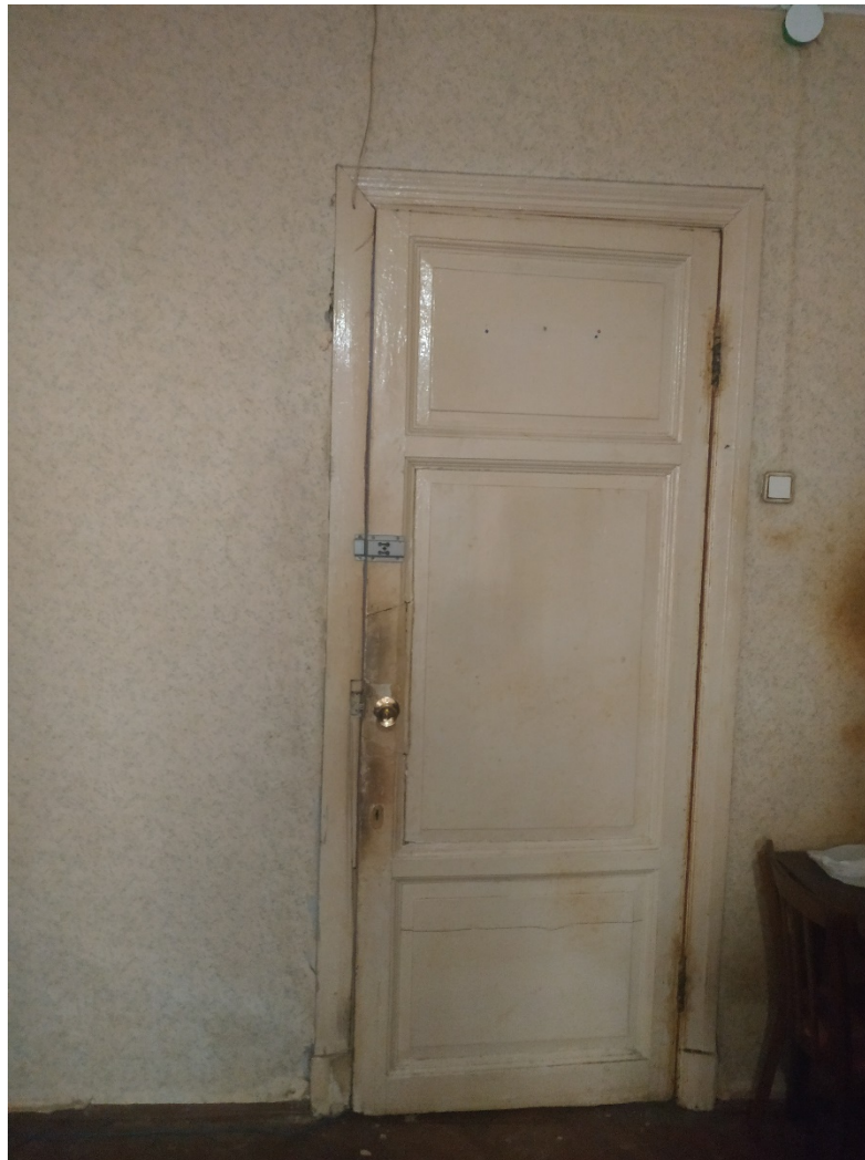
10. Помещение №14 кв. №34 в уровне 2-го этажа выявленного объекта культурного наследия «Доходный дом сельскохозяйственного товарищества «Помещик»», расположенного по адресу: г. Санкт-Петербург, Измайловский пр., д. 16/30, литера А. 15.09.2020.
