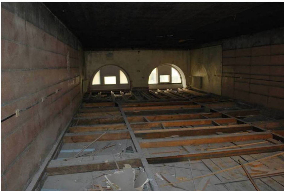
Илл. 229. Объект культурного наследия «Большой железный ряд или Кожевенная линия». Средний корпус. 2-й этаж, помещение № 70. 31.03.2019 г.
