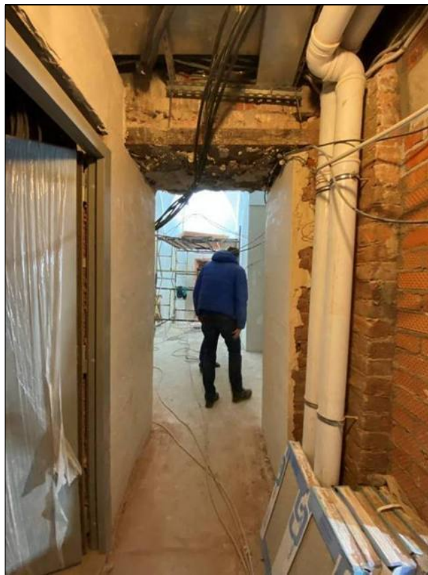
59. Объект культурного наследия «Большой железный ряд или Кожевенная линия». Средний корпус. 1-й этаж, помещение № 137. Вход в помещение № 115 северного корпуса. 24.02.2021 г.
