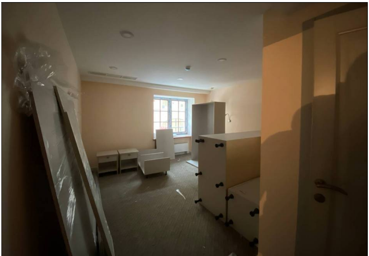
78. Объект культурного наследия «Большой железный ряд или Кожевенная линия». Средний корпус. 2-й этаж, помещение № 206/1. 24.02.2021 г.
