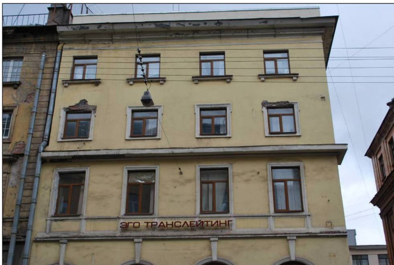
Илл. 194. Объект культурного наследия «Большой железный ряд или Кожевенная линия». Южный корпус. Фрагмент лицевого фасада по Мучному переулку. Оконные проемы 2-го, 3-го и 4-го этажей. 31.03.2019 г.
