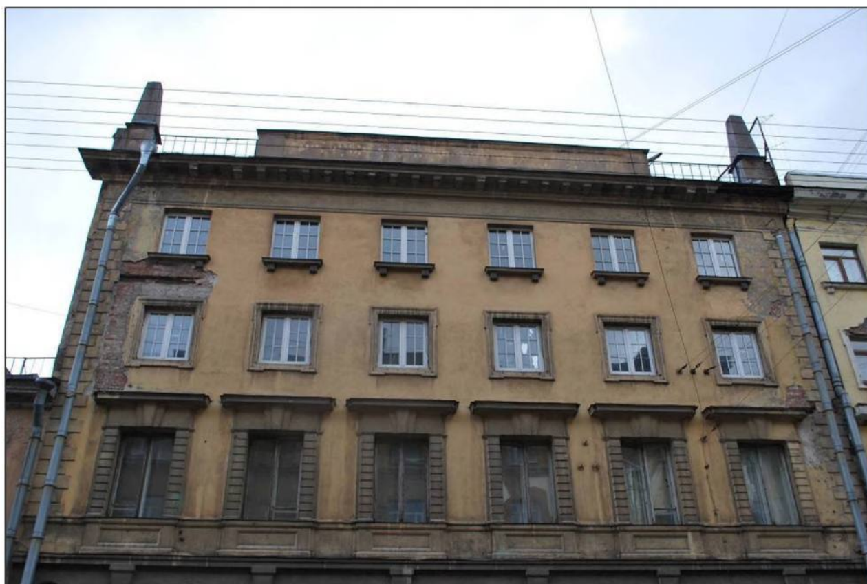
Илл. 189. Объект культурного наследия «Большой железный ряд или Кожевенная линия». Средний корпус. Фрагмент лицевого фасада по Мучному переулку. Оконные проемы 2-го и 3-го и 4-го этажей. 31.03.2019 г.
