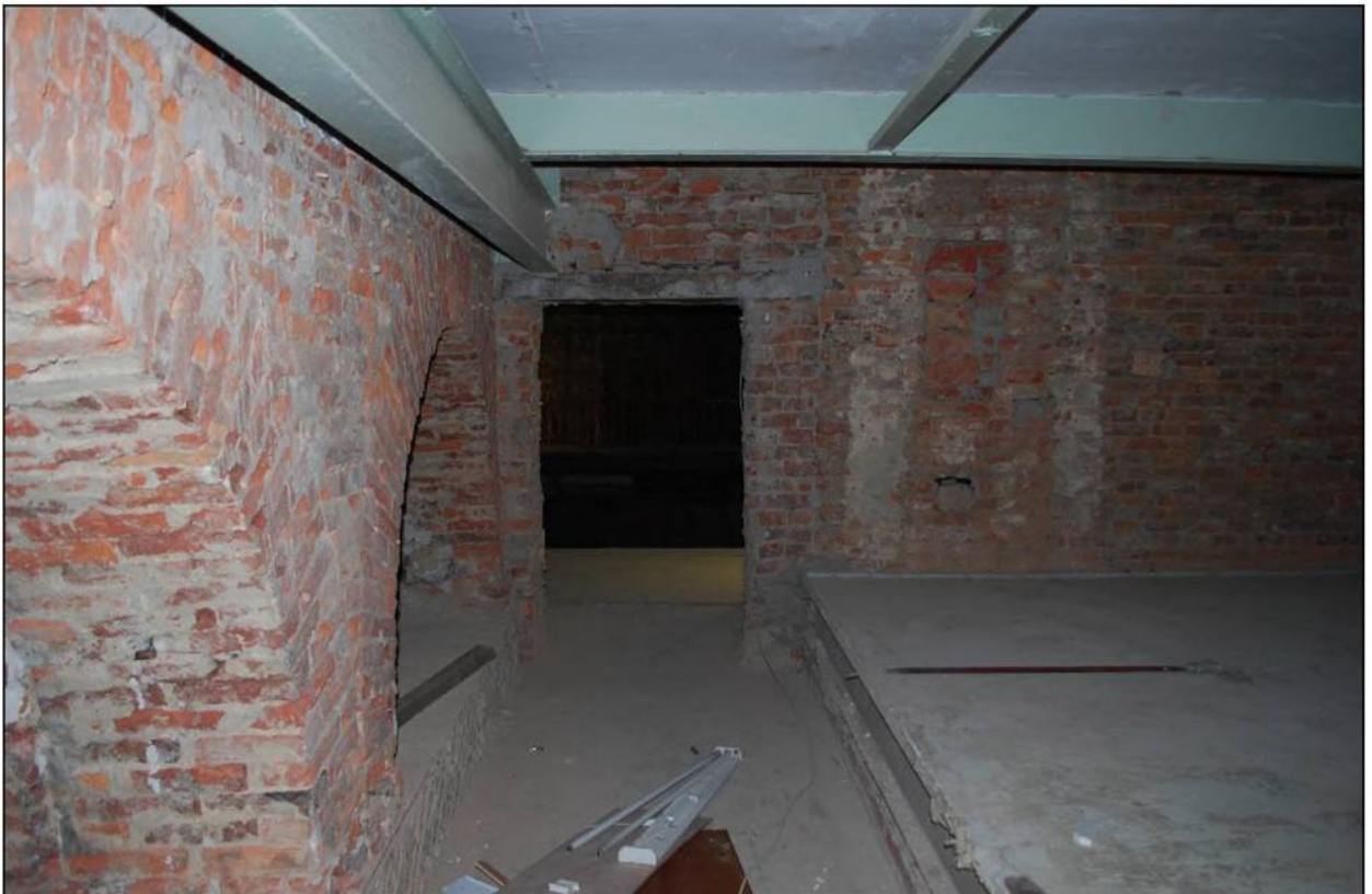
Илл. 225. Объект культурного наследия «Большой железный ряд или Кожевенная линия». Средний корпус. 2-й этаж, северо-восточная часть помещения № 68, выход на балкон. 31.03.2019 г.
