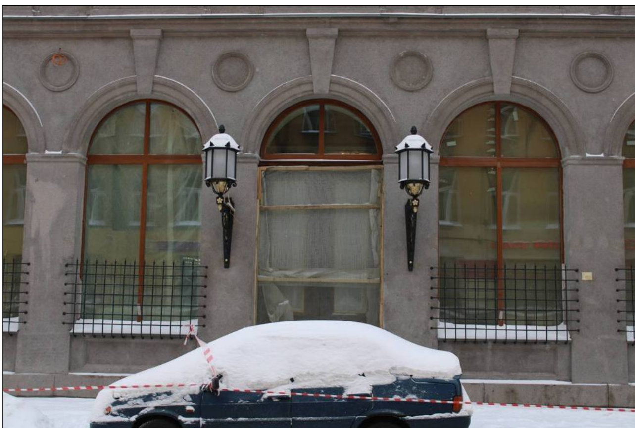
6. Объект культурного наследия «Большой железный ряд или Кожевенная линия». Средний корпус. Фрагмент лицевого фасада по Мучному переулку. Дверной проем. 24.02.2021 г.
