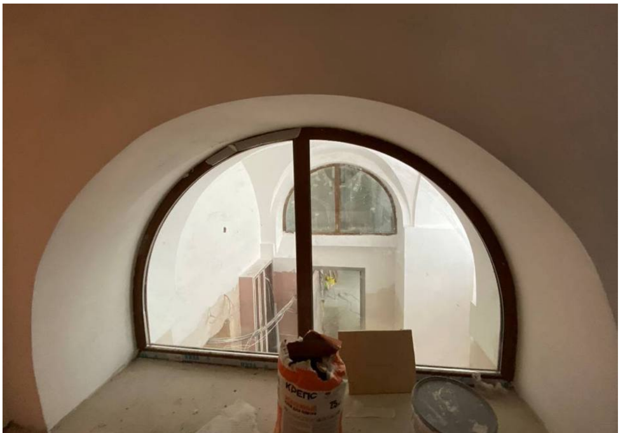
74. Объект культурного наследия «Большой железный ряд или Кожевенная линия». Северный корпус. 2-й этаж, помещение № 212. Арочный проемы 24.02.2021 г.
