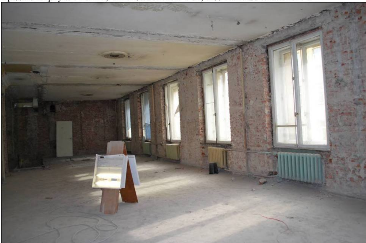
Илл. 240. Объект культурного наследия «Большой железный ряд или Кожевенная линия». Средний корпус. 3-й этаж, помещения №№ 77-92, оконные проемы. 31.03.2019 г.
