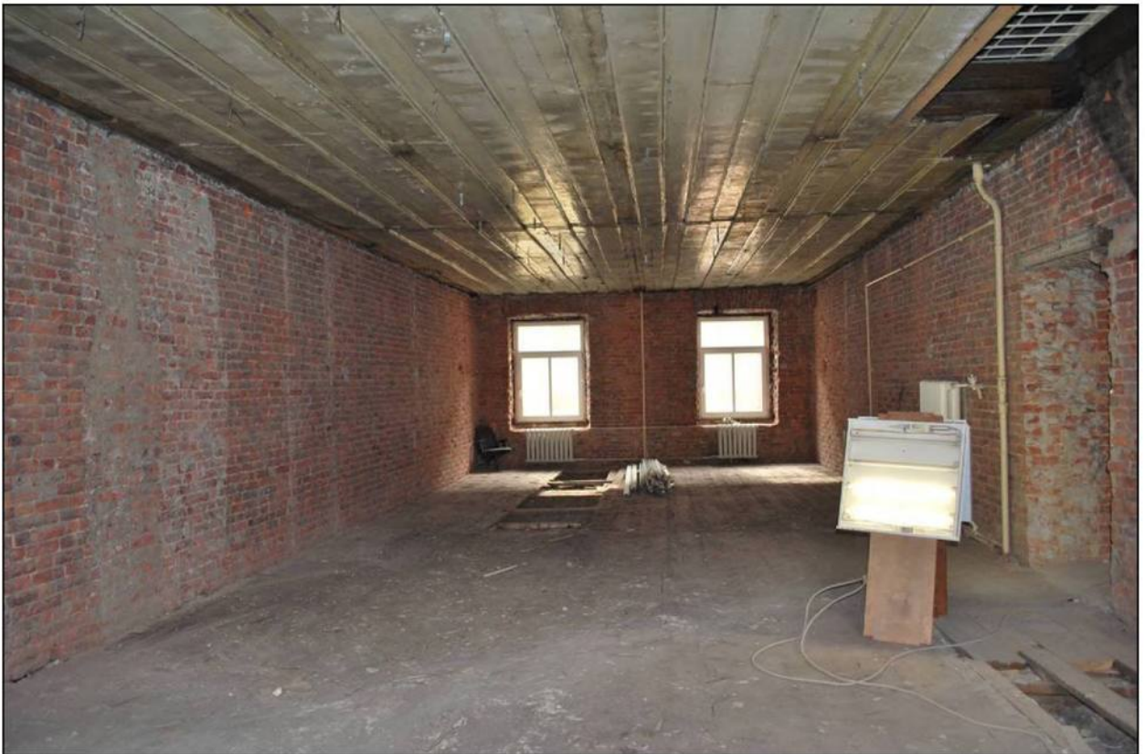
Илл. 237. Объект культурного наследия «Большой железный ряд или Кожевенная линия». Средний корпус. 3-й этаж, южная часть помещения №76. 31.03.2019 г.
