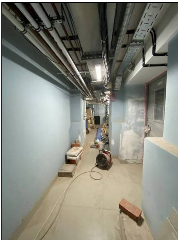
23. Объект культурного наследия «Большой железный ряд или Кожевенная линия». Северный корпус. Подвал, коридор вдоль помещений №№ 42, 26, 22, 13. Вид от помещения № 26. 24.02.2021 г.
