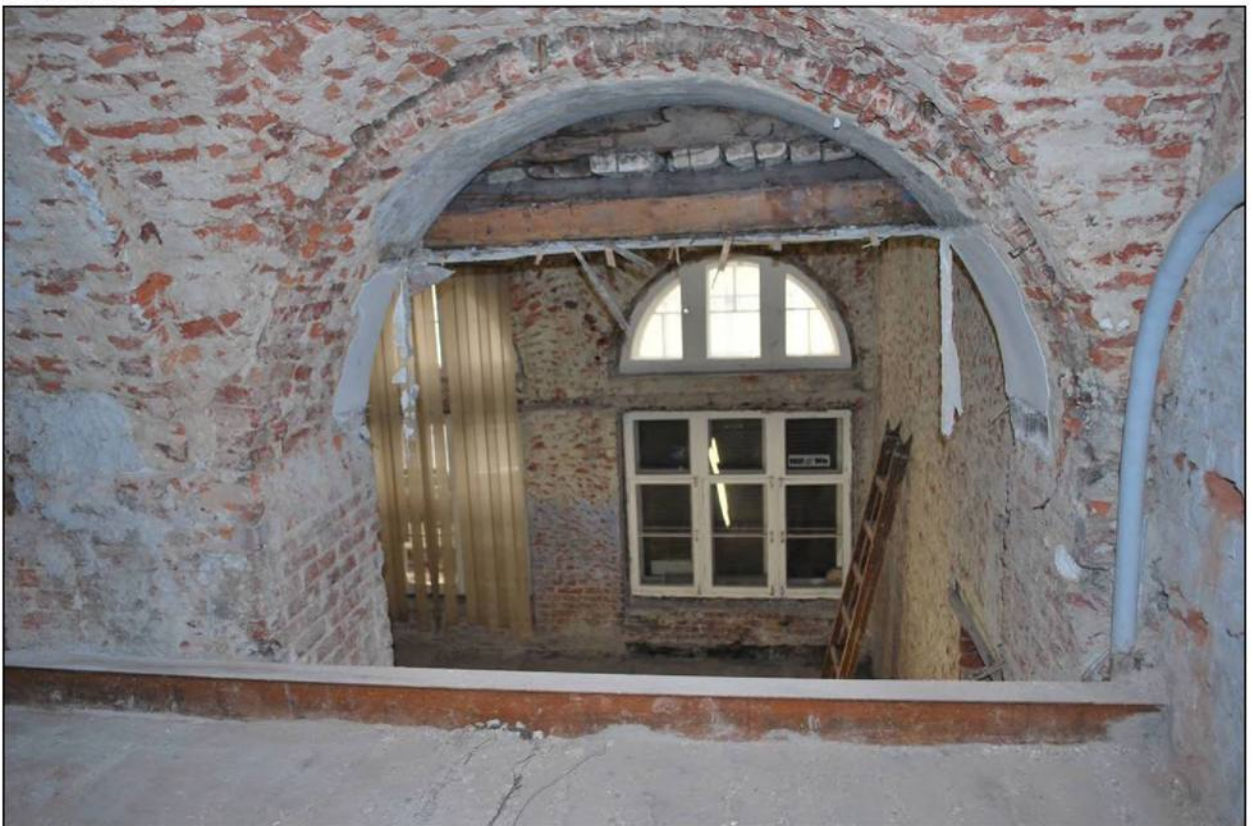
Илл. 228. Объект культурного наследия «Большой железный ряд или Кожевенная линия». Средний корпус. 2-й этаж, северная часть помещения № 68, арочный проем. 31.03.2019 г.
