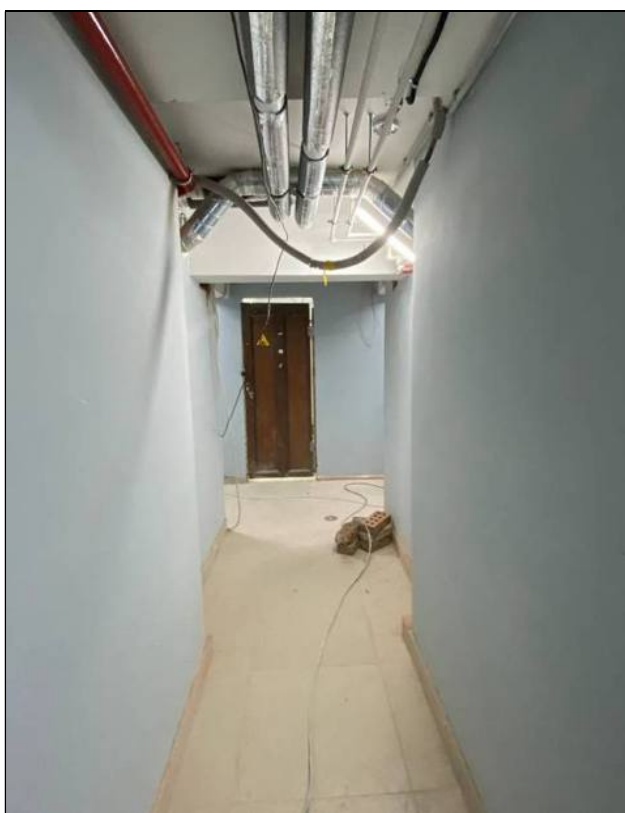
22. Объект культурного наследия «Большой железный ряд или Кожевенная линия». Средний корпус. Подвал, коридор между помещениями №№ 23, 39. Вид от помещения № 43. 24.02.2021 г.
