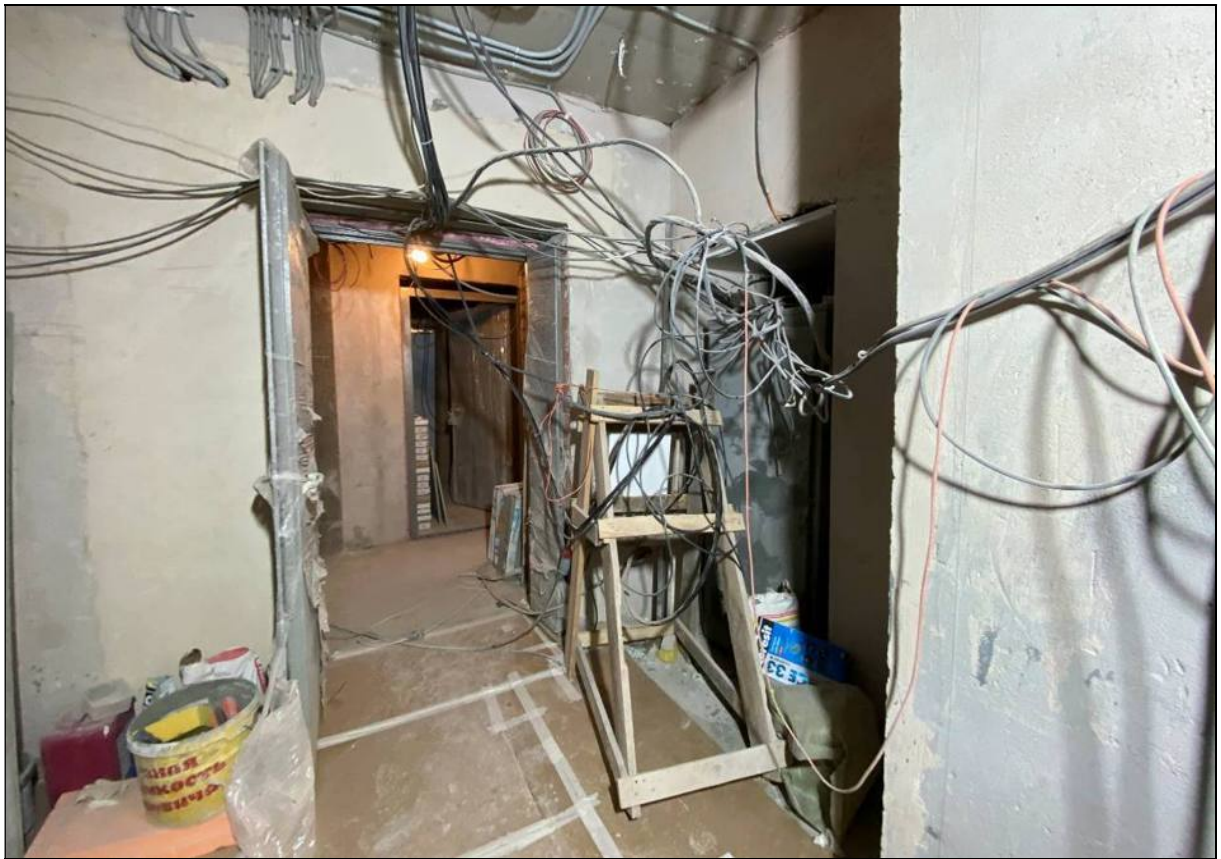
58. Объект культурного наследия «Большой железный ряд или Кожевенная линия». Средний корпус. 1-й этаж, помещение № 113. Вход в помещение №137. 24.02.2021 г.
