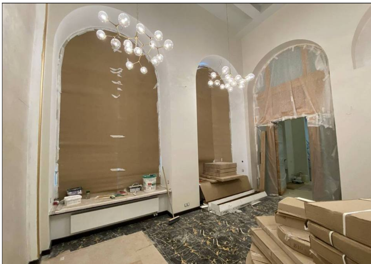
43. Объект культурного наследия «Большой железный ряд или Кожевенная линия». Средний корпус. 1-й этаж, помещение № 120. Дверной и оконные проемы. 24.02.2021 г.
