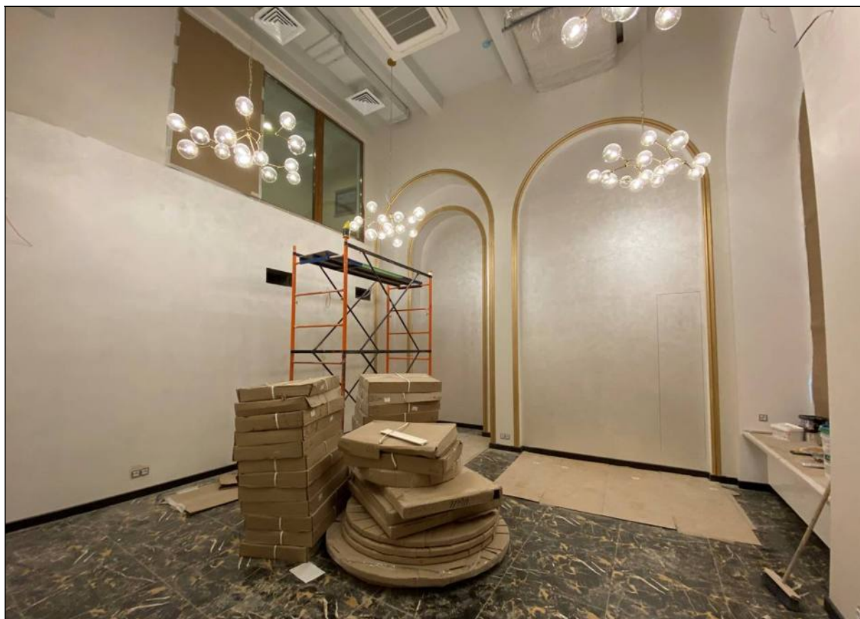
42. Объект культурного наследия «Большой железный ряд или Кожевенная линия». Средний корпус. 1-й этаж, помещение № 120. Вид от входа. 24.02.2021 г.
