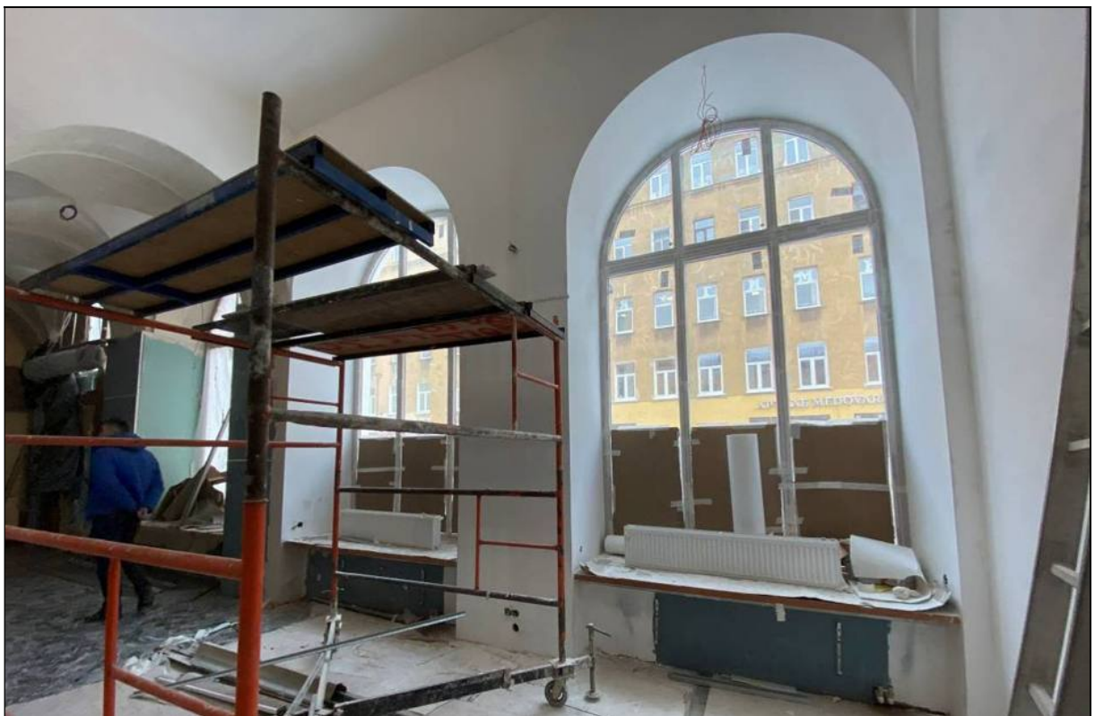
49. Объект культурного наследия «Большой железный ряд или Кожевенная линия». Северный корпус. 1-й этаж, оконные проемы в южной части помещений №№ 101, 105. 24.02.2021 г.
