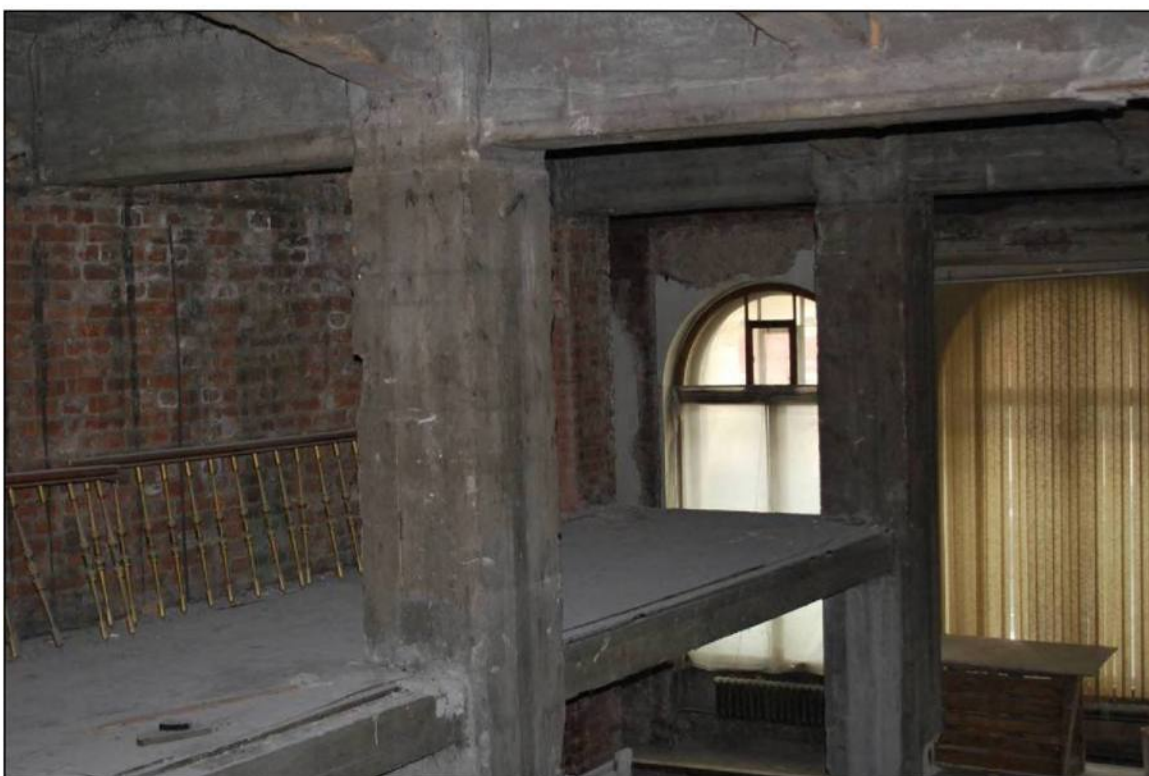
Илл. 220. Объект культурного наследия «Большой железный ряд или Кожевенная линия». Средний корпус. 2-й этаж, второй свет, железобетонные конструкции. 31.03.2019 г.
