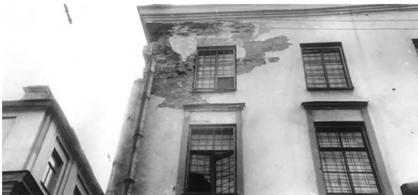
Илл. 34. Малый гостиный двор. Большой железный ряд. Фрагмент фасада со стороны Москательного переуллка. Архив института «Ленжилпроект». 1984 год.
