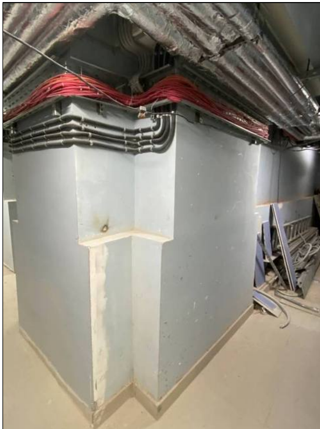
20. Объект культурного наследия «Большой железный ряд или Кожевенная линия». Северный корпус. Подвал, коридор вдоль помещений №№ 14, 27. Капитальная стена по оси 4. Вид от помещения № 15. 24.02.2021 г.
