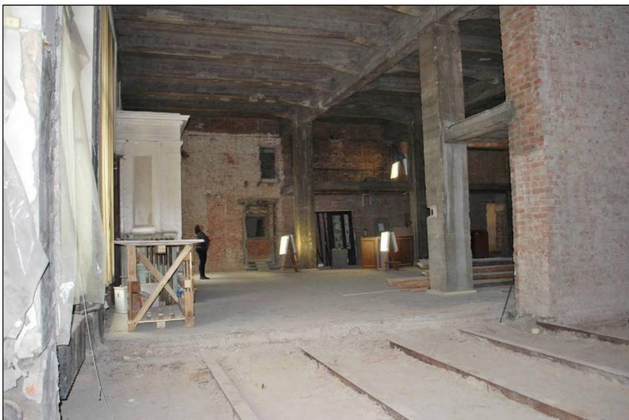
Илл. 208. Объект культурного наследия «Большой железный ряд или Кожевенная линия». Средний корпус. 1-й этаж, помещение № 48, вид от помещения № 50. 31.03.2019 г.
