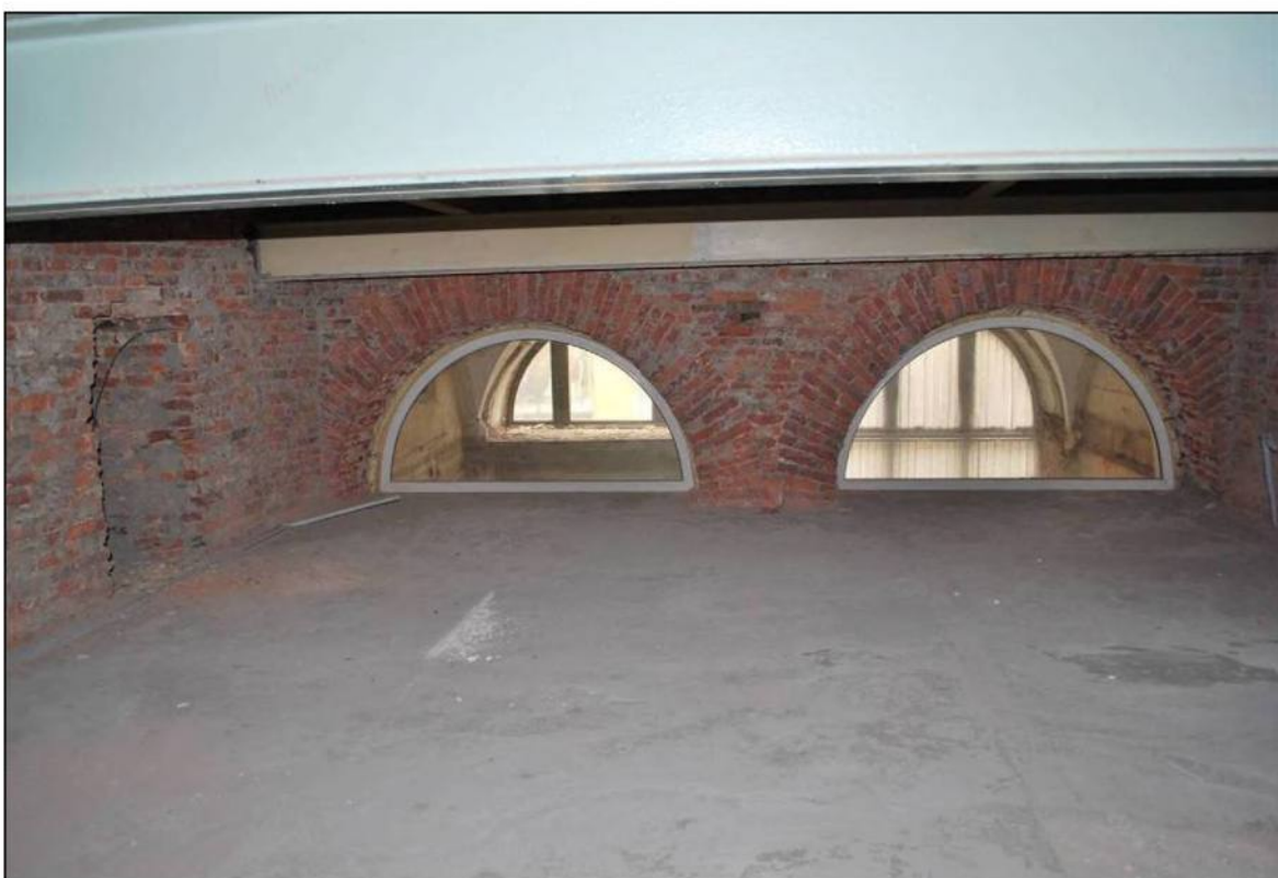
Илл. 222. Объект культурного наследия «Большой железный ряд или Кожевенная линия». Средний корпус. 2-й этаж, южная часть помещения № 68, арочные проемы. 31.03.2019 г.
