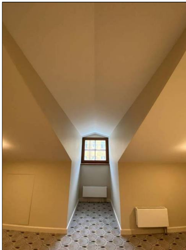
140. Объект культурного наследия «Большой железный ряд или Кожевенная линия». Северный корпус. 4-й этаж, помещение № 411/1. Оконный проем. 24.02.2021 г.
