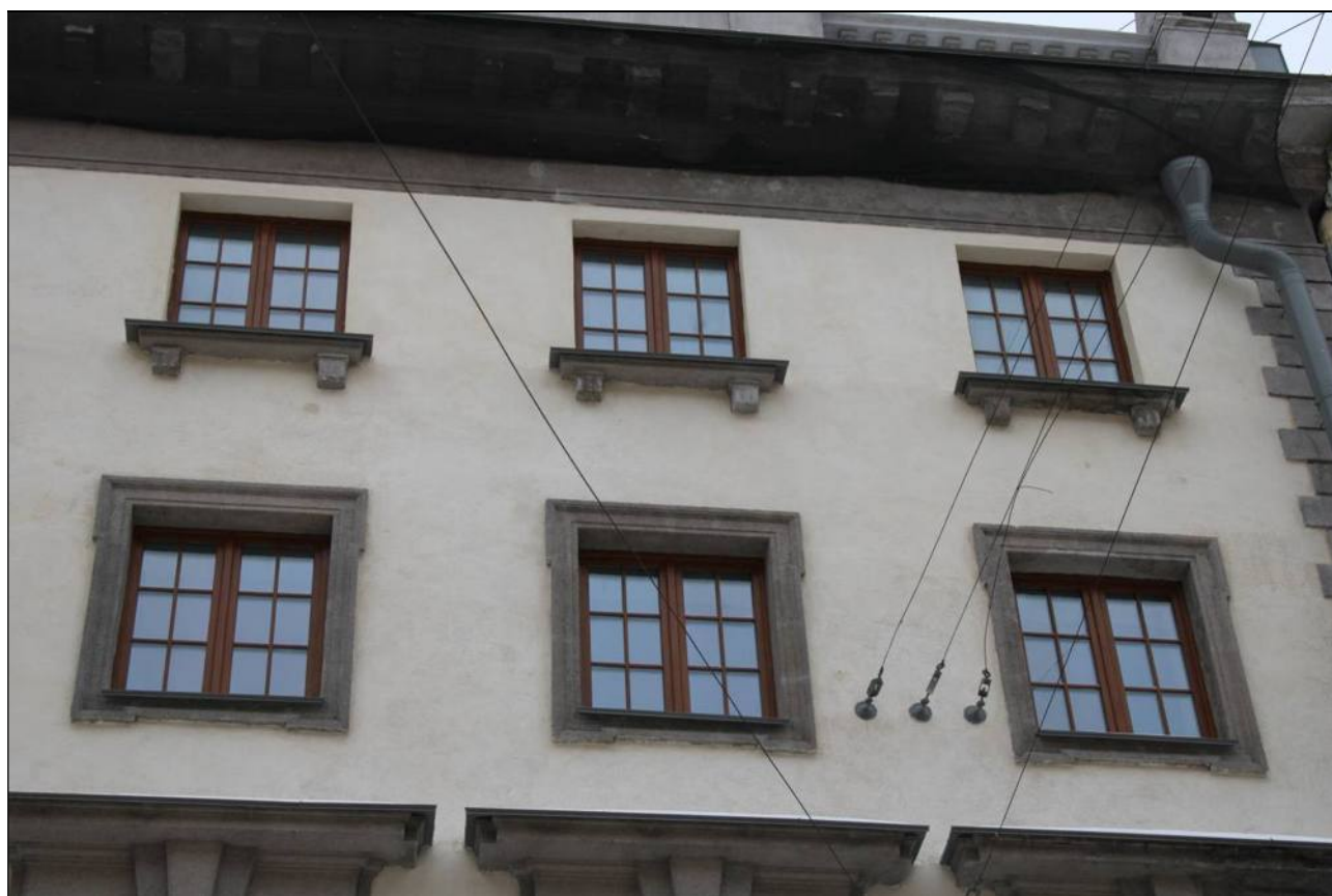
9. Объект культурного наследия «Большой железный ряд или Кожевенная линия». Средний корпус. Фрагмент лицевого фасада по Мучному переулку. Оконные проемы 3-го и 4-го этажей. 24.02.2021 г.
