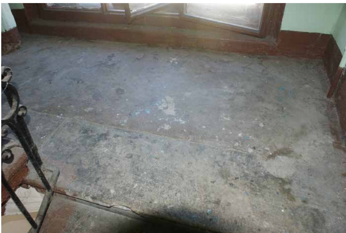
Фото 169. Лестница № 7. Площадка м/у 4-м и чердачным этажом. Оформление пола. Съемка 19.04.2021 г. Трушковский В.Э.
