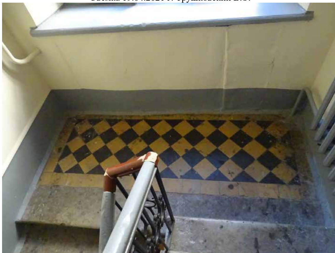
Фото 93. Лестница № 4. Площадка м/у 1-м и 2-м этажом. Покрытие пола. Съемка 19.04.2021 г. Трушковский В.Э.
