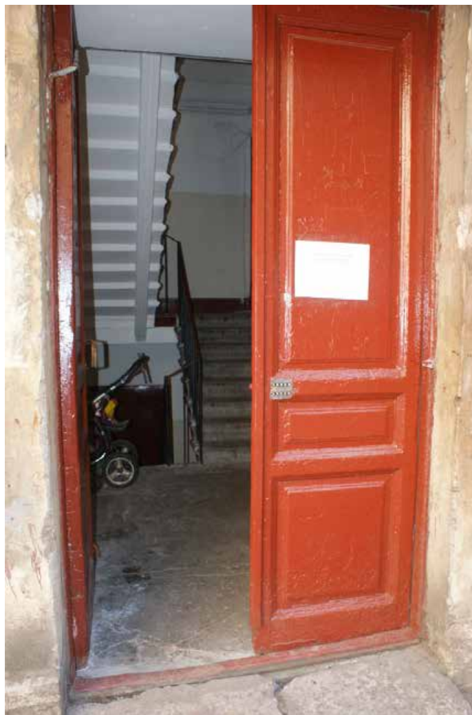
Фото 106. Лестница № 5. 1-й этаж. Дверное заполнение. Съемка 19.04.2021 г. Трушковский В.Э.
