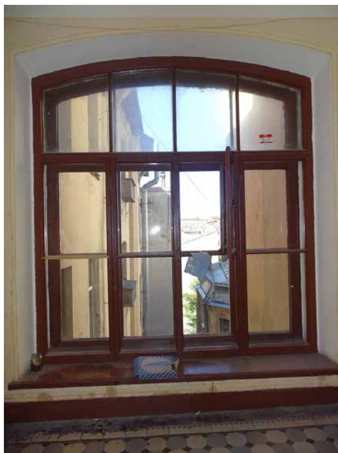
Фото 56. Лестница № 2. Площадка между 3-м и 4-м этажом. Оконное заполнение. Съемка 19.04.2021 г. Трушковский В.Э.
