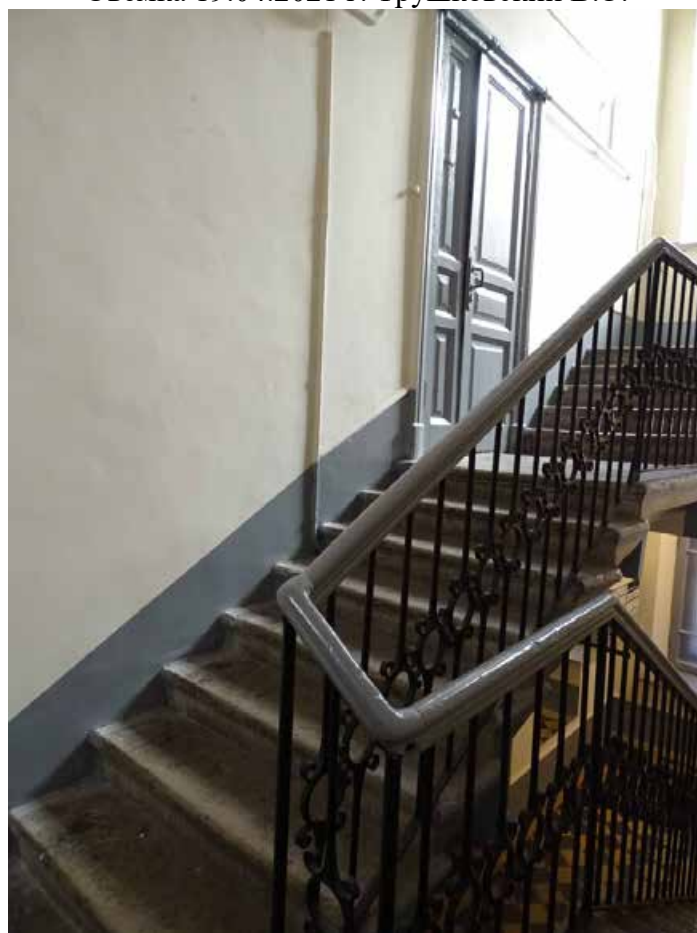
Фото 90. Лестница № 4. Промежуточная площадка м/у 1-м и 2-м этажом. Съемка 19.04.2021 г. Трушковский В.Э.
