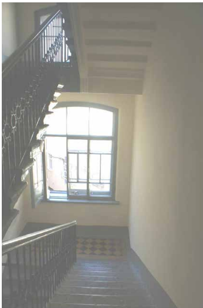
Фото 99. Лестница № 4. Площадка м/у 3-м и 4-м этажом. Съемка 19.04.2021 г. Трушковский В.Э.
