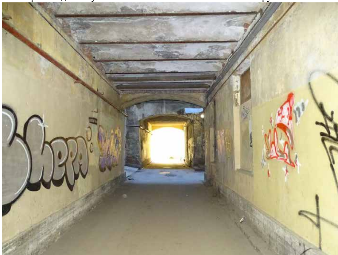
Фото 33. Здание по адресу: г. Санкт-Петербург, Тучков пер., 11/5, литера А. Воротный проезд. Съемка 19.04.2021 г. Трушковский В.Э.
