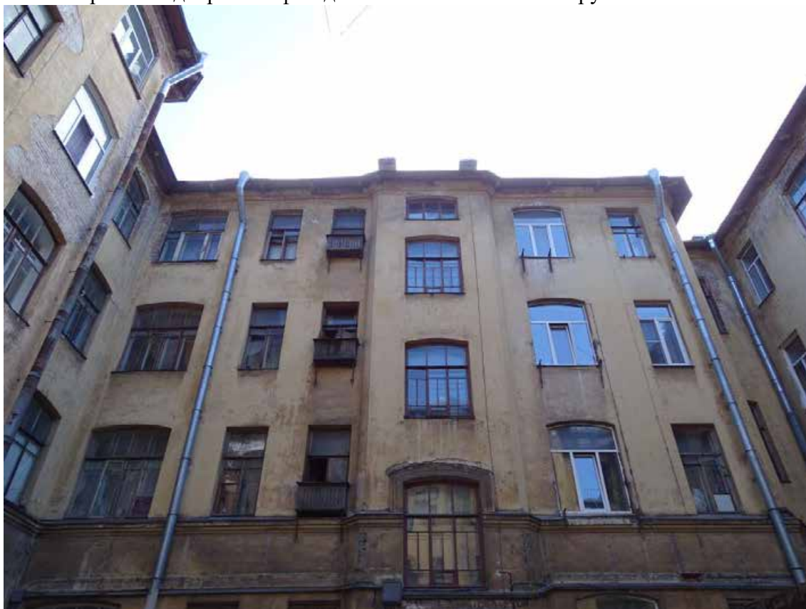
Фото 59. Здание по адресу: г. Санкт-Петербург, Тучков пер., 11/5, литера А. Фрагмент дворового фасада. Лицевой корпус. Съемка 19.04.2021 г. Трушковский В.Э.
