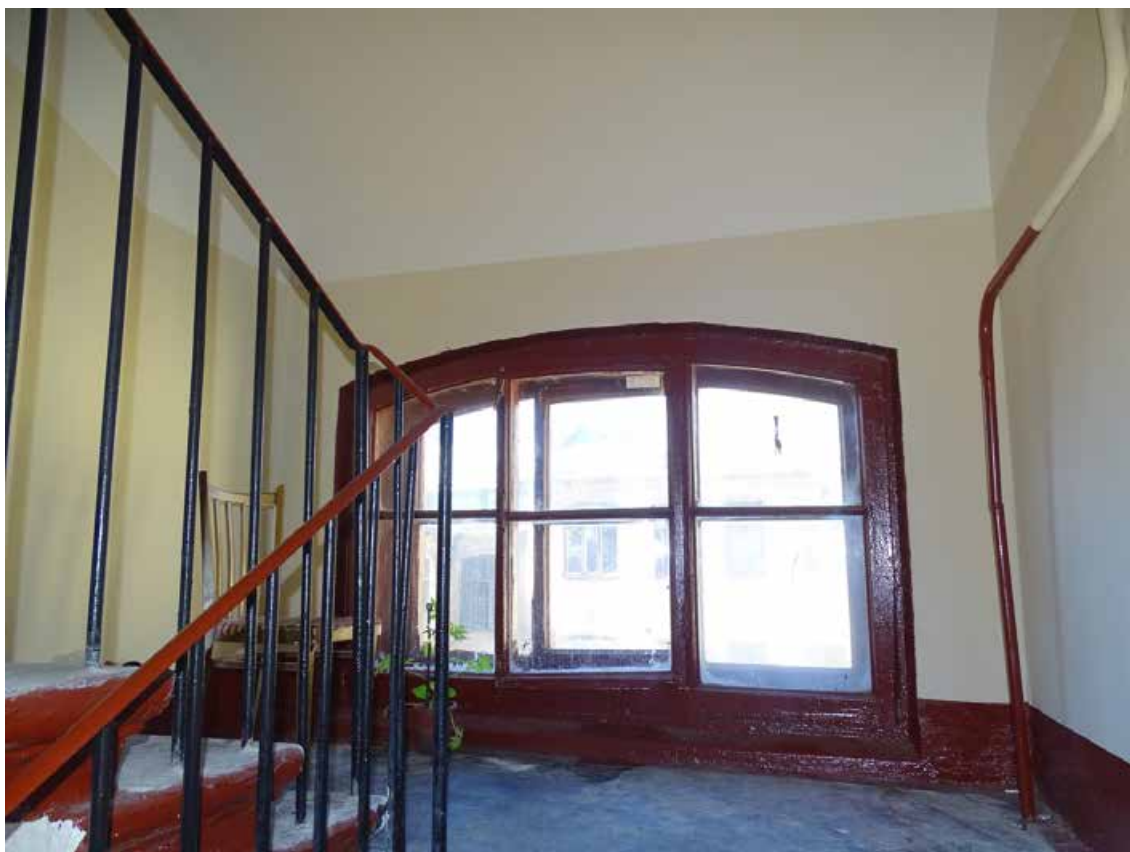
Фото 124. Лестница № 5. Площадка м/у 4-м и 5-м этажом. Съемка 19.04.2021 г. Трушковский В.Э.
