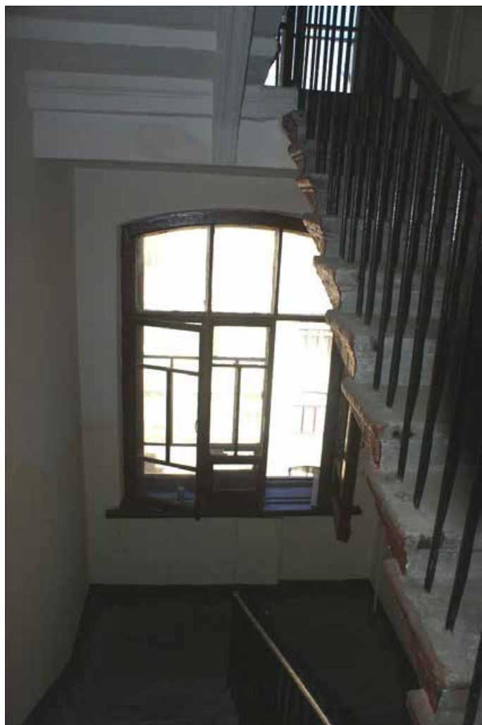
Фото 137. Лестница № 6. Площадка м/у 3-м и 4-м этажом. Съемка 19.04.2021 г. Трушковский В.Э.
