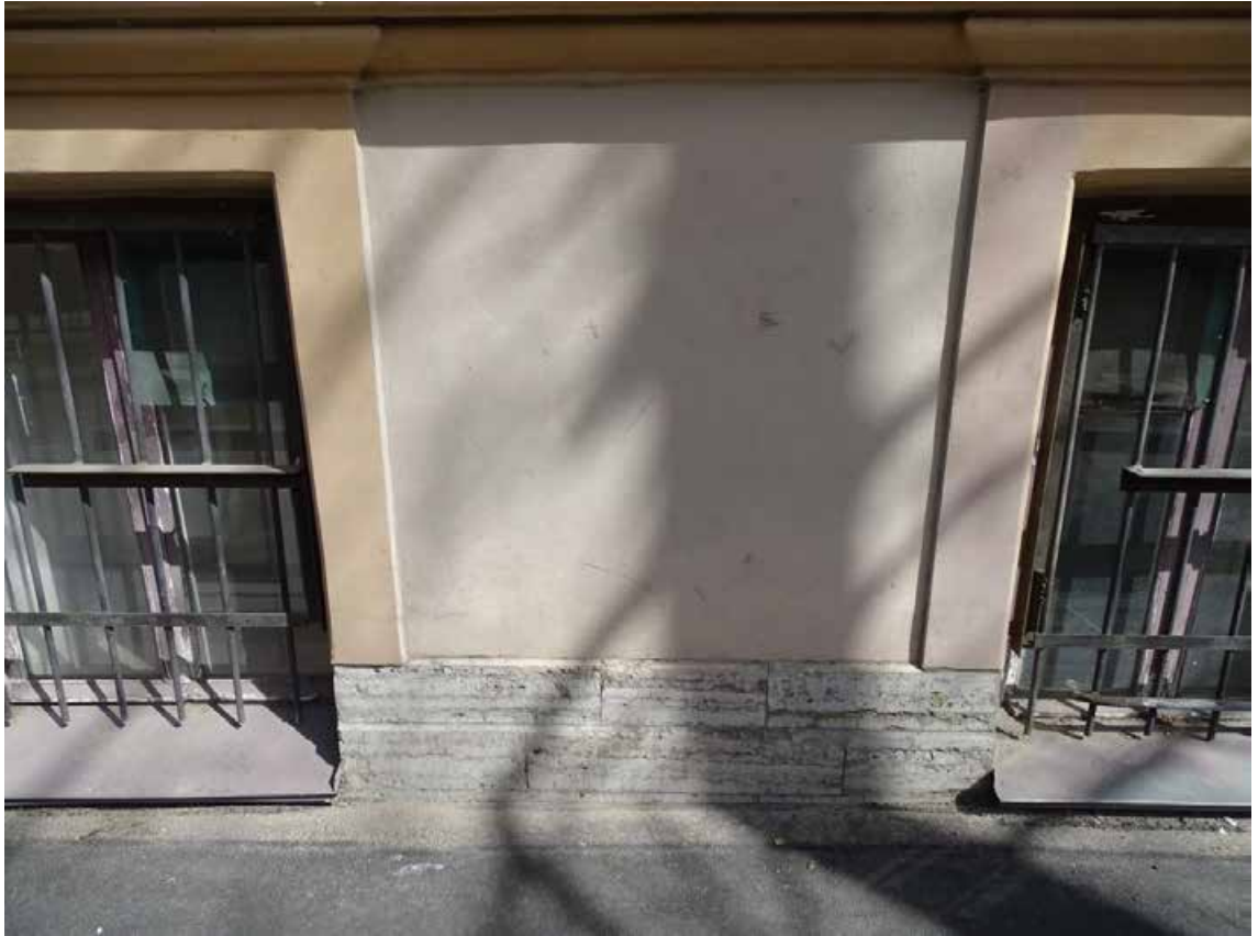
Фото 15. Здание по адресу: г. Санкт-Петербург, Тучков пер., 11/5, литера А. Фрагмент лицевого фасада со стороны Тучкова пер. Цоколь из известняка. Съемка 19.04.2021 г. Трушковский В.Э.
