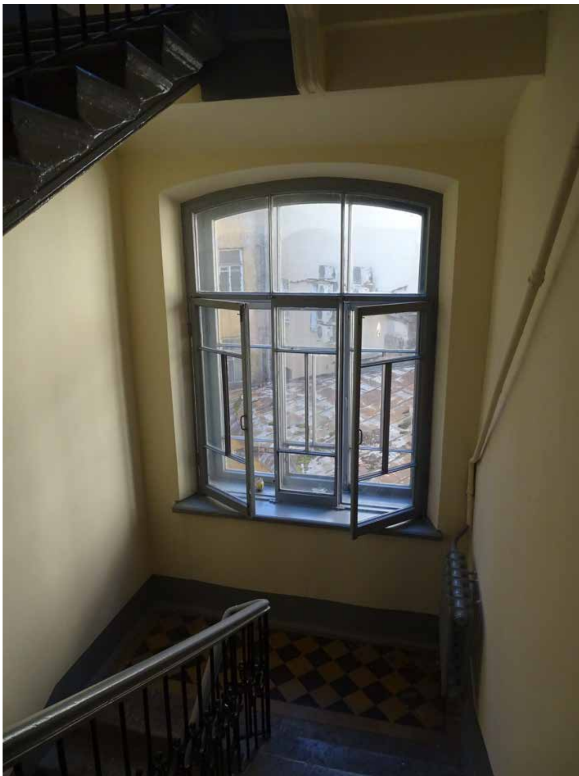
Фото 95. Лестница № 4. Площадка м/у 2-м и 3-м этажом. Съемка 19.04.2021 г. Трушковский В.Э.
