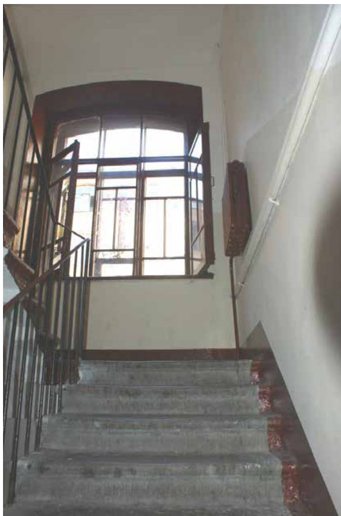
Фото 112. Лестница № 5. Площадка м/у 1-м и 2-м этажом. Съемка 19.04.2021 г. Трушковский В.Э.
