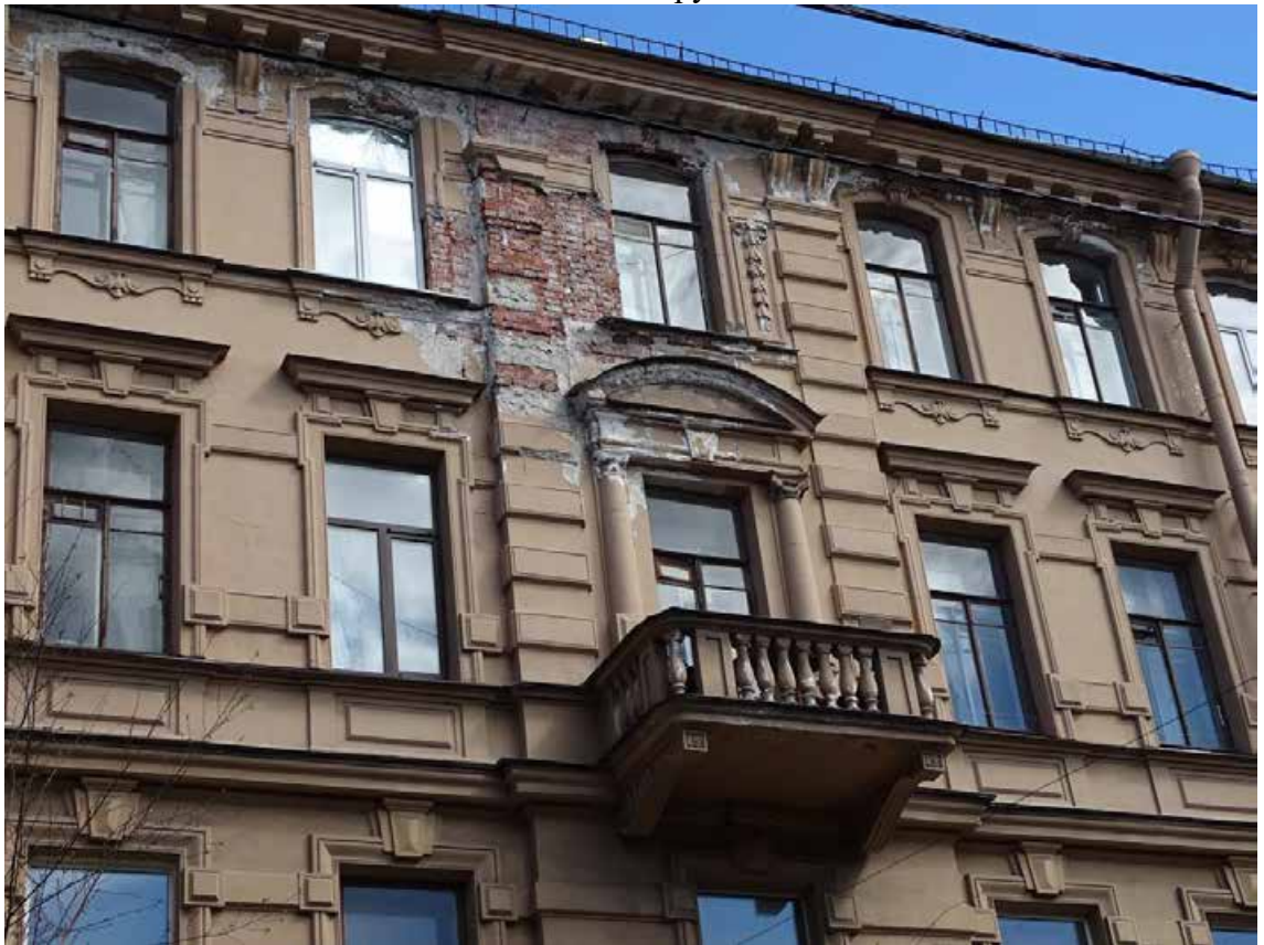
Фото 12. Здание по адресу: г. Санкт-Петербург, Тучков пер., 11/5, литера А. Фрагмент лицевого фасада со стороны Тучкова пер. Балкон. 4-й, 5-й этаж. Съемка 19.04.2021 г. Трушковский В.Э.
