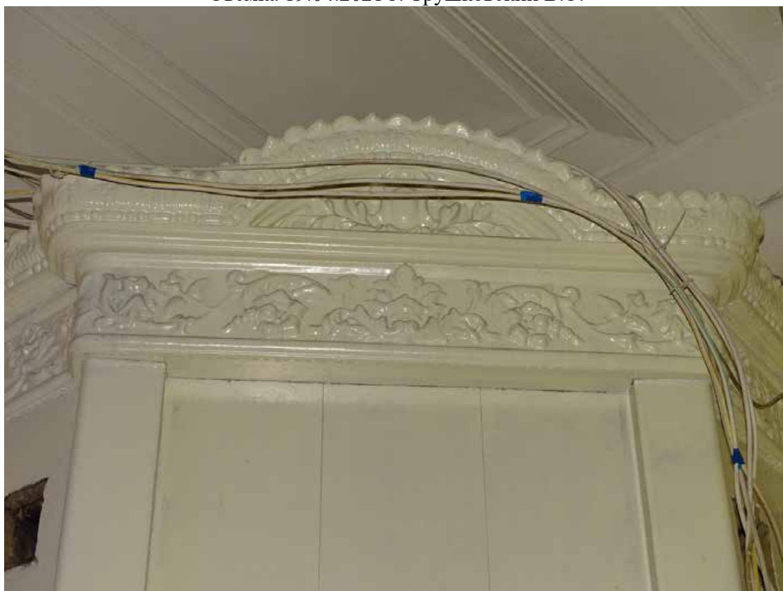
Фото 80. Лестница № 3. 1-й этаж. Фигурное навершие фронтона. Съемка 19.04.2021 г. Трушковский В.Э.
