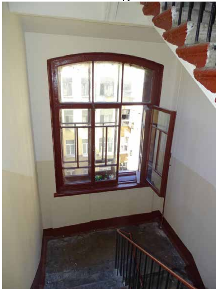
Фото 121. Лестница № 5. Площадка м/у 3-м и 4-м этажом. Съемка 19.04.2021 г. Трушковский В.Э.
