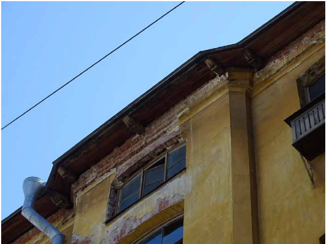
Фото 43. Здание по адресу: г. Санкт-Петербург, Тучков пер., 11/5, литера А. Фрагмент северо-восточного дворового фасада. Съемка 19.04.2021 г. Трушковский В.Э.
