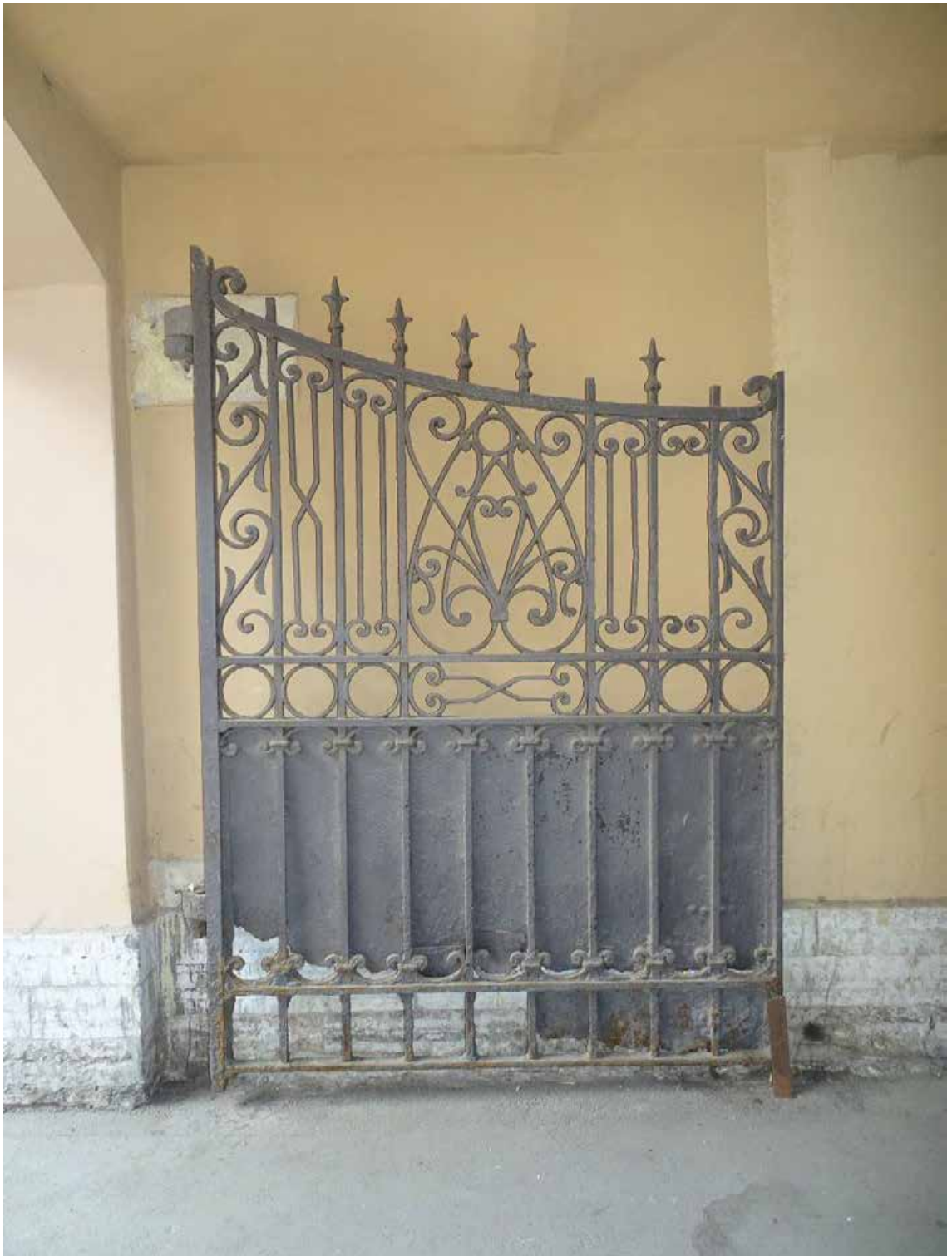
Фото 64. Здание по адресу: г. Санкт-Петербург, Тучков пер., 11/5, литера А. Воротное заполнение. Съемка 19.04.2021 г. Трушковский В.Э.
