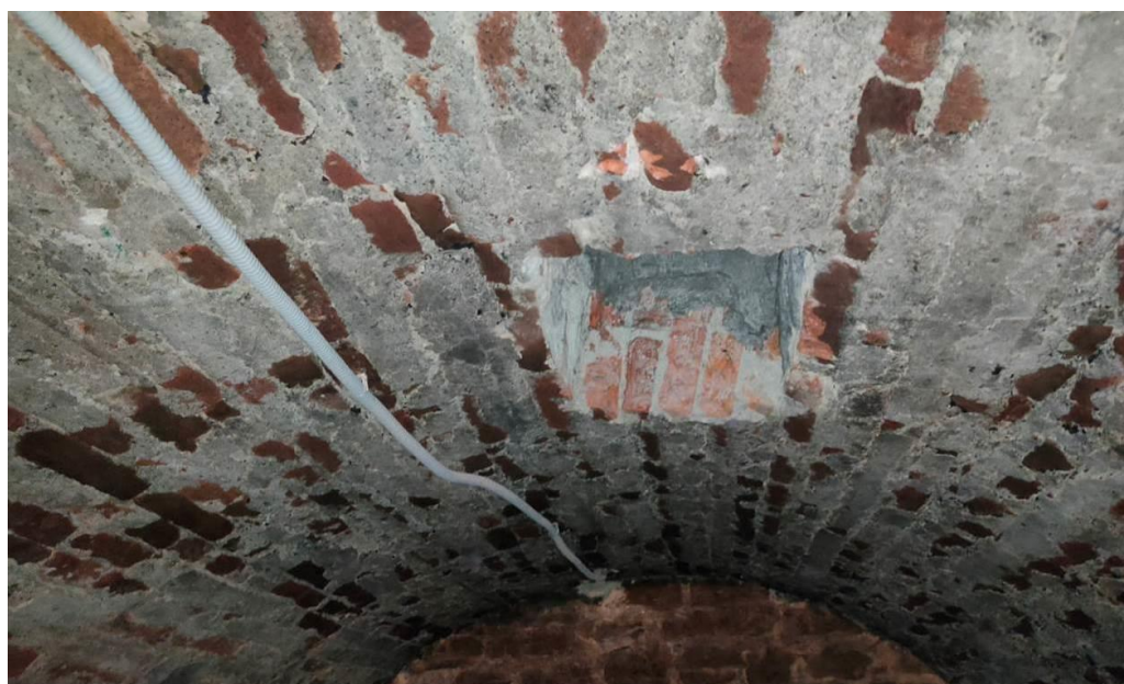
17. Объект культурного наследия федерального значения «Театр Александринский» по адресу: г. Санкт-Петербург, пл. Островского, д. 6, литера А. Помещение №158. Общий вид свода в западной части. Существующее отверстие под инженерные сети.
