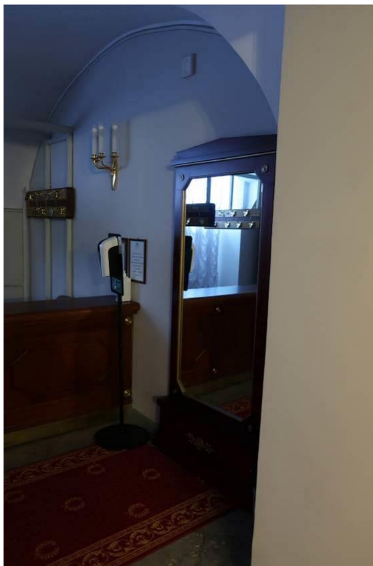
39. Объект культурного наследия федерального значения «Театр Александринский» по адресу: г. Санкт-Петербург, пл. Островского, д. 6, литера А. Помещение №100. Вид на место закладки оконного проема с обратной стороны стены (в помещении №2 в месте заложеного оконного проема – ниша).
