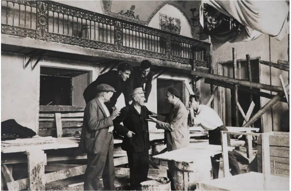
Илл. 58. Царское фойе во время проведения ремонтных работ 1932 г. (ФГБУК «Национальный драматический театр России (Александринский театр)», литературный отдел. Фотоальбом «Ремонтные работы к 100-летию здания Александринского театра», 1932 г.)
