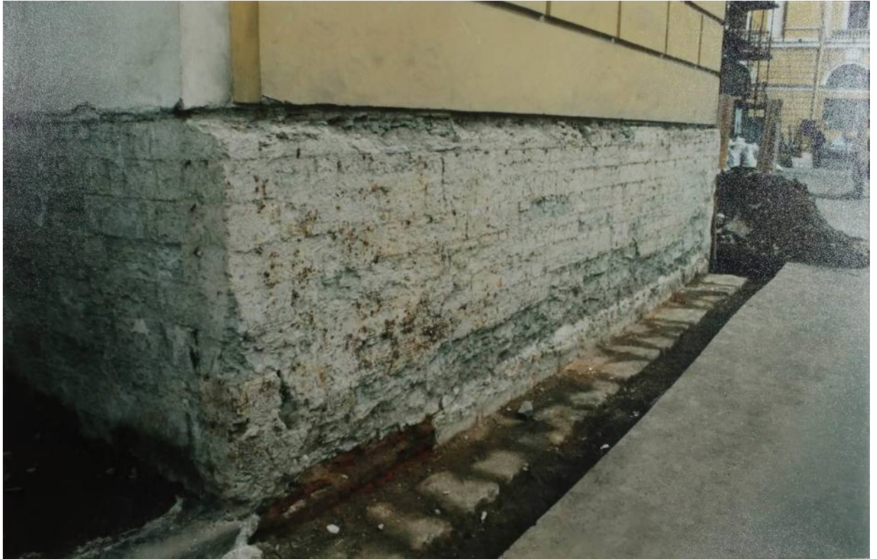
Илл. 76. Фрагмент цоколя в процессе проведения реставрационных работ 1999-2003 гг. Фото 2000 г. (Архив С.В. Лалазарова, руководителя архитектурно-реставрационной мастерской НИИ «Спецпроектреставрация» во время производства проектных и реставрационных работ)
