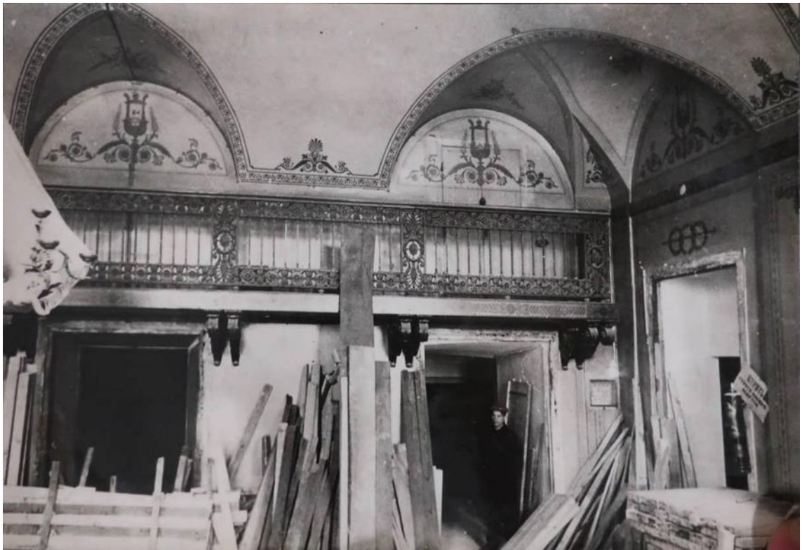
Илл. 56. Царское фойе во время проведения ремонтных работ 1932 г. (ФГБУК «Национальный драматический театр России (Александринский театр)», литературный отдел. Фотоальбом «Ремонтные работы к 100-летию здания Александринского театра», 1932 г.)
