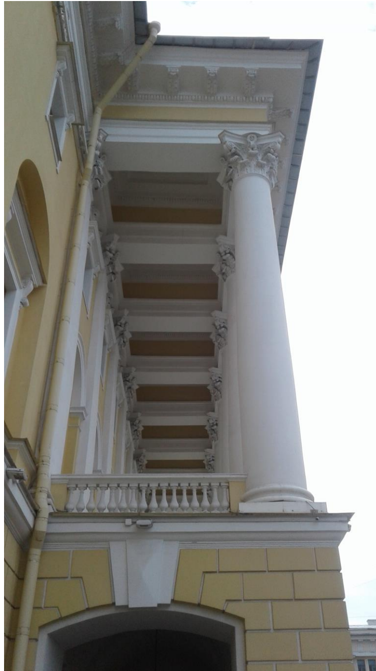
7. Объект культурного наследия федерального значения «Театр Александринский» по адресу: г. Санкт-Петербург, пл. Островского, д. 6, литера А. Западный фасад. Портик. Фрагмент. Обработка потолка.
