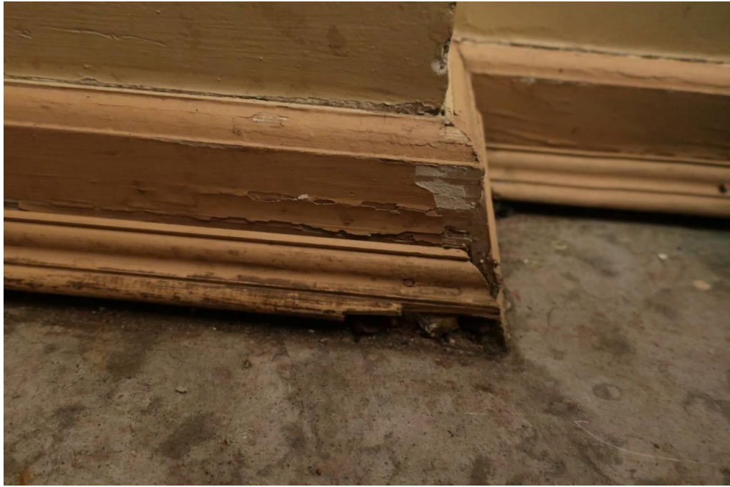
33. Объект культурного наследия федерального значения «Театр Александринский» по адресу: г. Санкт-Петербург, пл. Островского, д. 6, литера А. Помещение №2. Плинтус. Фрагмент.
