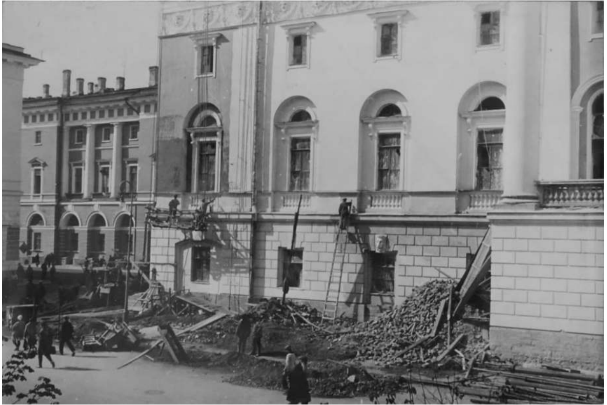
Илл. 43. Фрагмент восточного фасада. Фото во время проведения ремонтных работ 1932 г. (ФГБУК «Национальный драматический театр России (Александринский театр)», литературный отдел. Фотоальбом «Ремонтные работы к 100-летию здания Александринского театра», 1932 г.)
