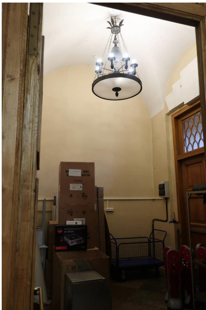
27. Объект культурного наследия федерального значения «Театр Александринский» по адресу: г. Санкт-Петербург, пл. Островского, д. 6, литера А. Помещение №2. Общий вид западной стены (из помещения №1). Западная стена обшита ГКЛ (на всю высоту).
