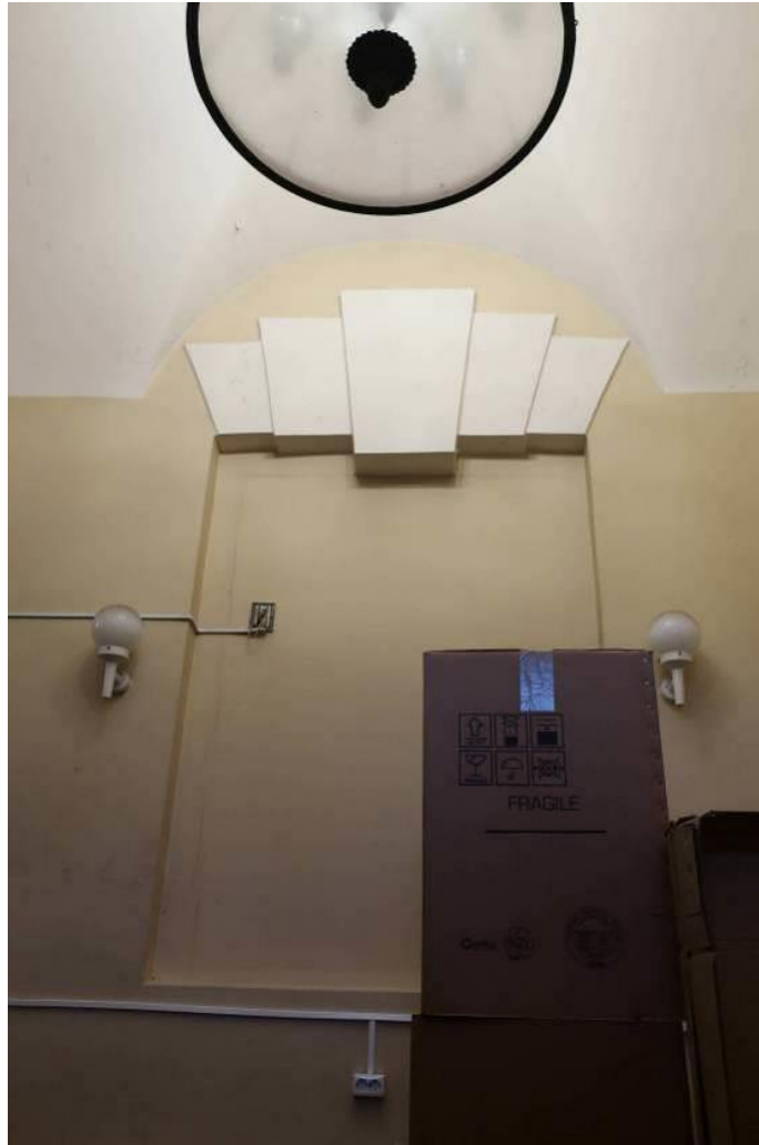
38. Объект культурного наследия федерального значения «Театр Александринский» по адресу: г. Санкт-Петербург, пл. Островского, д. 6, литера А. Помещение №2. Ниша в месте заложеного оконного проема.
