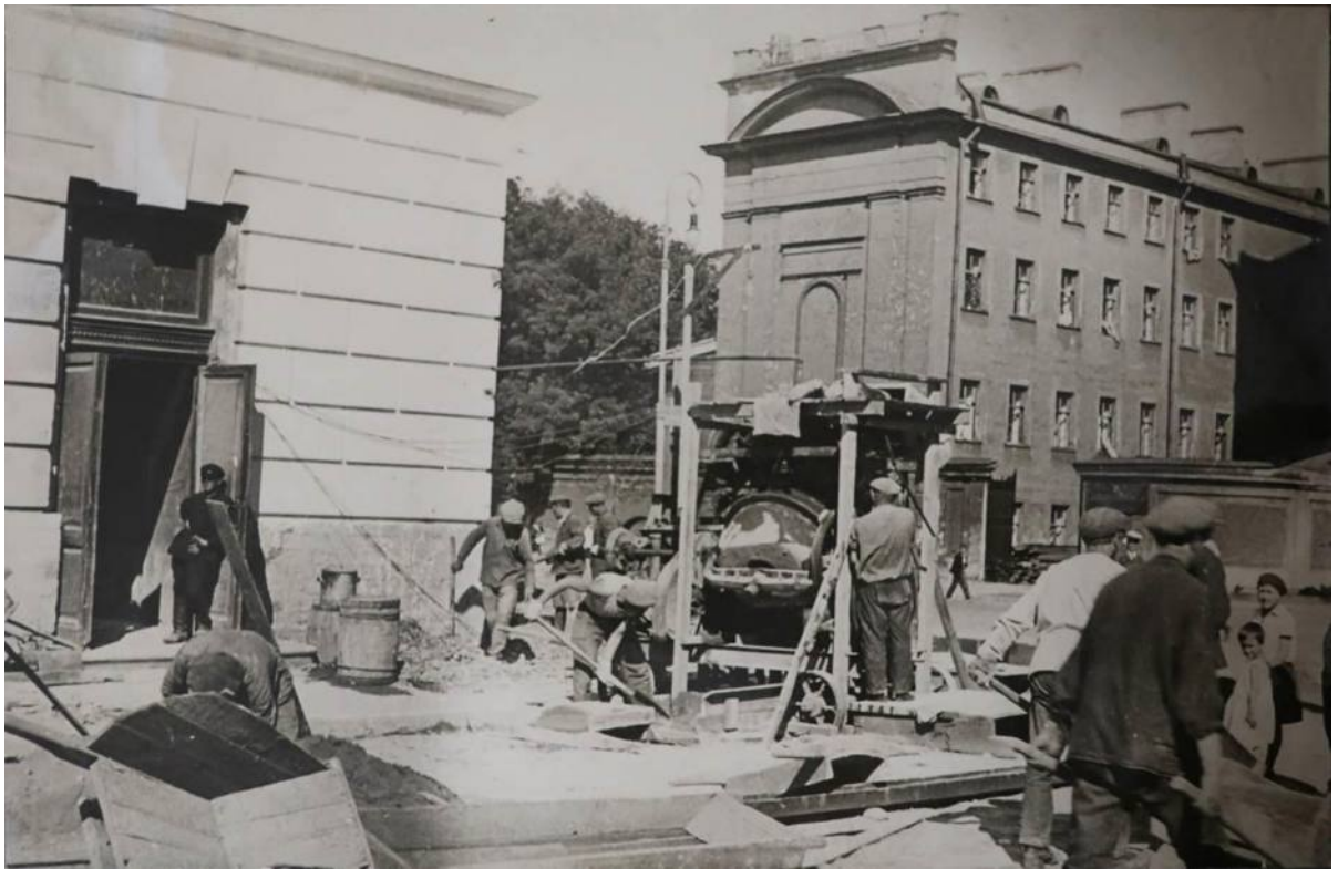
Илл. 41. Фрагмент восточной части заднего фасада со стороны ул. Зодчего Росси. Фото во время проведения ремонтных работ 1932 г. (ФГБУК «Национальный драматический театр России (Александринский театр)», литературный отдел. Фотоальбом «Ремонтные работы к 100- летию здания Александринского театра», 1932 г.)
