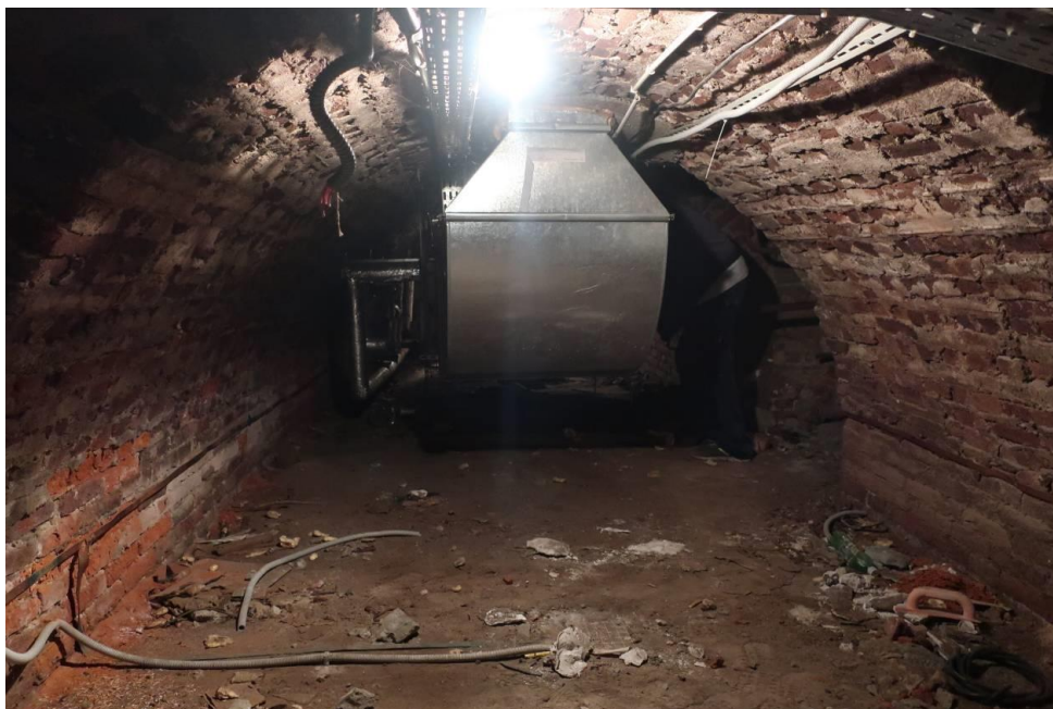
16. Объект культурного наследия федерального значения «Театр Александринский» по адресу: г. Санкт-Петербург, пл. Островского, д. 6, литера А. Помещение №158. Общий вид в восточном направлении. Существующее вентиляционное оборудование.
