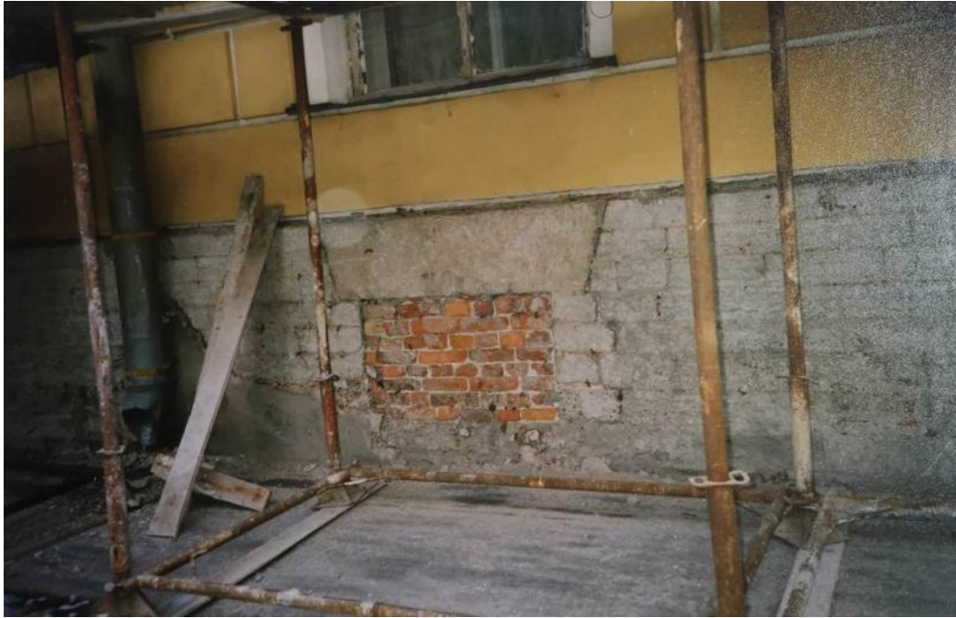
Илл. 78. Фрагмент цоколя в процессе проведения реставрационных работ 1999-2003 гг. Задний фасад, поздняя закладка кирпичом проёма в цоколе. Фото 2000 г. (Архив С.В. Лалазарова, руководителя архитектурно-реставрационной мастерской НИИ «Спецпроектреставрация» во время производства проектных и реставрационных работ)
