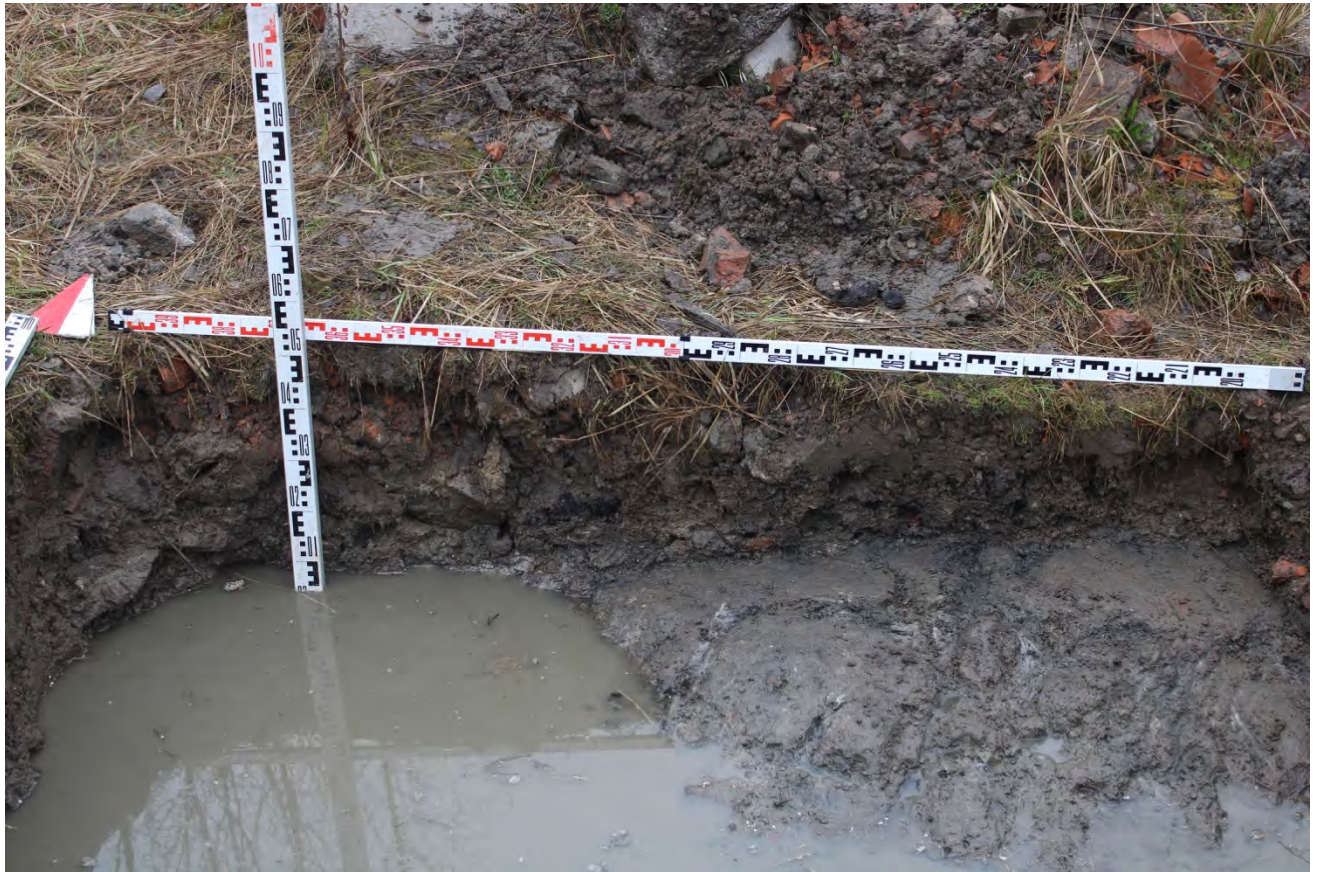
Рис. 73. Санкт-Петербург, г. Санкт-Петербург, Грузовой проезд, участок 1 (напротив дома 29, литера А по Грузовому проезду). Шурф 2. Северная стенка.
