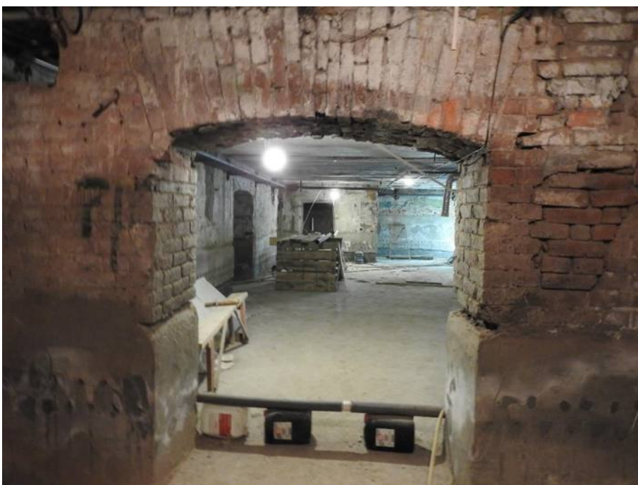
59. «Дом, где жили: в 1912-1936 гг. – путешественник Грум-Гржимайло Г.Е, в 1914-1922 гг. – певец Шаляпин Ф.И». Подвал. Помещение №35. Общий вид. Фото 12.03.2021 г.
