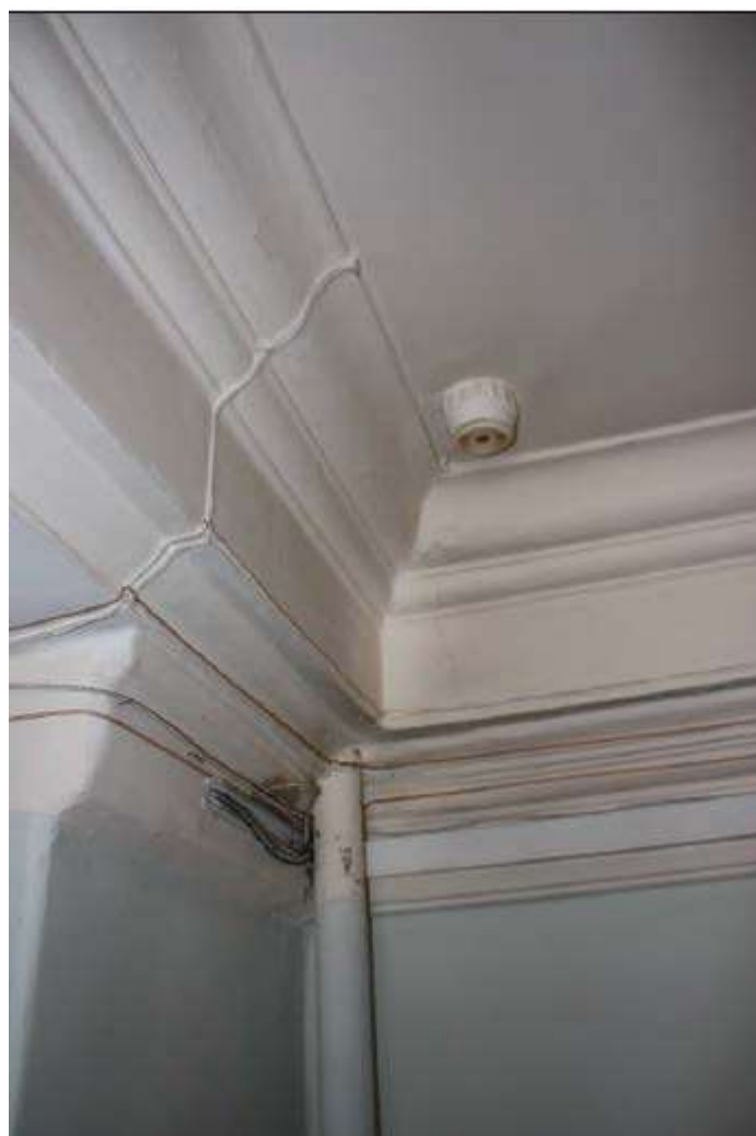
22. Помещение №323 в уровне 2-ого этажа объекта культурного наследия федерального значения «Дворец Таврический. Дворец». 01.12.2020
