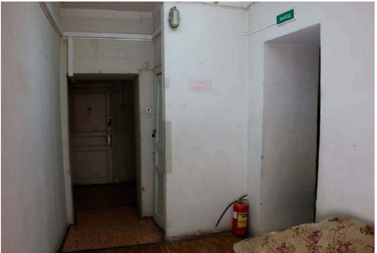
30. Помещение №329 в уровне 2-ого этажа объекта культурного наследия федерального значения «Дворец Таврический. Дворец». 01.12.2020
