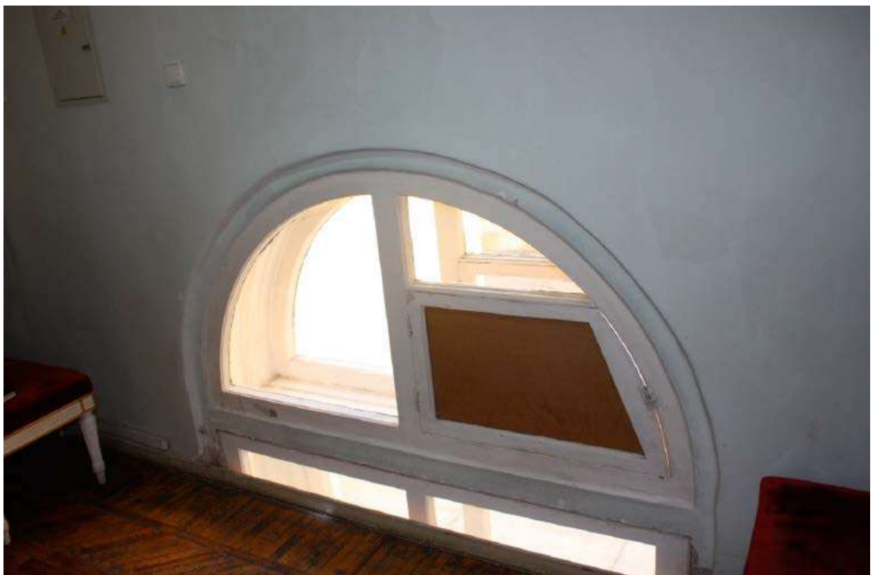
21. Помещение №323 в уровне 2-ого этажа объекта культурного наследия федерального значения «Дворец Таврический. Дворец». 01.12.2020
