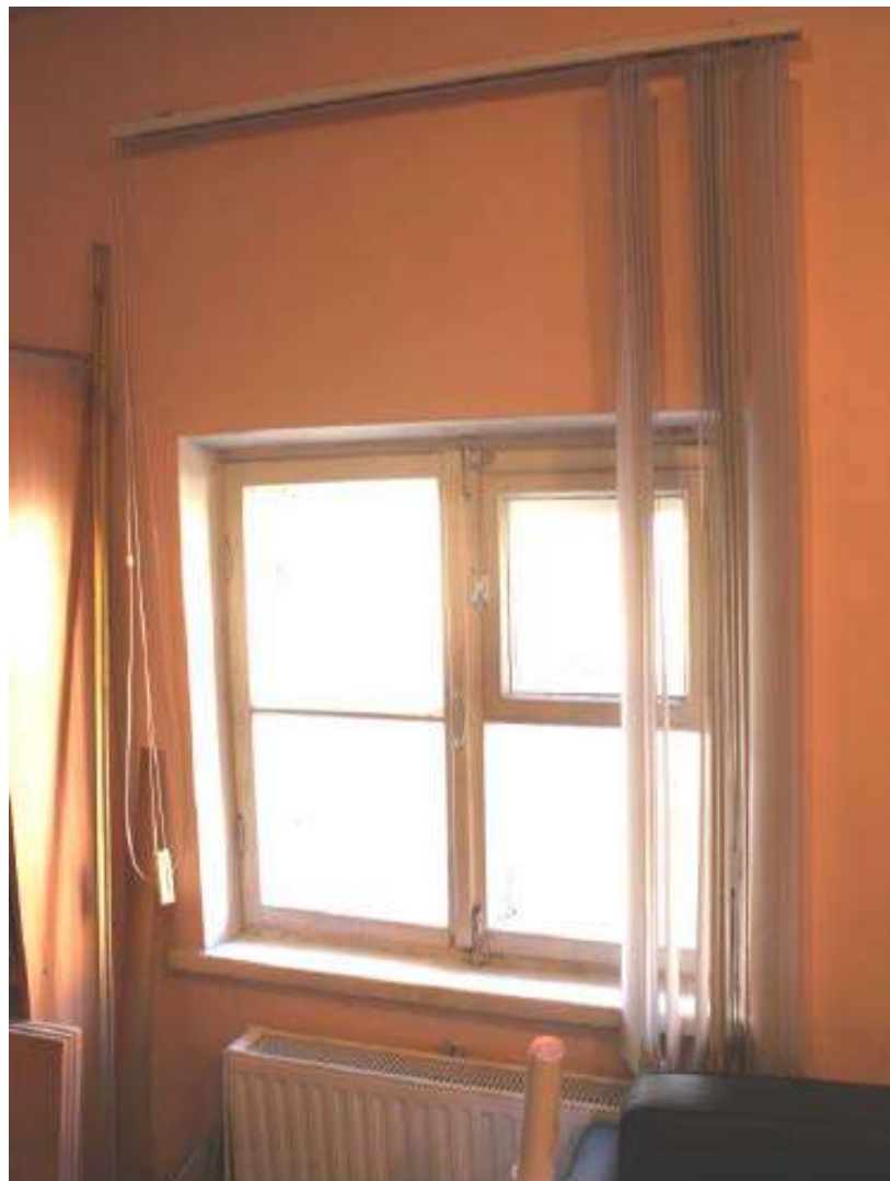
18. Помещение №323 в уровне 2-ого этажа объекта культурного наследия федерального значения «Дворец Таврический. Дворец». 01.12.2020
