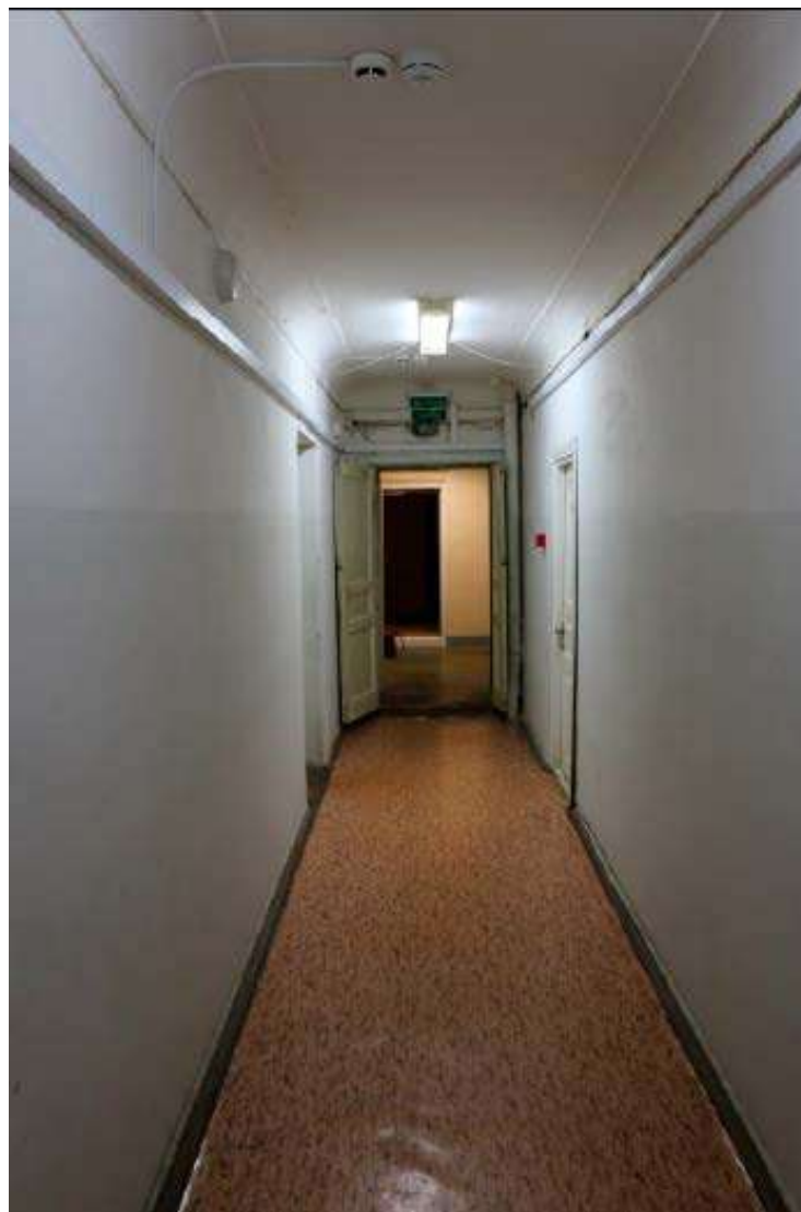
34. Помещение №332 в уровне 2-ого этажа объекта культурного наследия федерального значения «Дворец Таврический. Дворец». 01.12.2020
