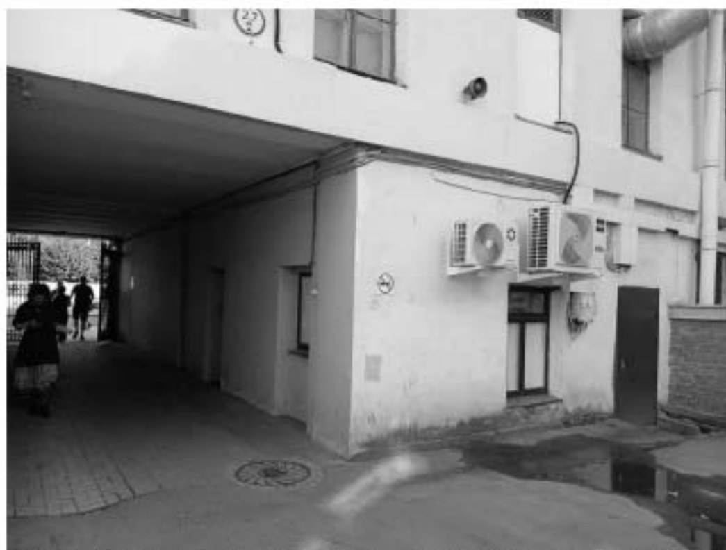
20. «Дом общества Санкт-Петербургского частного ломбарда» (Владимирский пр., д. 17, лит. А). Дворовые фасады. Фото мест установки оборудования и прокладки кабельных трасс. Штиглиц М.С. 05.08.2025.
