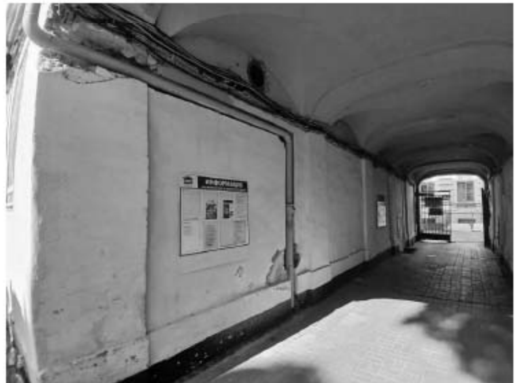
42. «Дом, где в 1865-1928 гг. жил композитор Глазунов А.К.» (Казанская ул., д. 8-10, лит. А). Арочный проезд. Фото мест установки оборудования и прокладки кабельных трасс. Штиглиц М.С. 05.08.2025.
