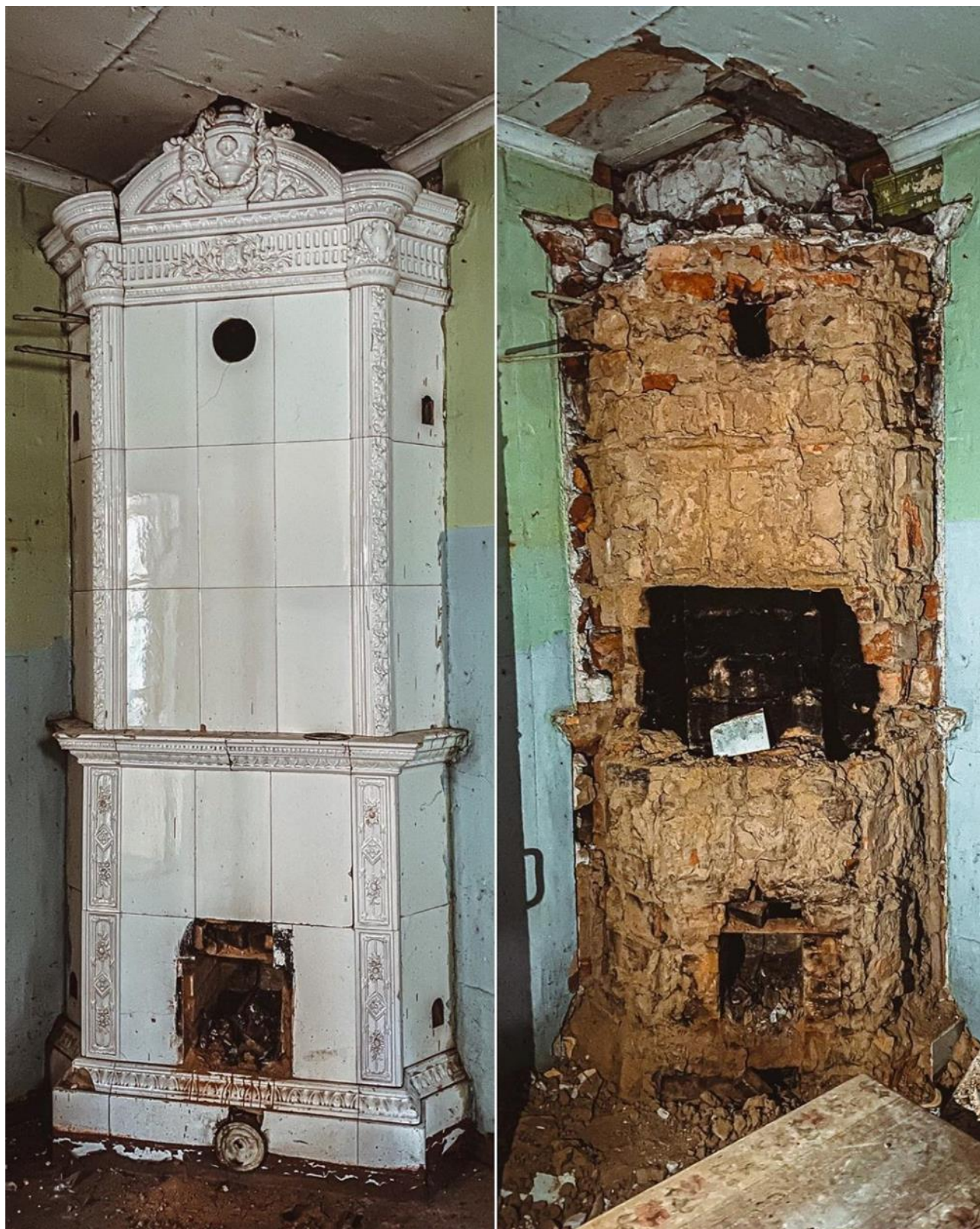
56. Утрата облицовки печи в даче Н. Н. Слободзинского. Фото июнь 2020. [Электронный портал] URL: https://www.sobaka.ru/city/city/112894 .
