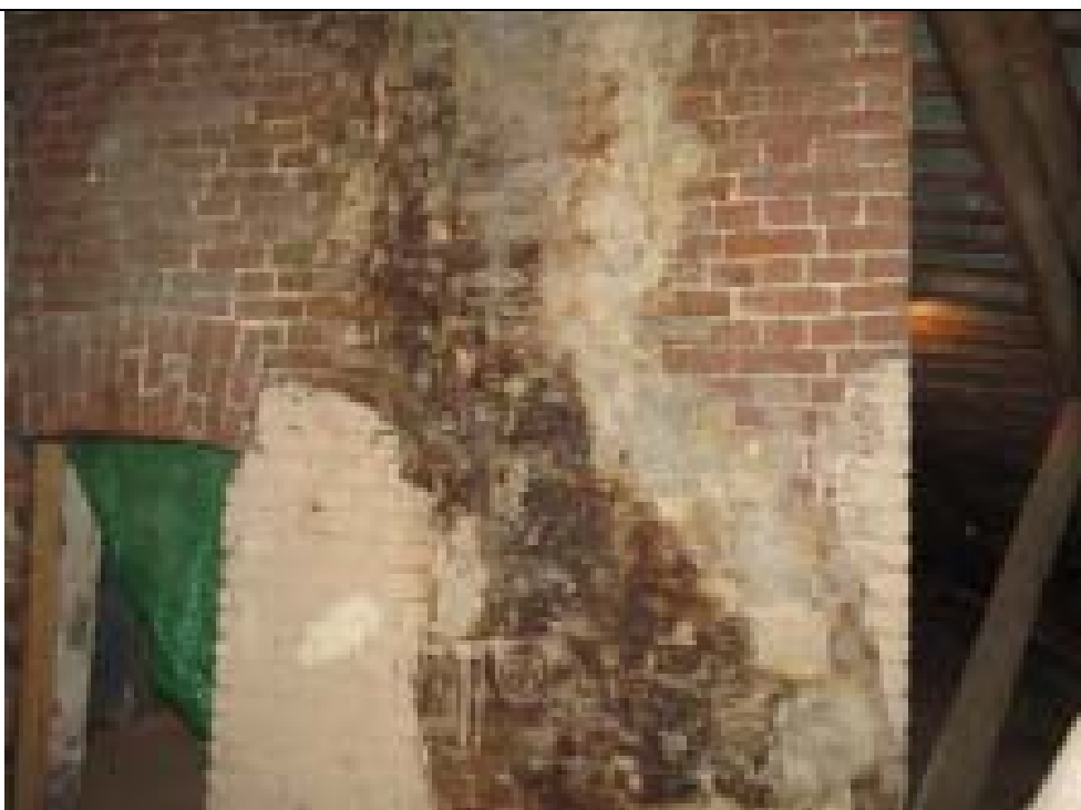
17.«Солдатская казарма с палисадником». Биопоражения кирпичной кладки.
