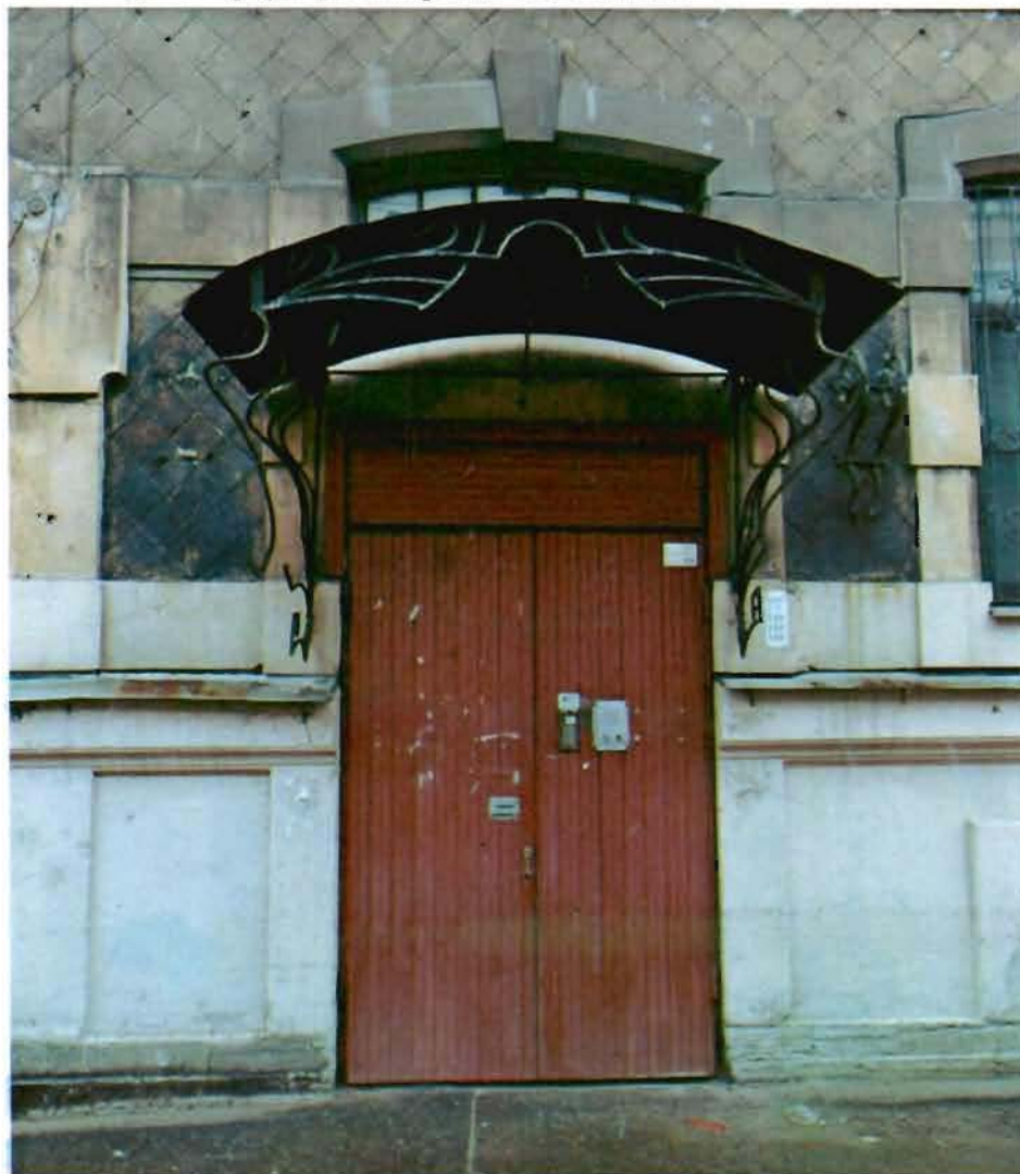
3. Фасад по переулку Макаренко 10. Козырек.
