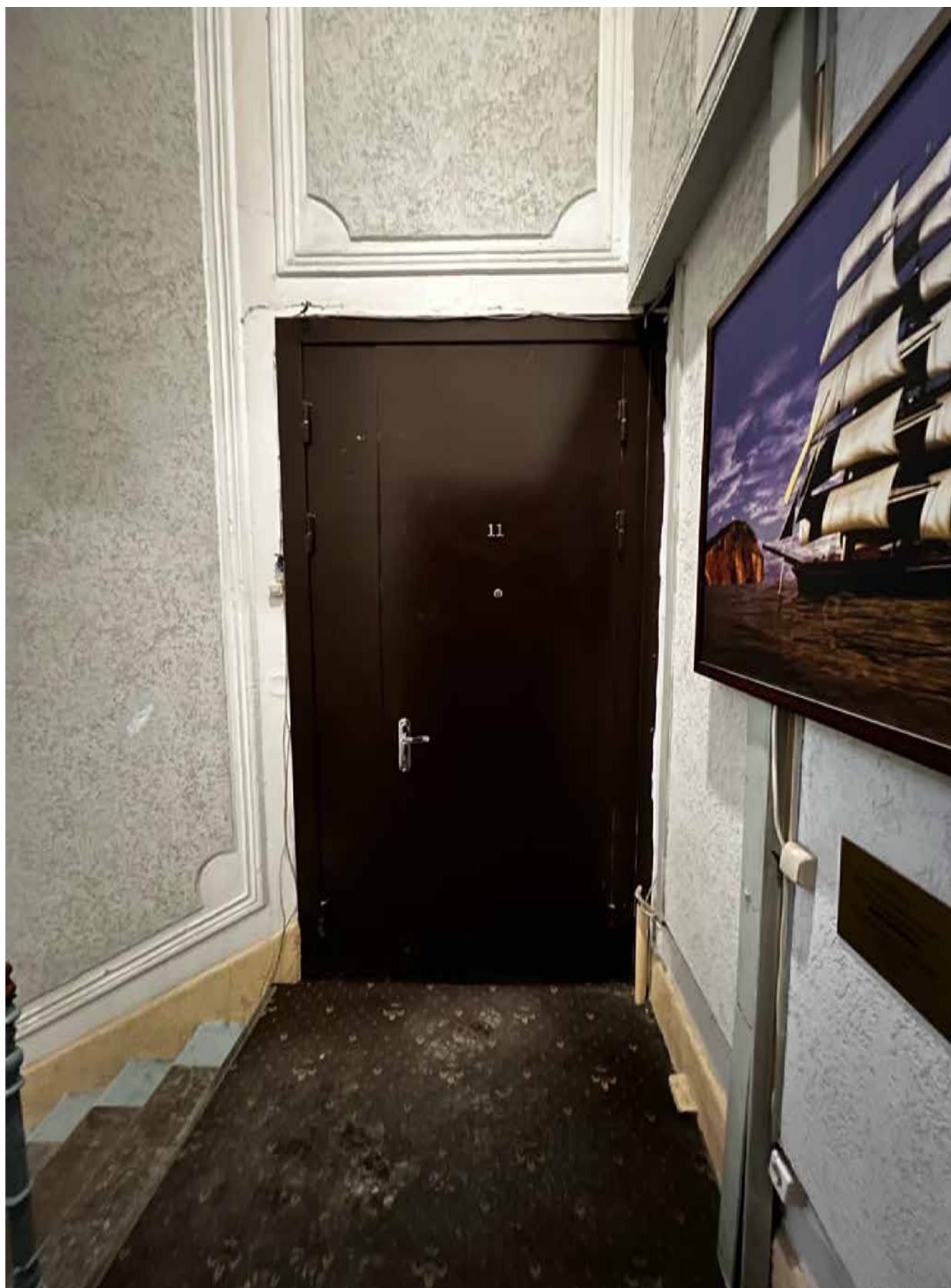
3. Входная дверь квартиры № 11 со стороны 1ЛК.
