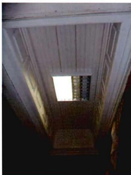
9. Потолок в пом. 1-Н (12).
