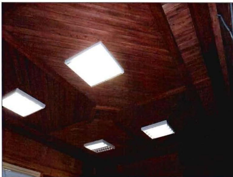
11. Потолок в пом. 1-Н (6).
