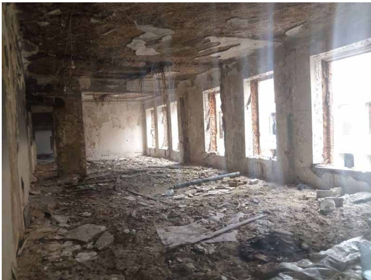
Фото 53. Помещение ЗН(15-20) Общий вид.
