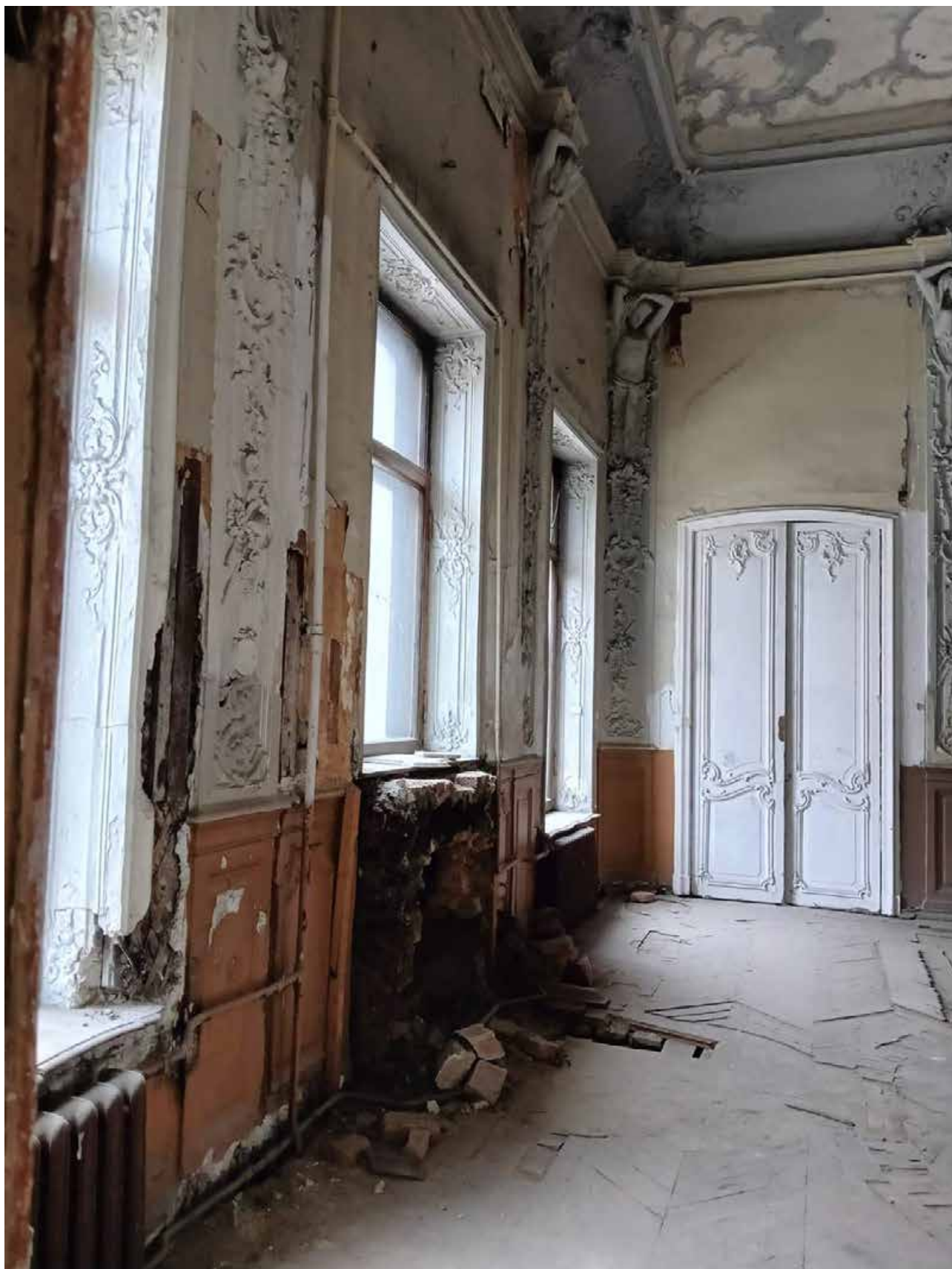
Фото 38. Помещение 3Н(9) (Мифологический зал). Вид на помещение 3Н(10). Вывалы кирпичной кладки на месте камина, дымохода.
