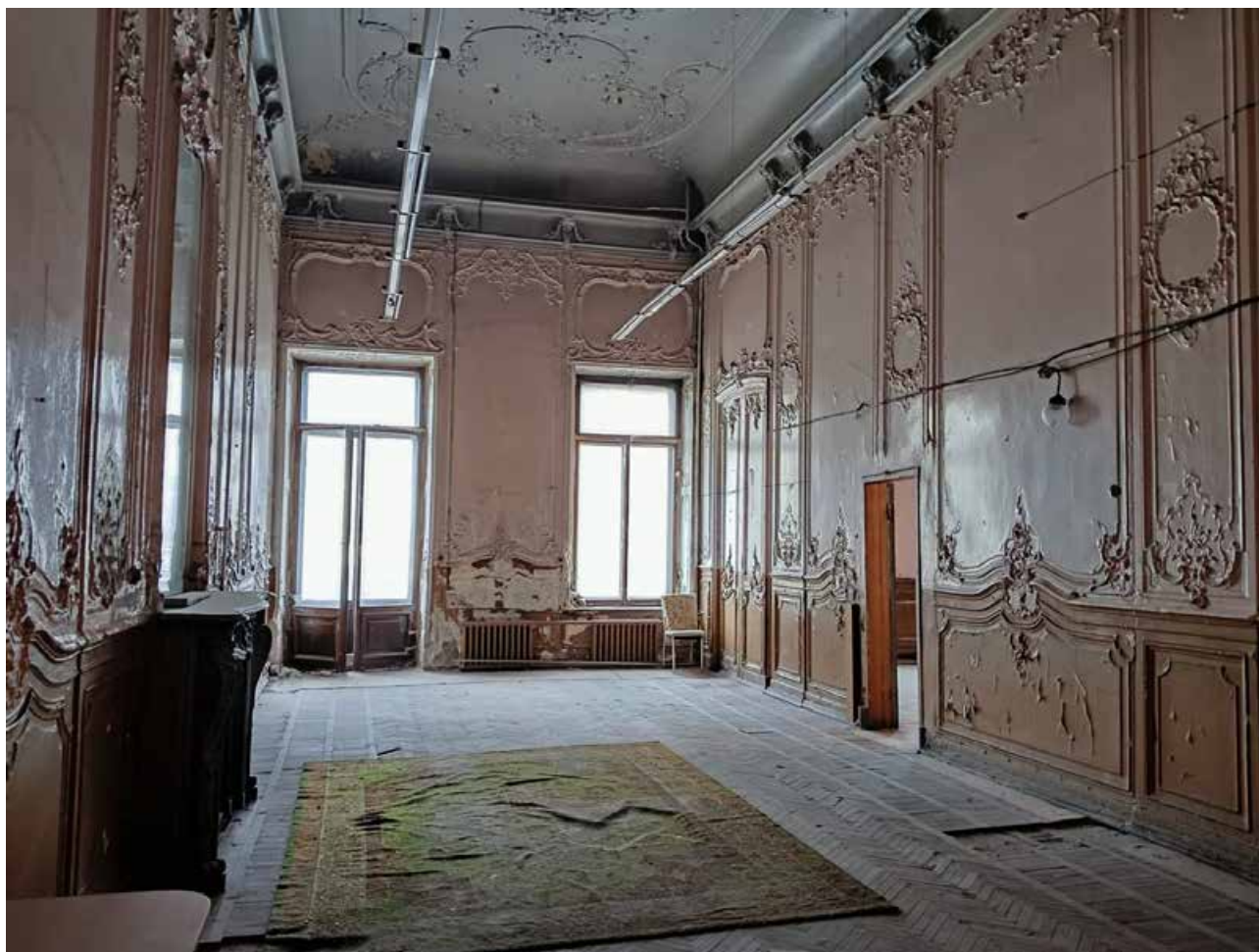
Фото 29. Помещение 3Н(1). верхние 2/3 стен – штукатурные панели двух видов: узкие в виде лопаток (расположены под кронштейнами) и широкие в виде зеркал; все – фигурные, с лепными рокайлями и завитками аканта по верхнему и нижнему краям, лопатки – с лепными медальонами, обрамленными акантовыми завитками – в центральных частях; зеркала – с лепными картушами – в нижней части (распространяются на нижнюю часть стен); нижняя 1/3 стен – профилированные филенчатые (прямоугольные с вогнутыми углами) панели (сосна (?), дуб) двух видов: узкие (под лопатками верхней части) и широкие (под зеркалами) с повышенной фигурной частью в центре и резными композициями из акантовых и С-образных завитков (под ними); время: сер. XIX в.
