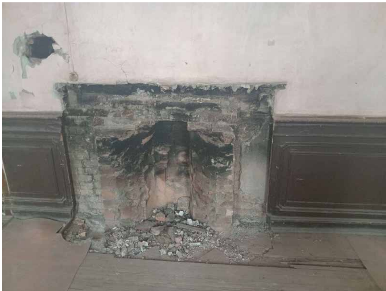
Фото 37. Помещение ЗН(8). Вывалы кирпичной кладки на месте камина, дымохода.
