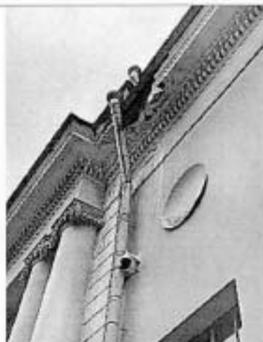
Фото 5. Фрагмент разрушения карнизного свеса (по Инженерной ул.)
