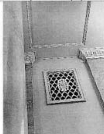
Фото 19. Фрагмент интерьера. Вентиляционная решетка
