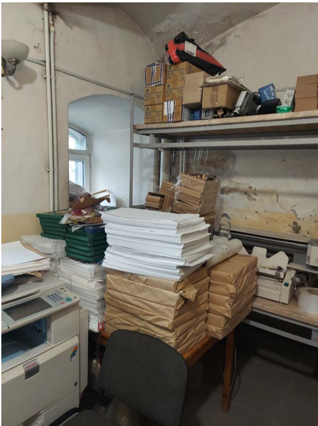
Фото 20. Помещение фотолаборатории и печати в цоколе. Видны протечки в стенах.
