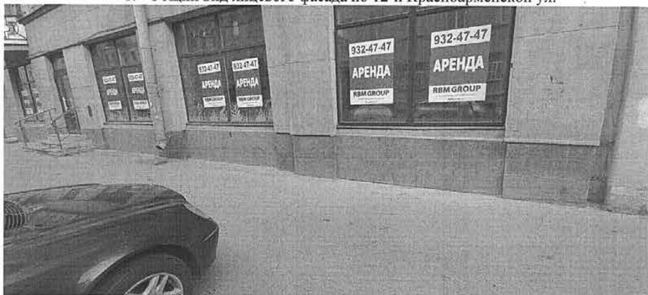
2. Фрагмент лицевого фасада. Состояние цоколя.
