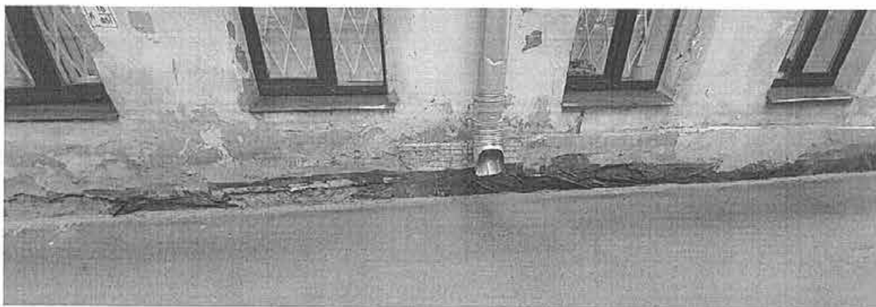
24. Фиксация дефектов цоколя
