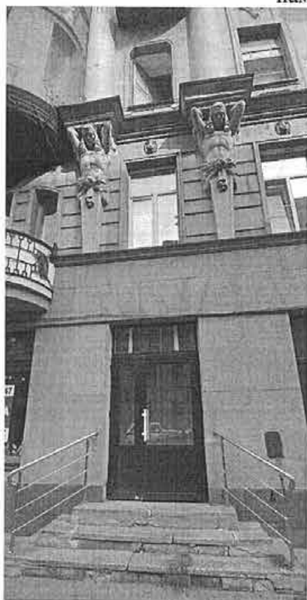
5. Фрагмент лицевого фасада. Дефекты правого современного крыльца.
