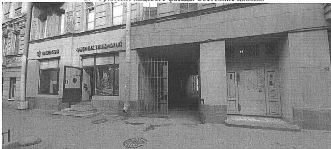
3. Фрагмент лицевого фасада. Зафиксировано провисание воротной створки, диссонирующая вывеска и неудовлетворительное состояние входной группы парадной и современного левого крыльца.
