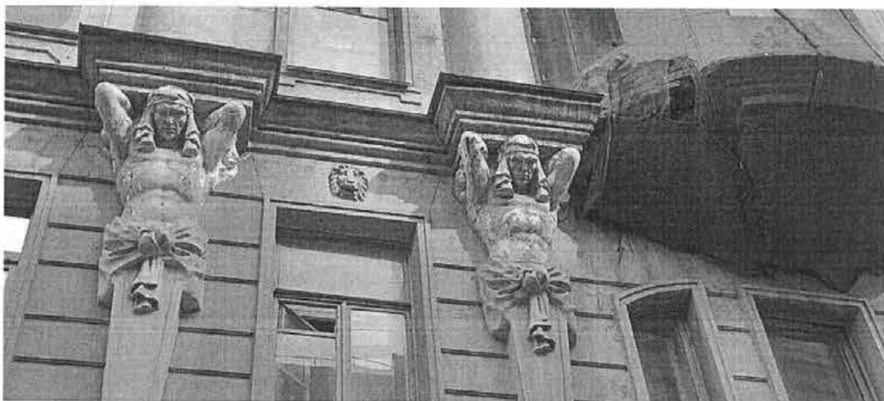
4. Фрагмент лицевого фасада. Деструкция и шелушение на фигурах, утраты и следы намockания центрального эркера
