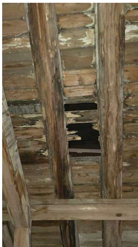
Фото 9. Следы замачивания, гниение деревянных балок перекрытия и настила.
