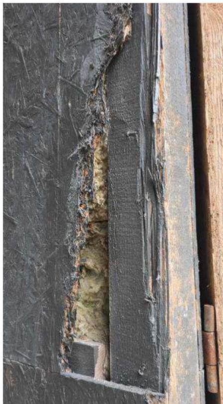
Фото 7. Повреждение щита закрытия проема фасадной стены.
