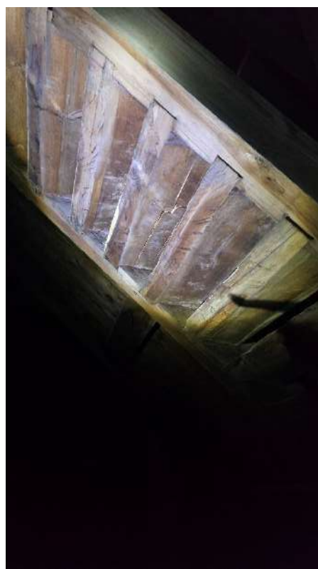
Фото 10. Трещина в ступени деревянной лестницы.
