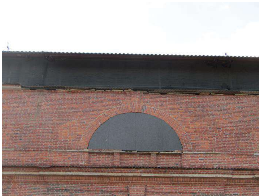
Фото 2. Разрушение и утрата карнизных плит, трещины, деструкция торцевых поверхностей; разрушение кирпичной кладки карнизов.
