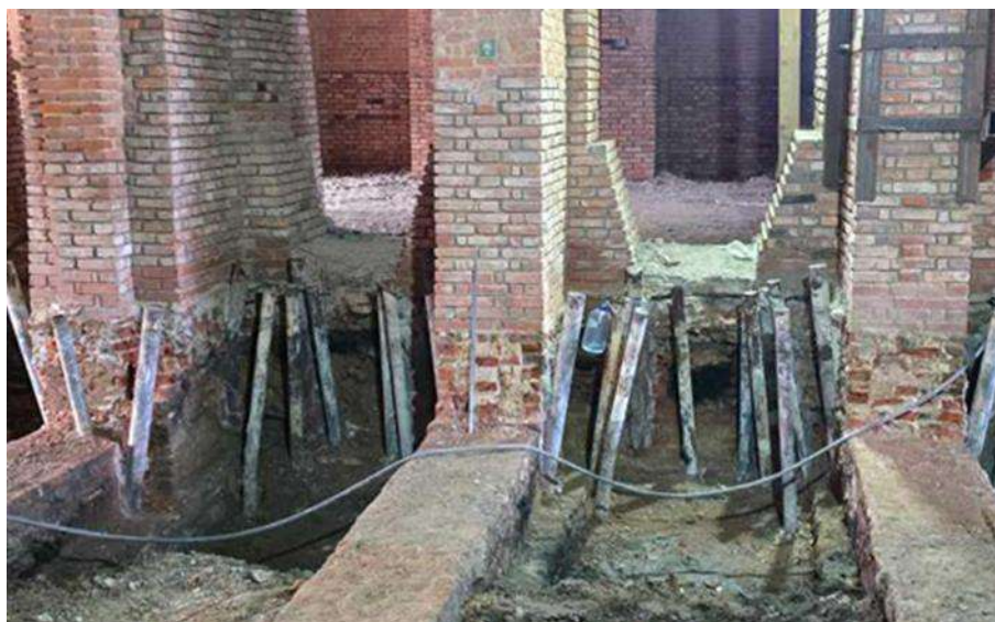
Фото 1. Следы замачивания, деструкция заглубленной части кладки стен.
