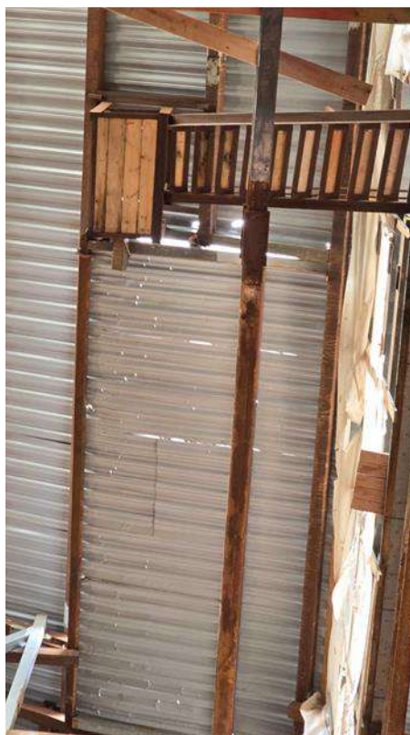
Фото 8. Сквозные отверстия, щели, нарушение целостности кровельного покрытия.
