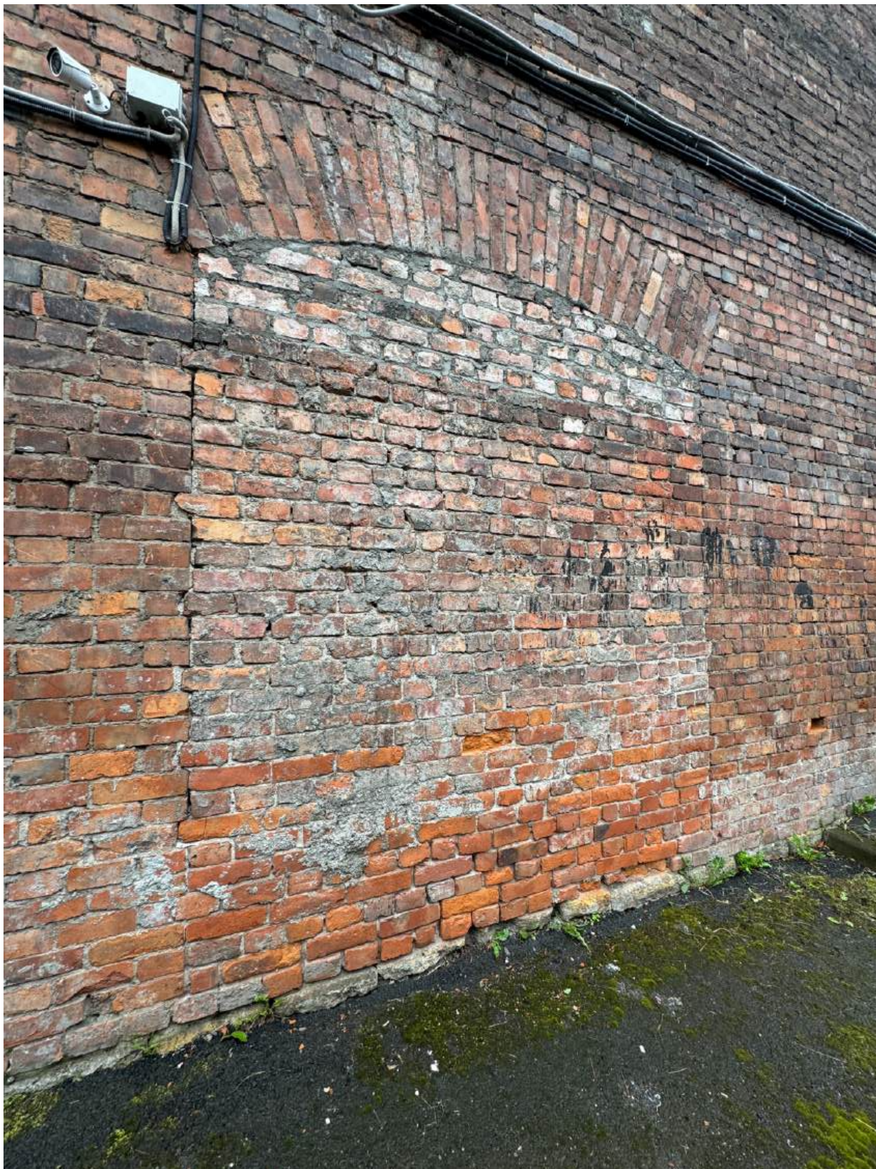
Фото 6. Заложенный воротный проезд в части брандмауэрной стены объекта культурного наследия с проезда от Бобруйской улицы.
