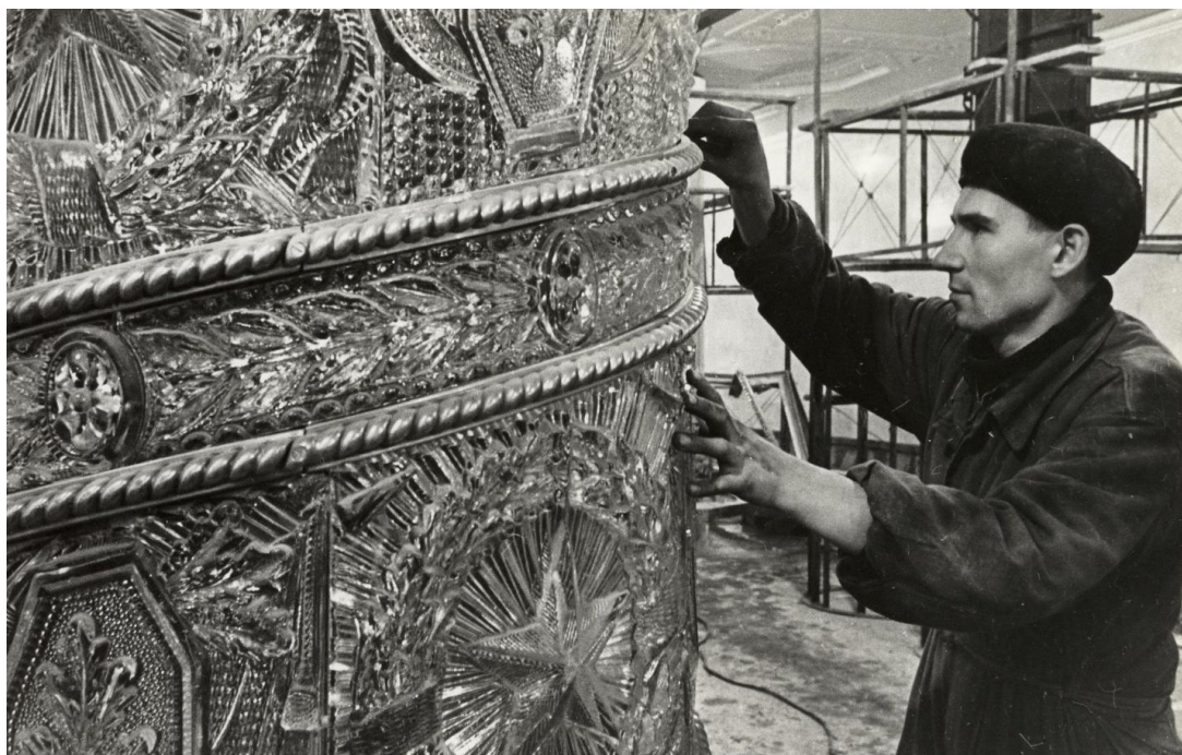
9. Станция метро Автово, отделочные работы. 1955 г. — «PastVu» – ретро-фотографии стран и городов [Электронный ресурс]. URL:
