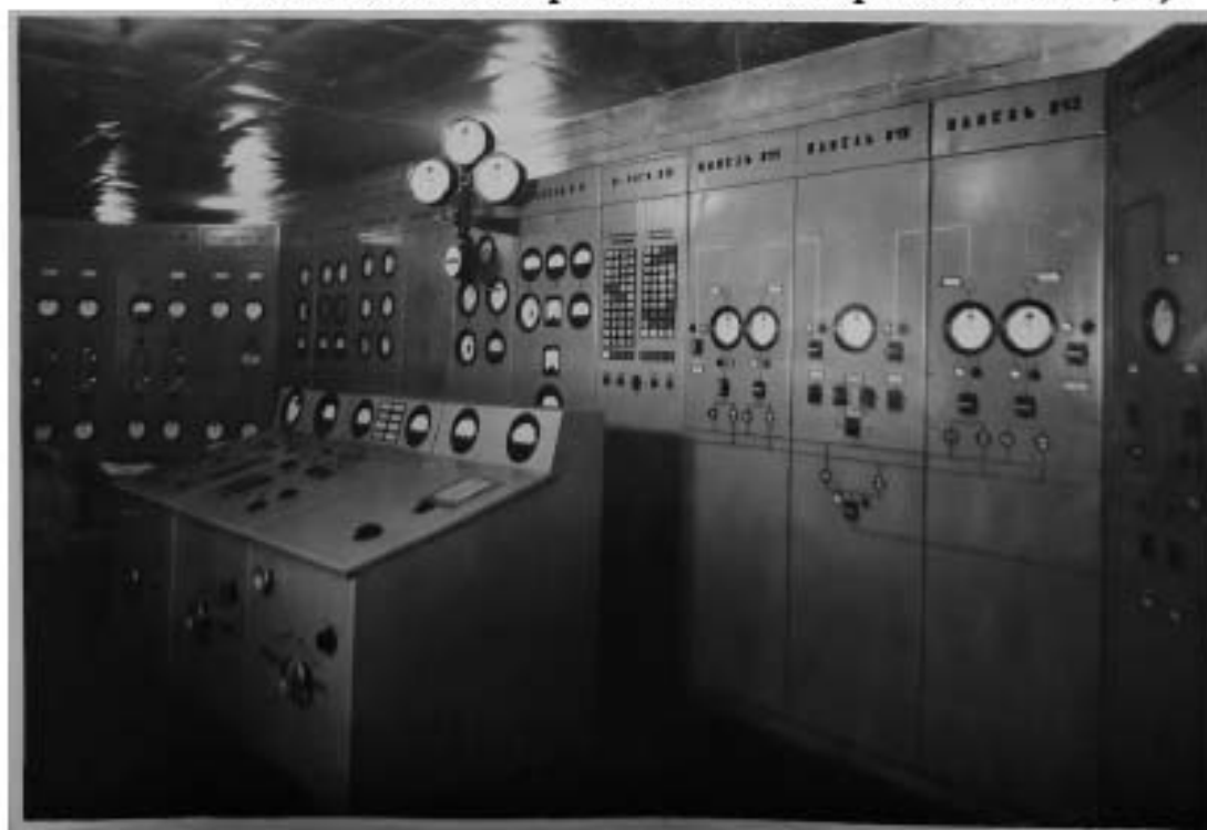
Илл. 110. Главный щит управления. 1954 г. (источник: архив ПАО «ТГК-1». Ф. 824. Технический паспорт тепловой электрической станции).
