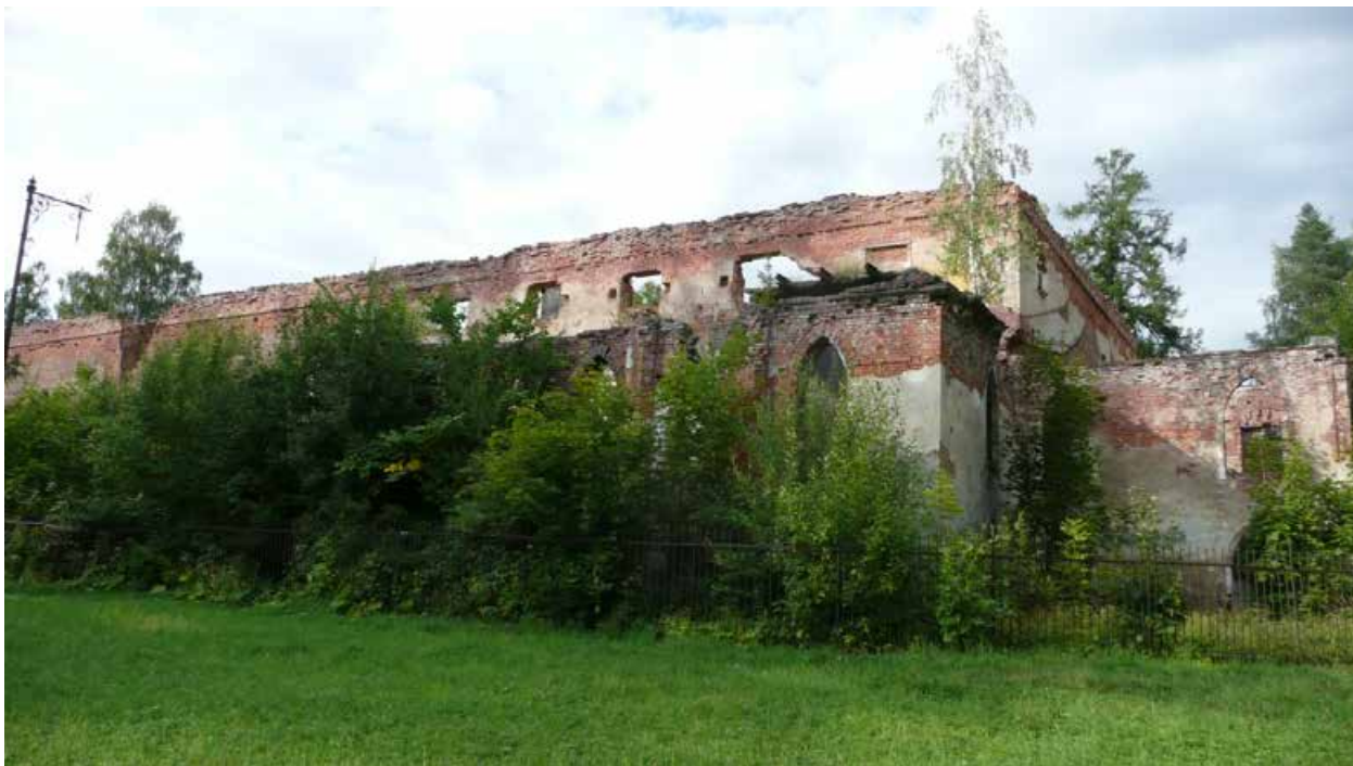
Фото 5. Вид на юго-западный фасад театра, здание руинировано, сохранились фрагменты стен (кирпичная кладка), у здания видна историческая опора фонаря, вокруг здания установлено временное защитное ограждение.
