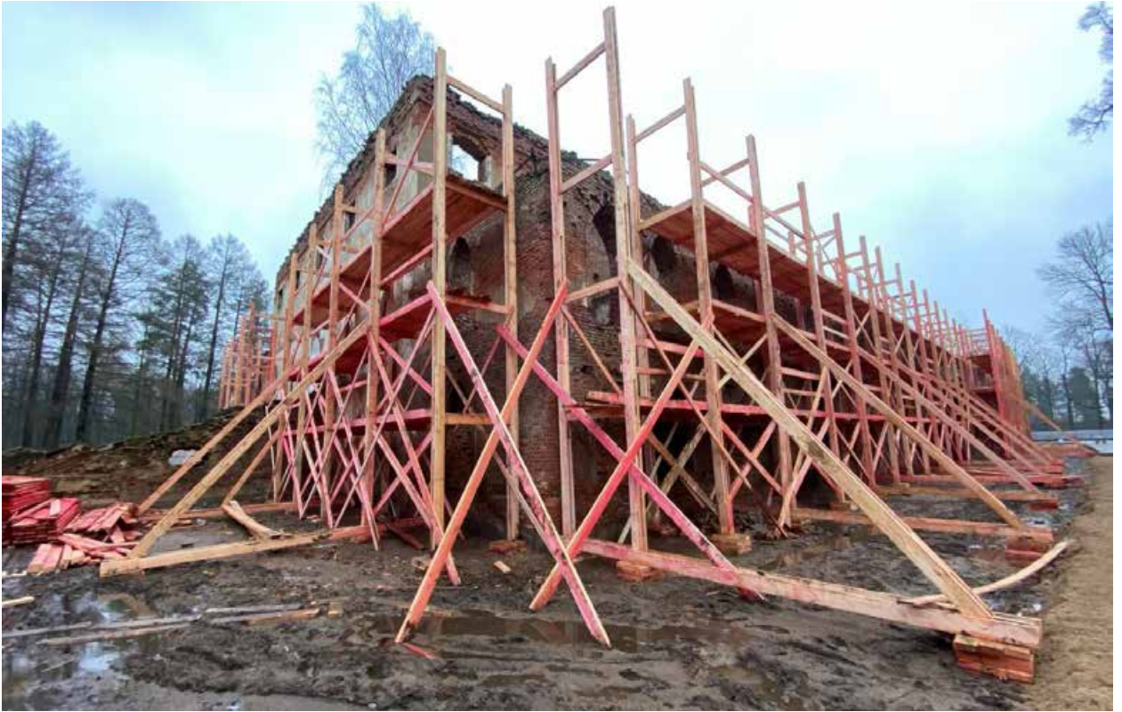
Фото 15. Вид на северо-западный и юго-западный фасад здания «Китайского театра» и прилегающую к нему территорию.
