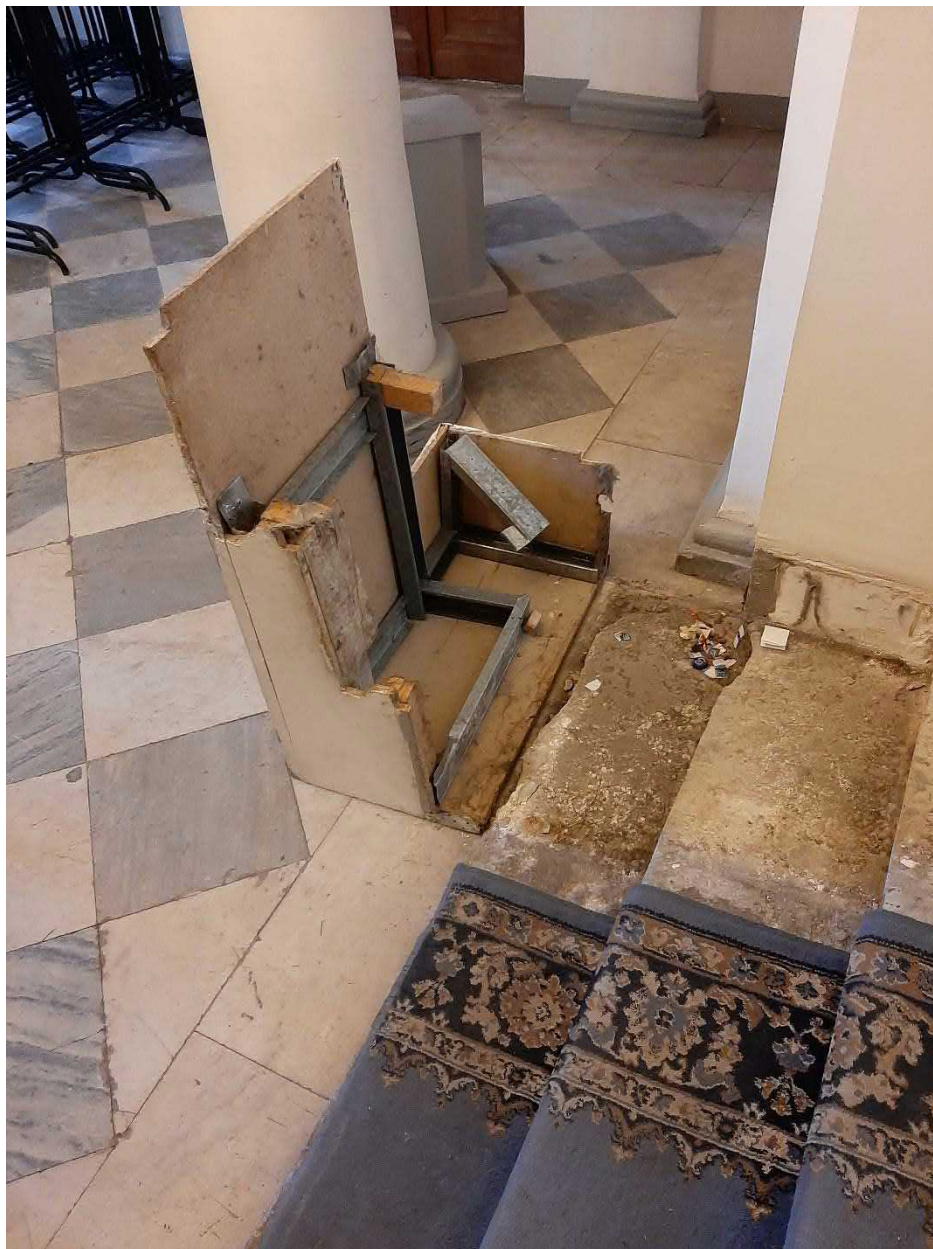
Фото 19. СПбГИК. Лестница. Короб, прикрывающий дефекты ступеней (открытый).
