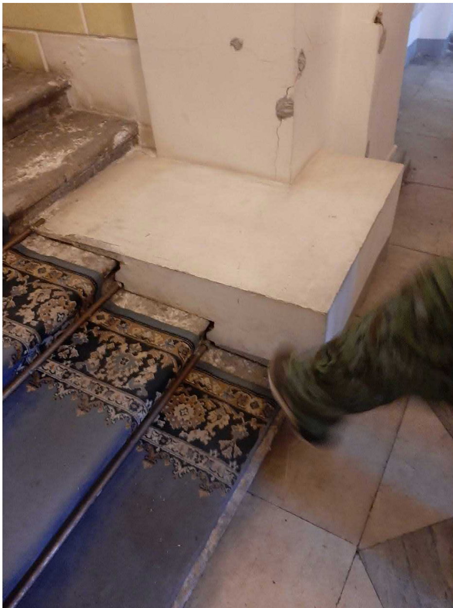
Фото 20. СПбГИК. Лестница. Короб, прикрывающий дефекты ступеней (закрытый).
