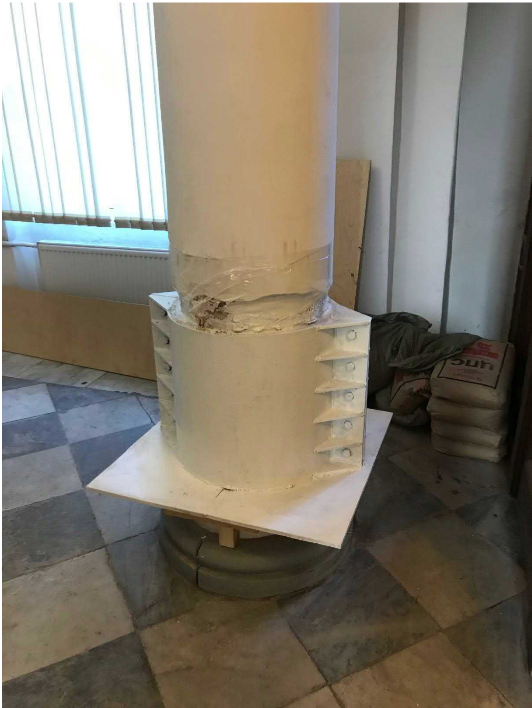
Фото 21. СПбГИК. Входной вестибюль. Деформация колонн.
