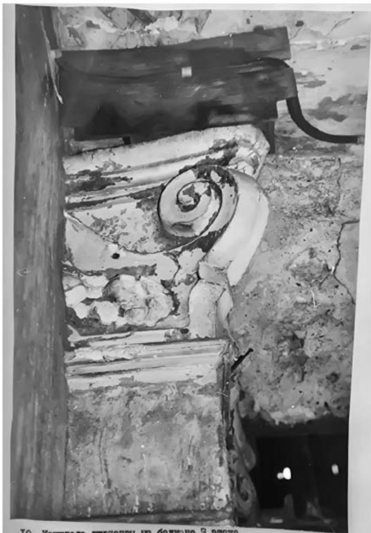
ГО. Котловый пилонный на балконе 3 этажа.
