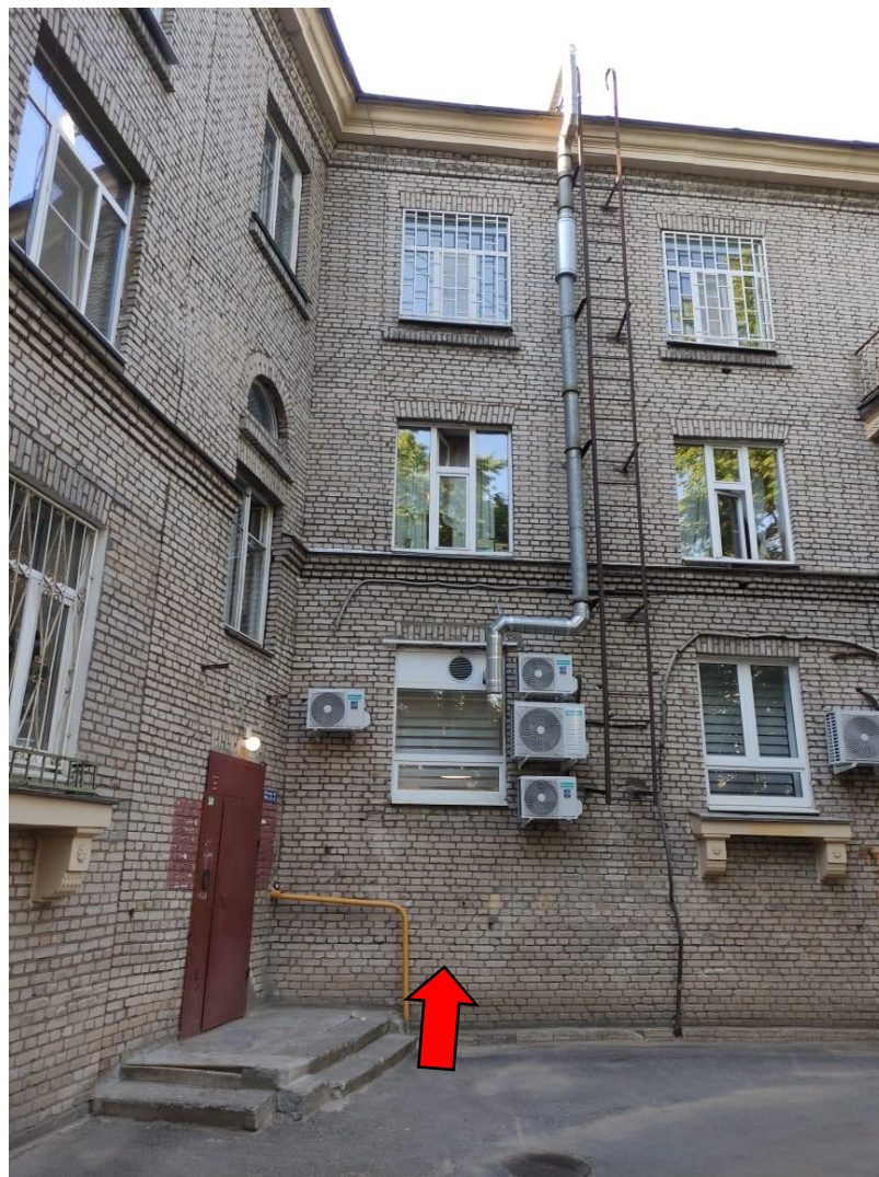
Рис. 2. Вид на Объект – крупный план, (место будущей двери отмечено стрелкой) с дворовой территории. Фото от 01.07.2021 г.
