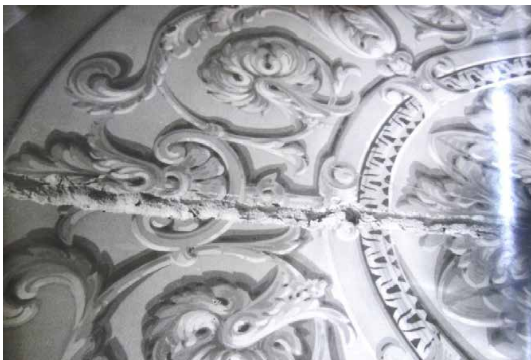
22. Таврический дворец. Комната № 12 по плану 1955 г. Фрагмент плафона до реставрации (пробит шурф для скрытой проводки). 1.10.1962 г. // Архив КГИОП СПб. Фототека. Инв. № 70409.
