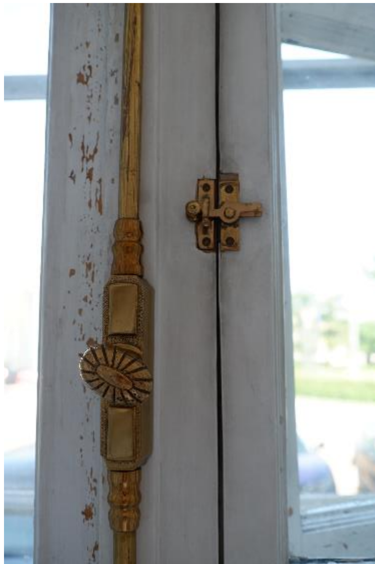
10. Оконная фурнитура помещения № 11 по плану ПИБ 2012 г. объекта культурного наследия федерального значения «Дворец Таврический. Дворец», расположенного по адресу: г. Санкт-Петербург, ул. Шпалерная, д. 47, лит. А. 15.10.2021
