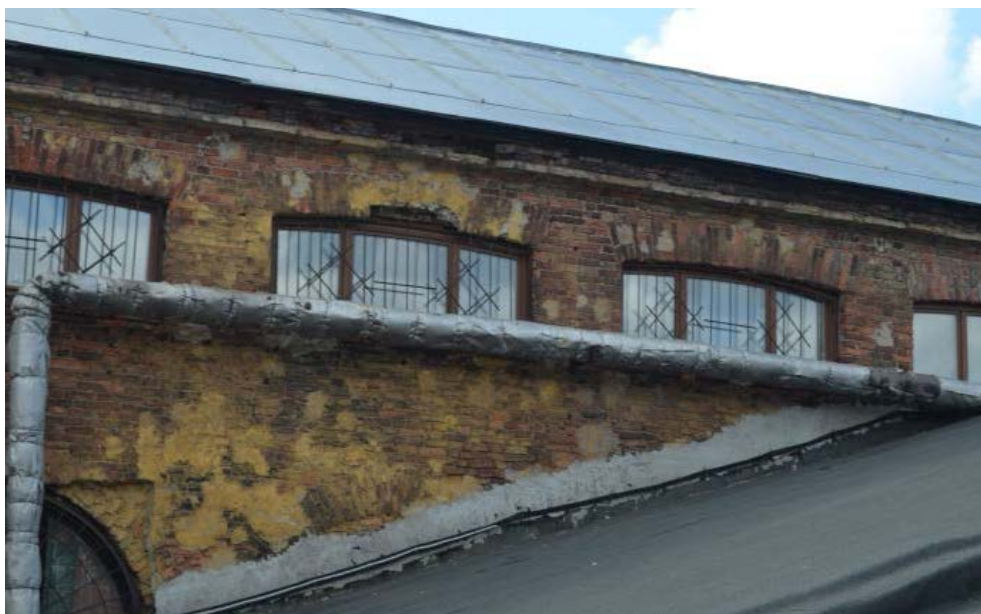
Фото 10. Дворовой фасад. Примыкание крыши соседнего строения. 22.08.2025
