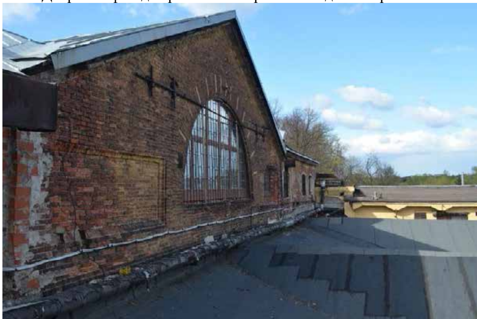
Фото 11. Дворовой фасад. Примыкание крыши соседнего строения. 22.08.2025
