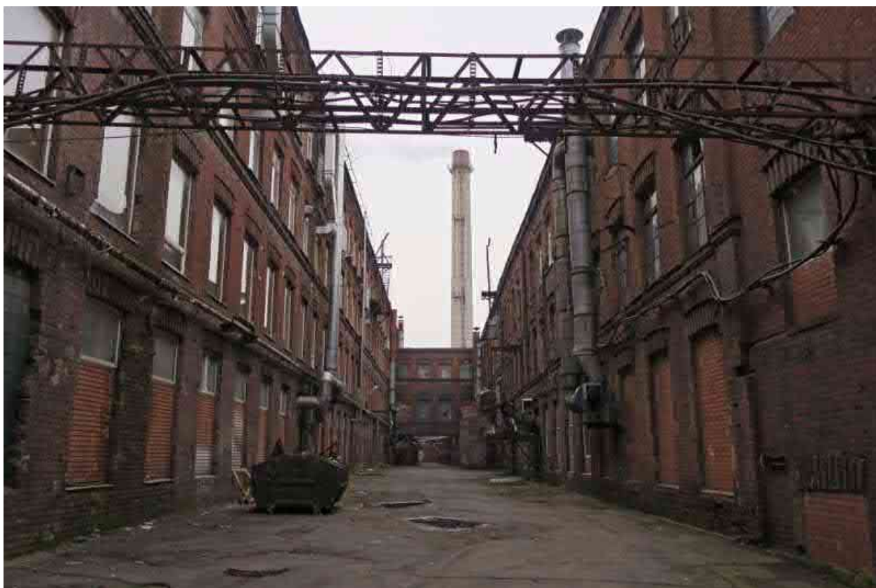
Илл. 47. Разрушенное состояние корпусов в 2020-е годы. Переход-галерея корпуса 5. https://fishki.net/4453304-cto-sluchilosy-s-legendarnym-krasnym-treugolynikom-i-pochem.html
