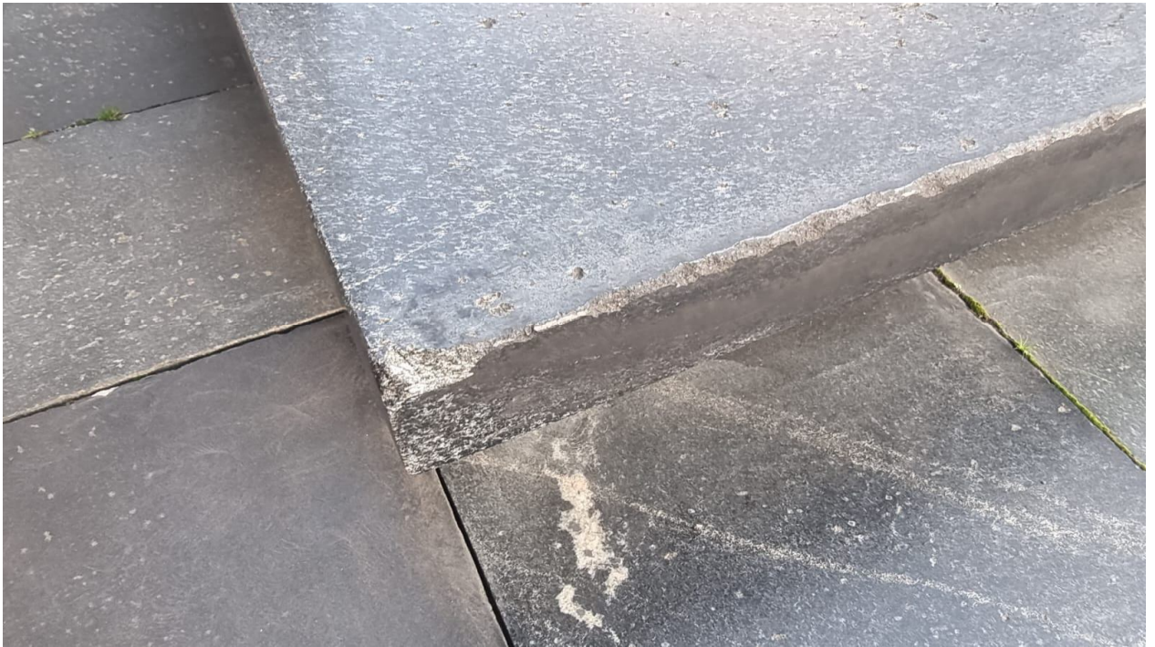
Фото 10. Дефекты полированной поверхности
