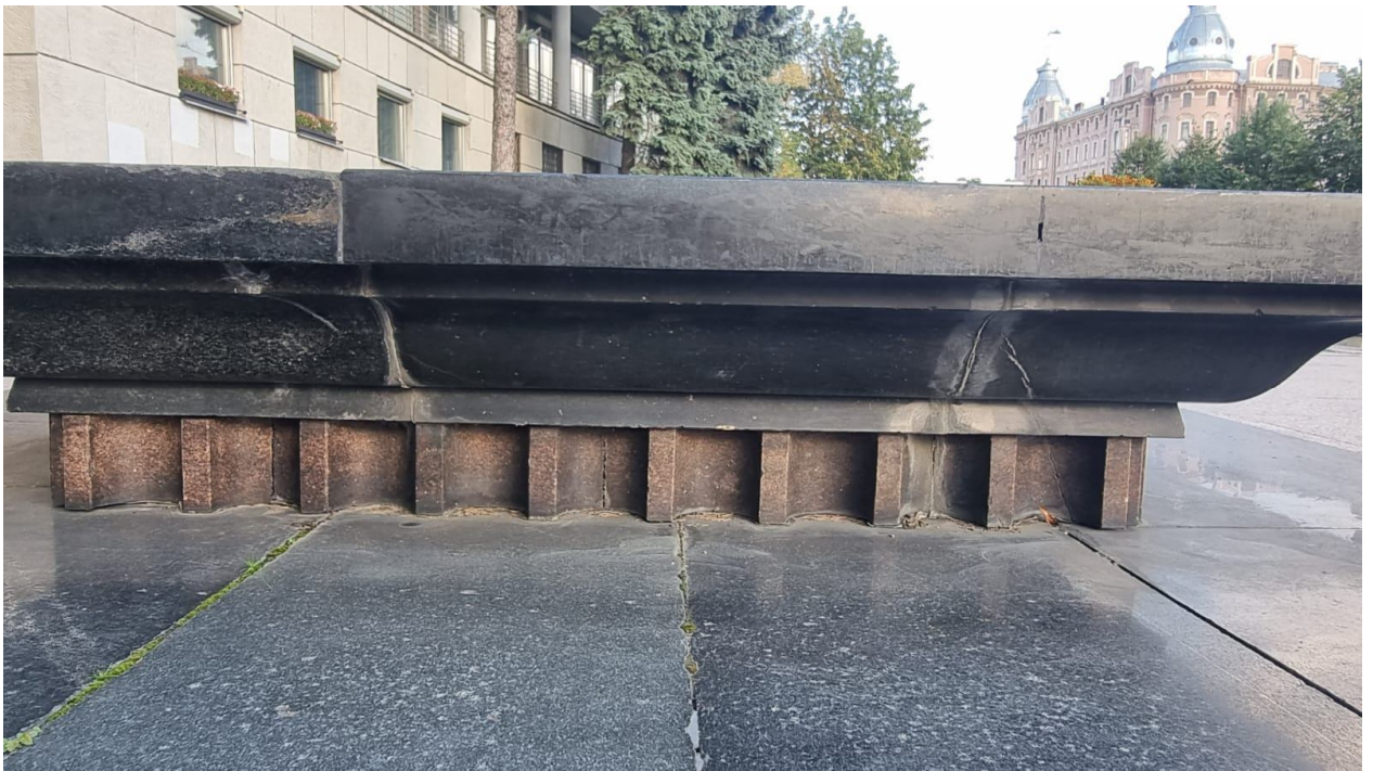
Фото 8. Дефекты полированной поверхности
