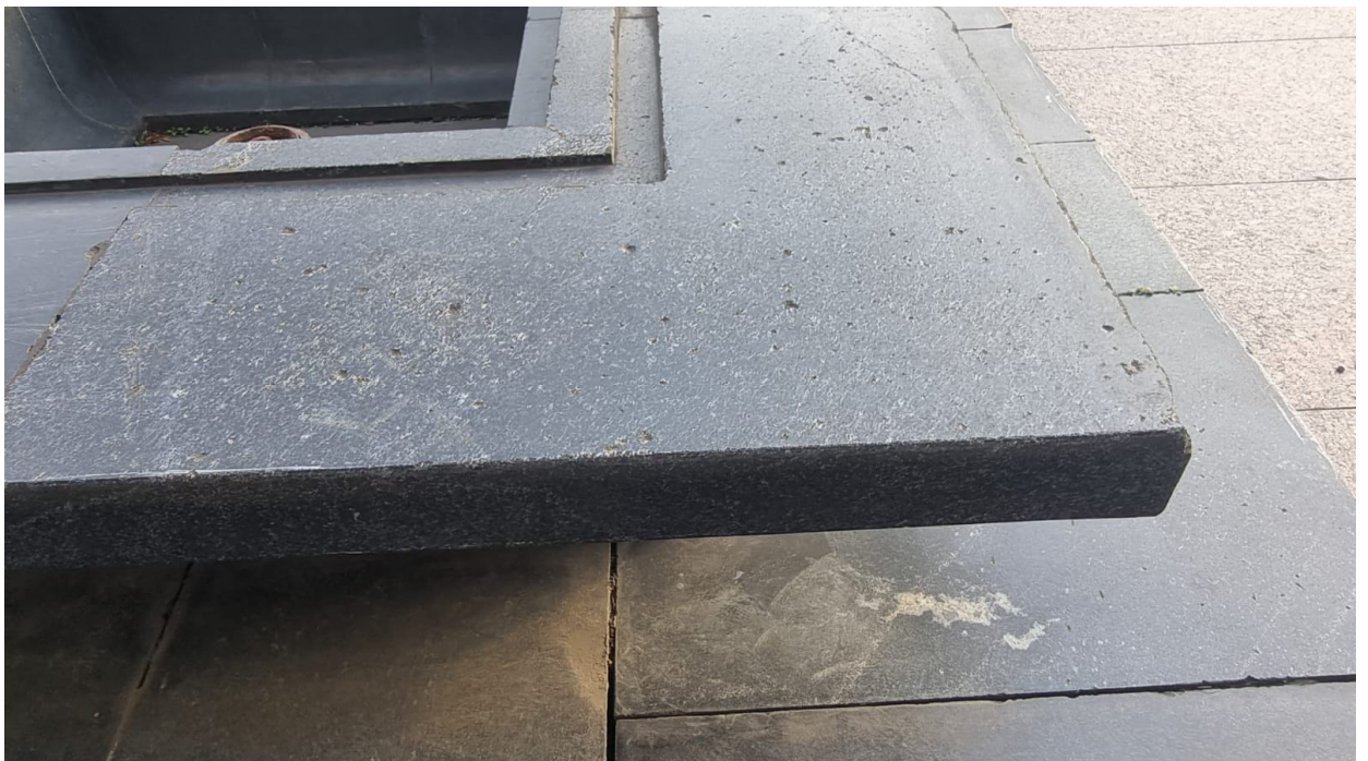
Фото 9. Дефекты полированной поверхности
