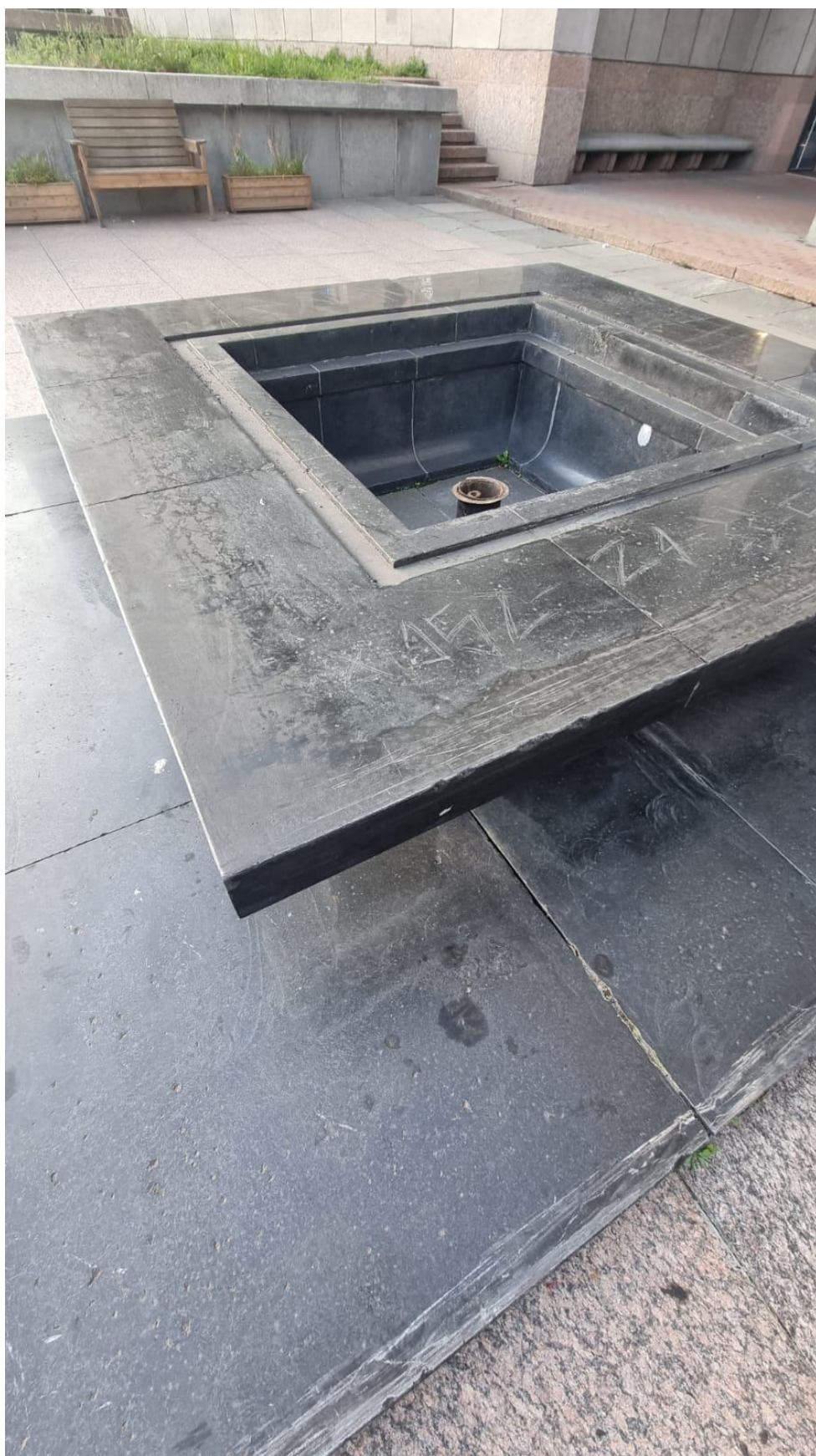
Фото 7. Дефекты полированной поверхности
