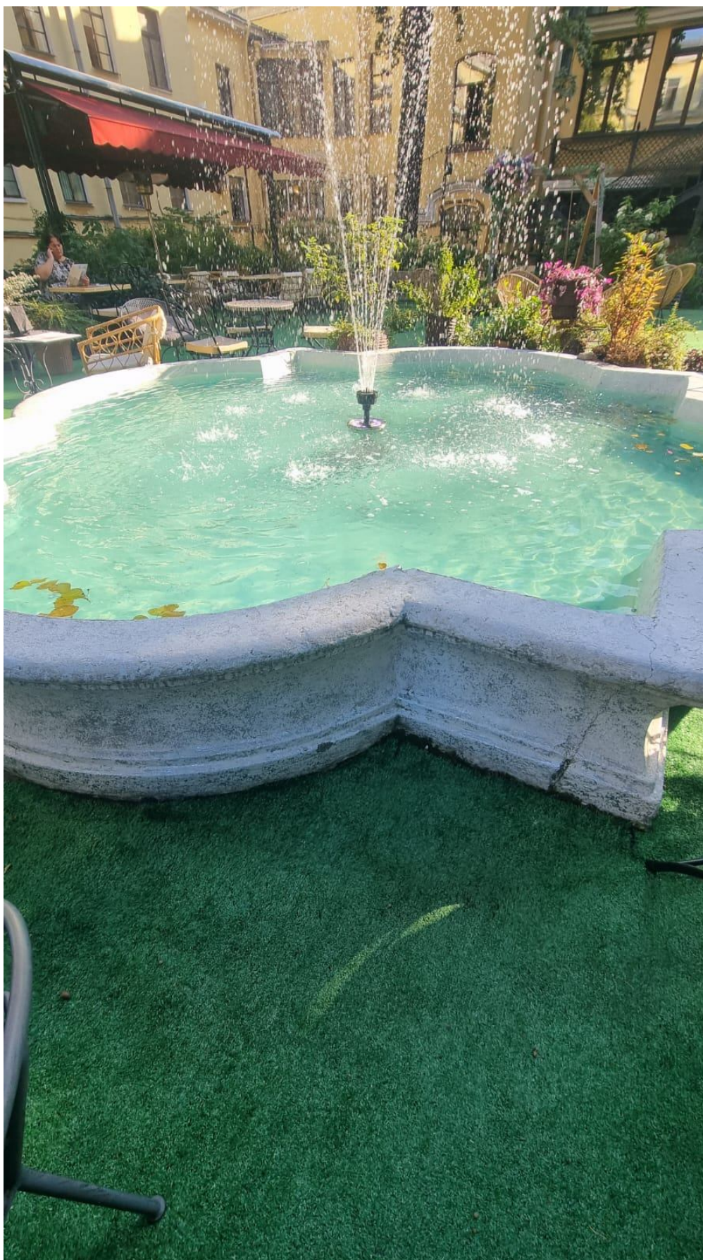
Фото 7. Дефекты чаши фонтана
