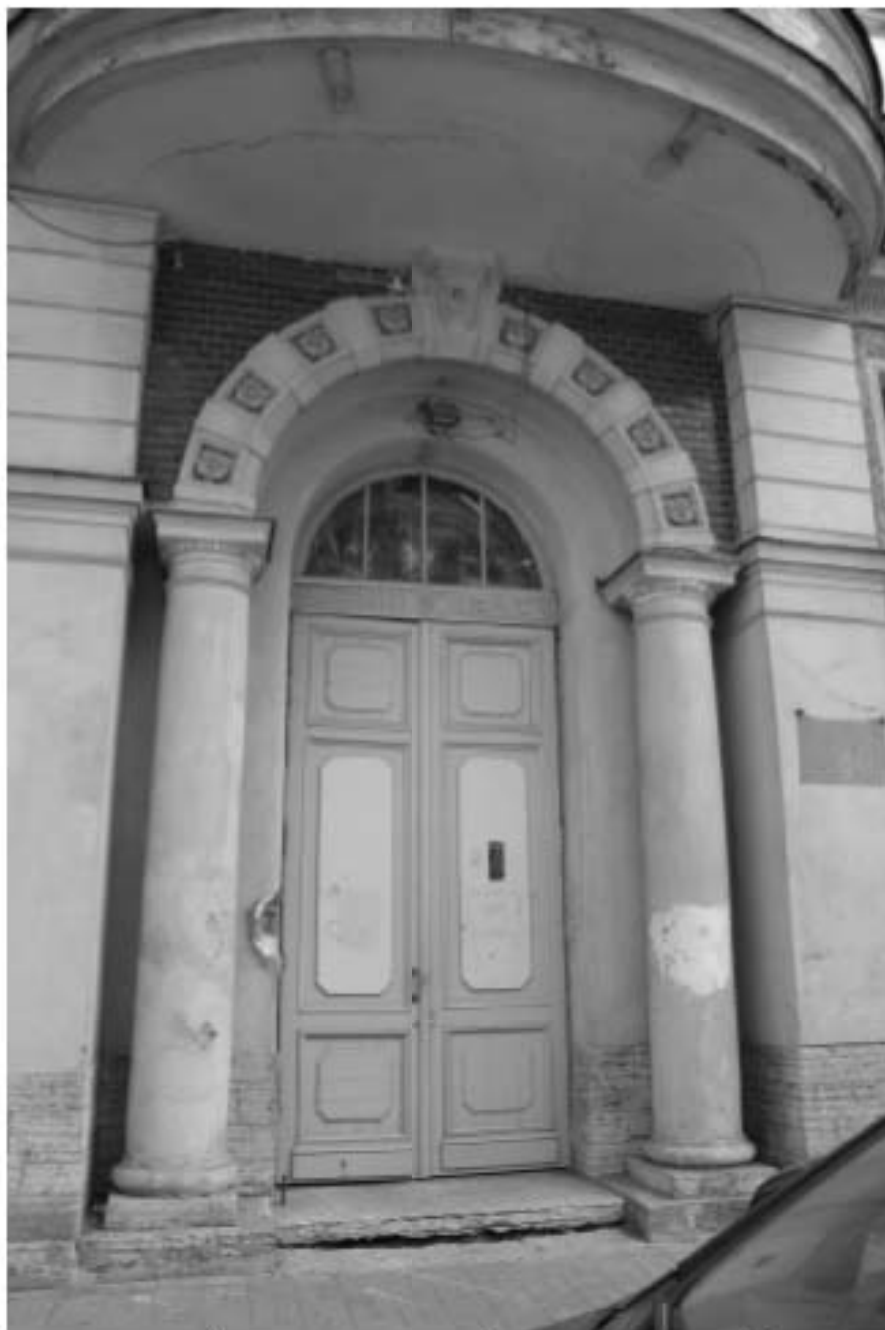
9. Фрагмент центральной части главного фасада по улице Таврическая. Портал парадного входа. Вид с запада
