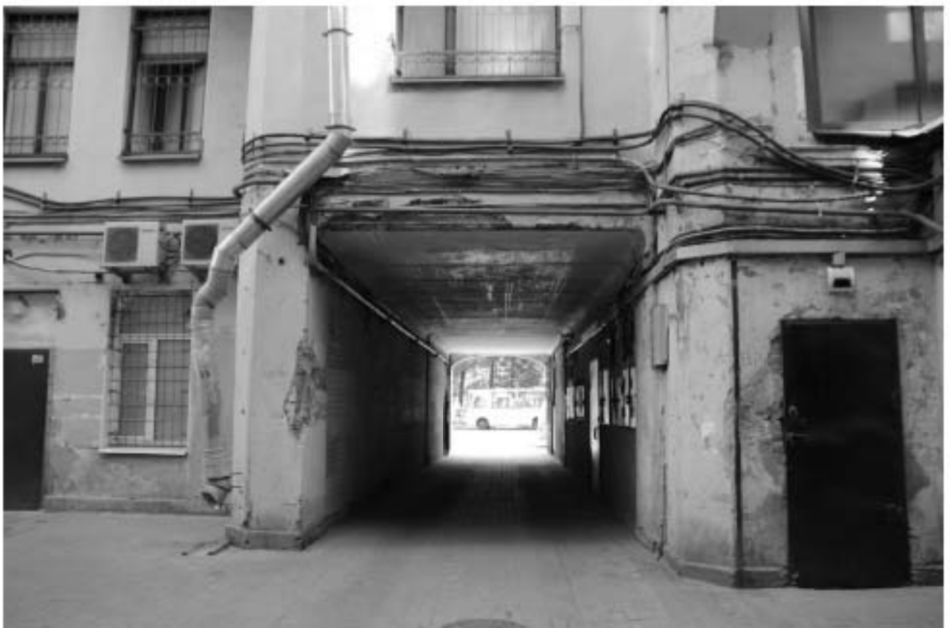
12. Проездная арка, вид с внутреннего двора в сторону Суворовского проспекта. Вид с северо-запада
