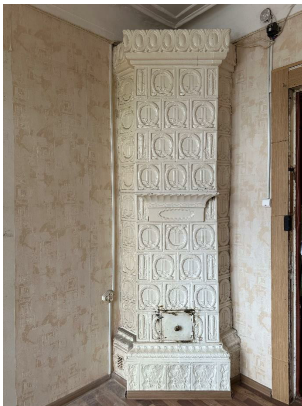
Фото 24. Печь в комнате (пом.2)
