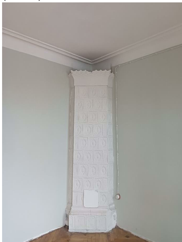
Фото 25. Печь в комнате (пом.3)
