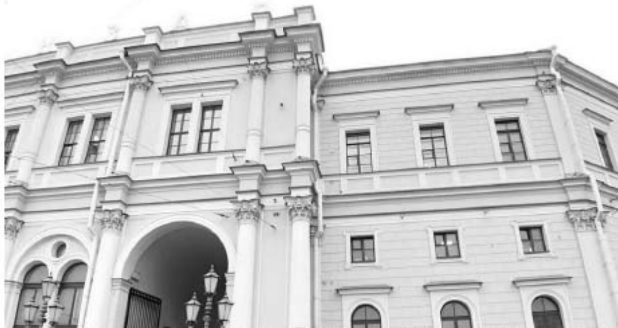
21. «Вокзал Николаевский (Московский)» (Невский пр., д. 85, лит. А). Лицевой фасад. Фото мест установки оборудования и прокладки кабельных трасс. Штиглиц М.С. 10.11.2025 г.
