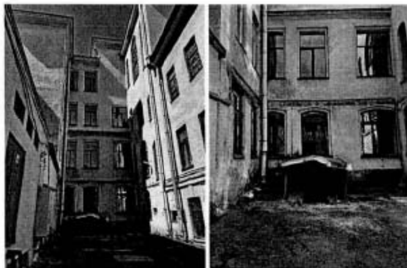
Фото 10, 11. Дворовой (восточный) фасад корпуса по Соляному переулку по южной границе объекта культурного наследия и примок.
